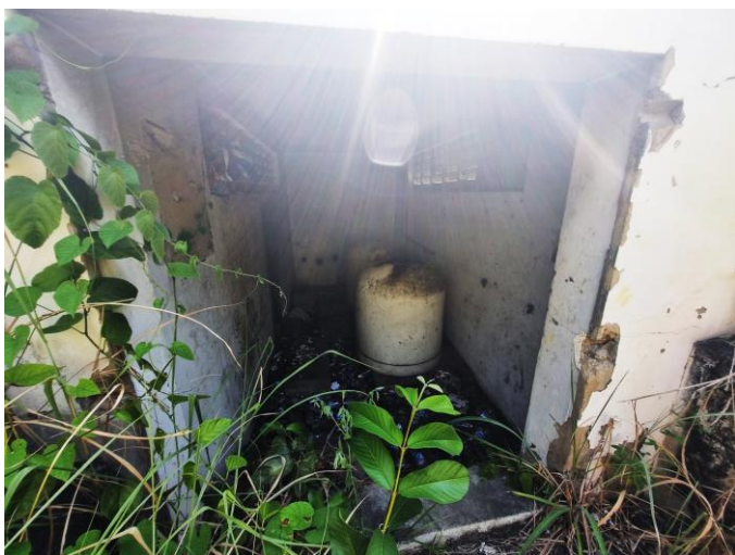
15 – Casa da bomba da piscina
