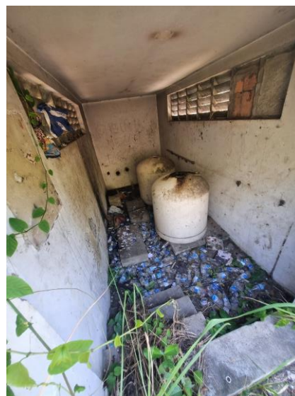
16 – Casa da bomba da piscina
