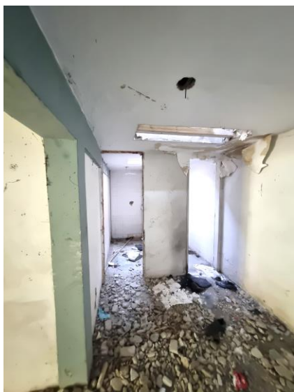
31 – Banheiros localizados na esquerda do área da FOTO 29
