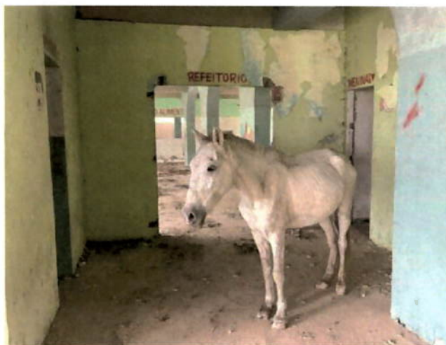
Vista da circulação com pintura e reboco desprendidos nas paredes e presença de animais, indicando estado de abandono.
