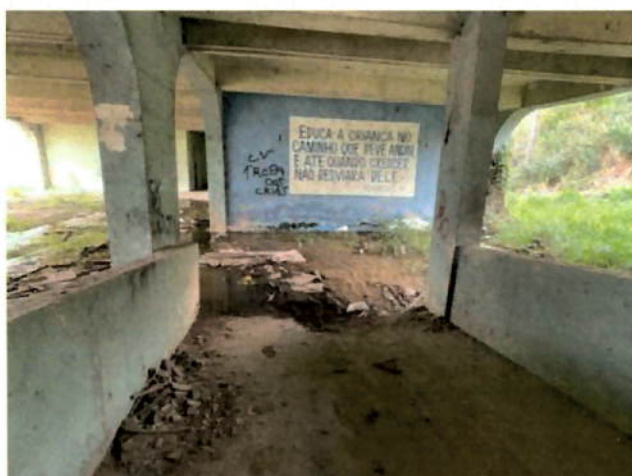
Vista do pátio coberto da edificação principal, indicando a degradação do local.
