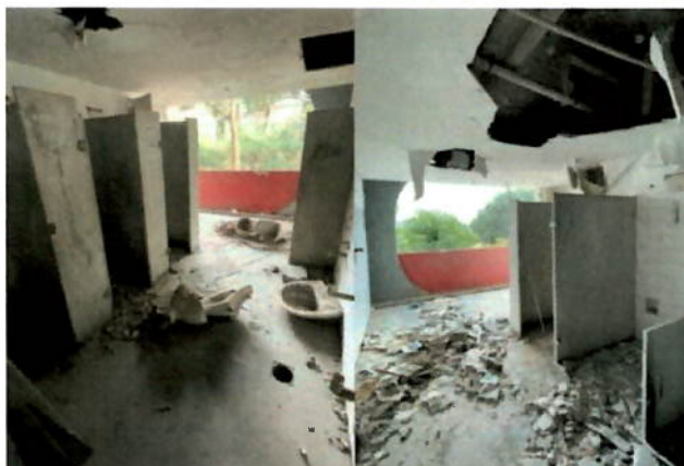
Vista do banheiro, indicando que o local foi depredado com sinais de vandalismo.
