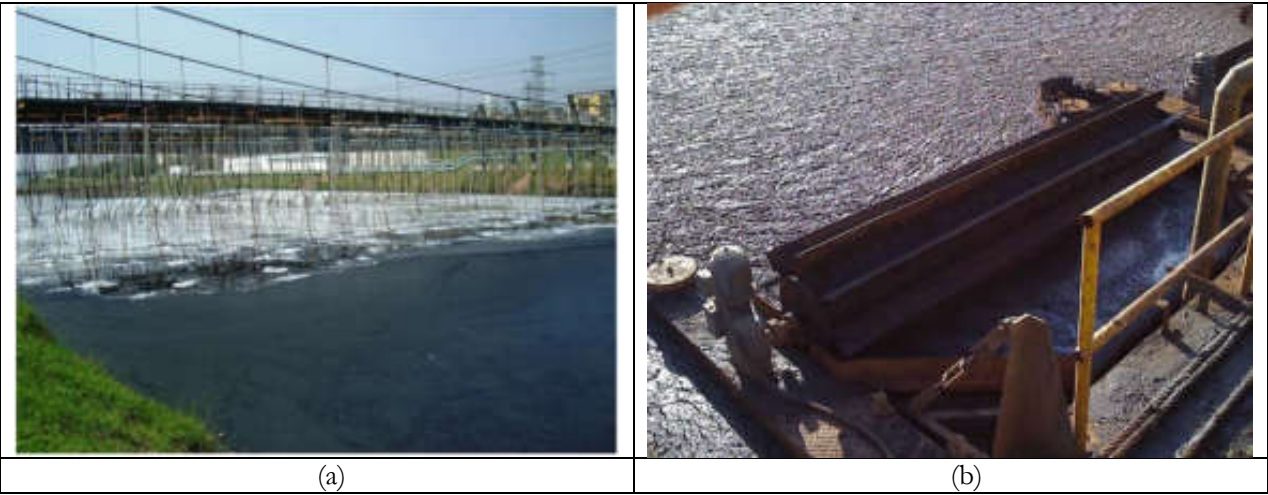
Figura 68: Etapa de flotação da água floculada. caracterizada pela (a) Injeção de ar dissolvido. e (b) Remoção do lodo flotado. Fonte: FCTH
