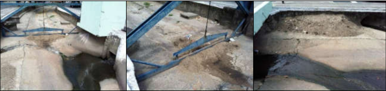
Figura 19: Estrutura de CTS localizada no canal Ari Parreiras – Águas de Niterói
