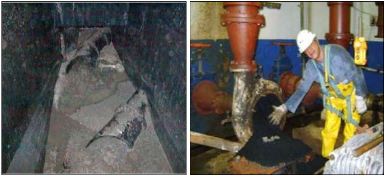
Figura 20: Acumulação de areia no poço de sucção e na voluta do equipamento de bombeamento
