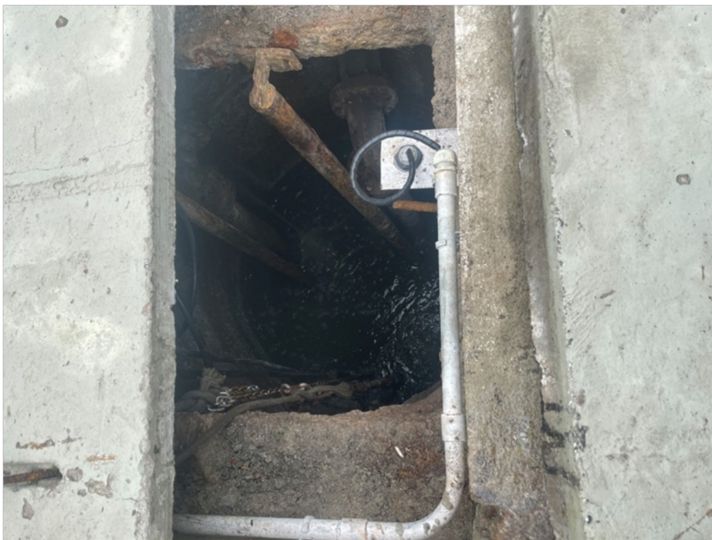
Foto 3 – Barrilete de recalque submerso
