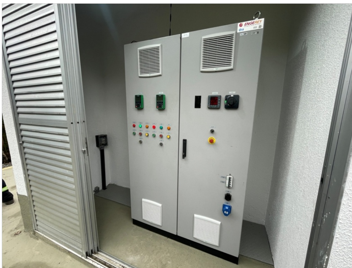
Foto 6 – PAINEL DE COMANDO
