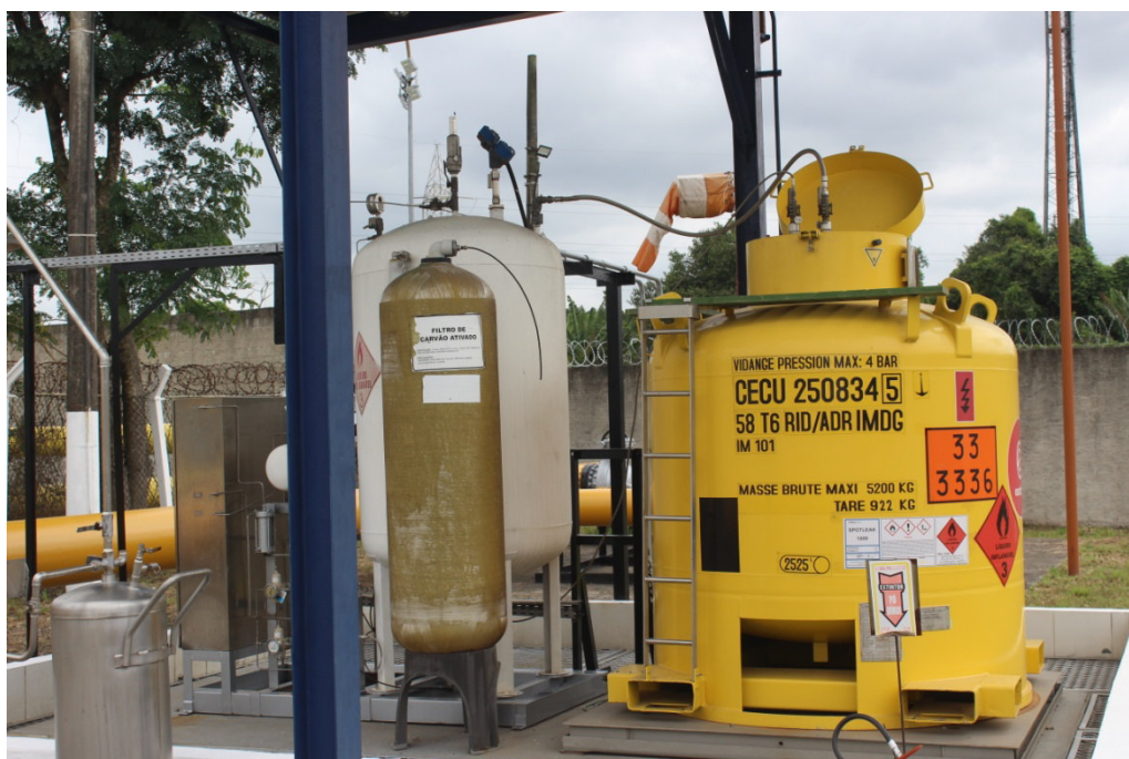
Foto 6: Estação de odorização da primeira linha
