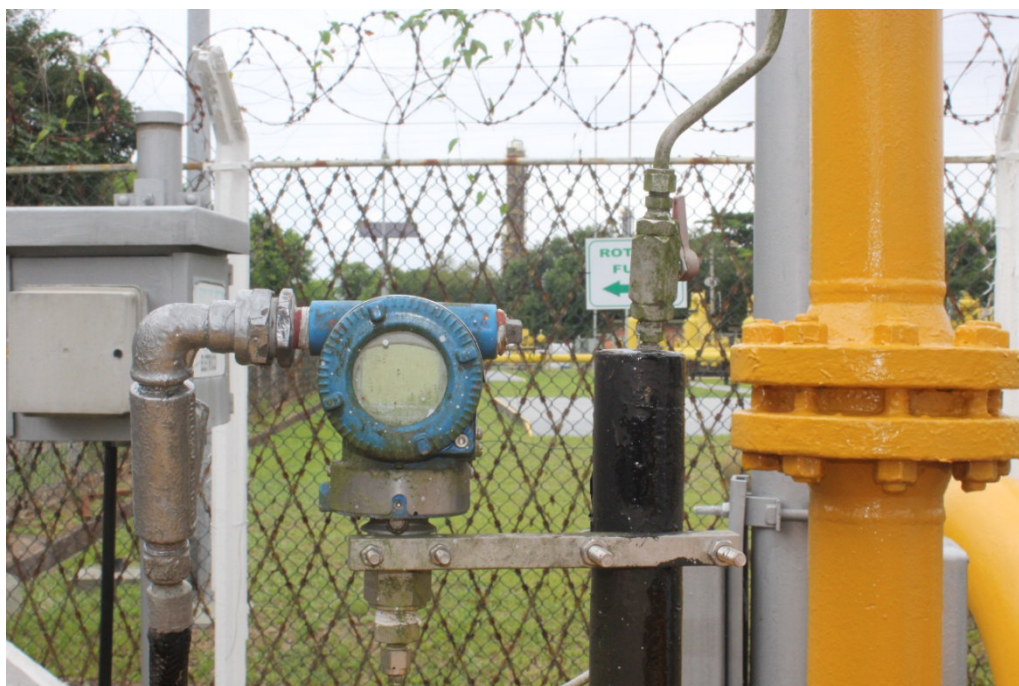
Foto 11: Medidor com display danificado.
