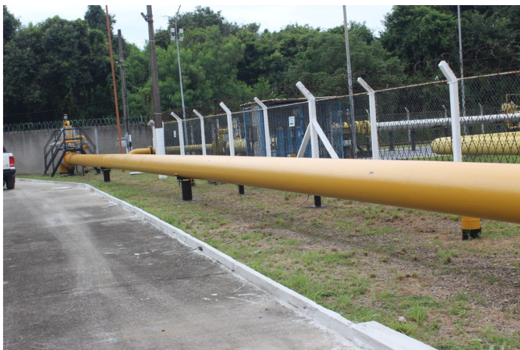
Foto 2: Tubulação da primeira linha.
