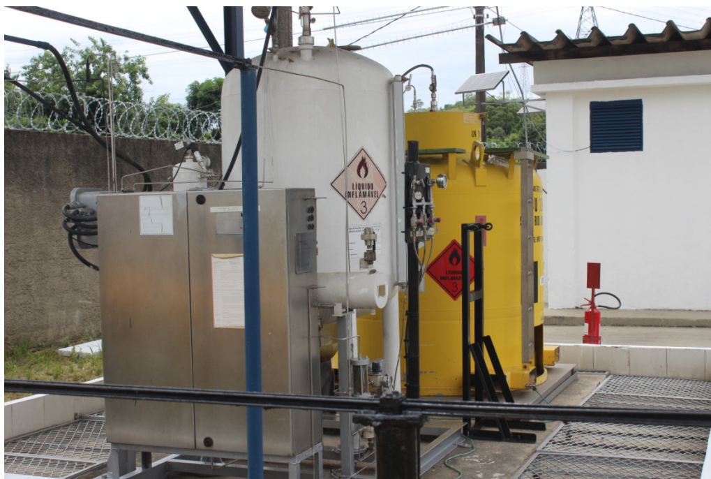
Foto 7: Estação de odorização da segunda linha.
