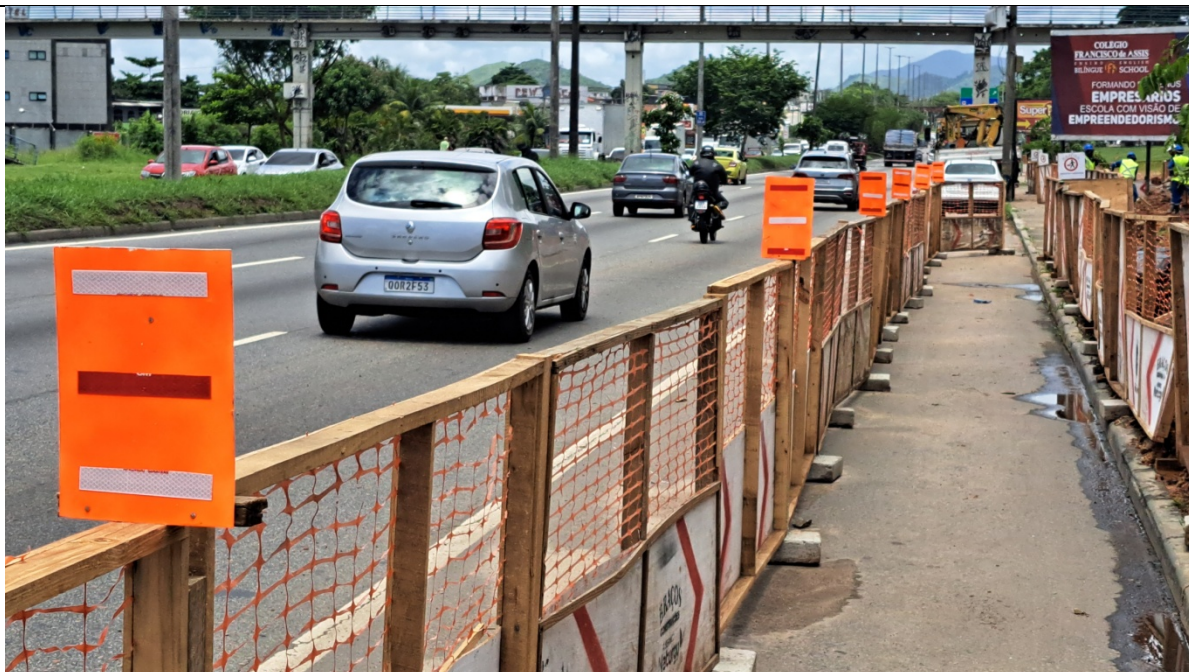
Foto 11: Sinalização Noturna – passagem de pedestres
