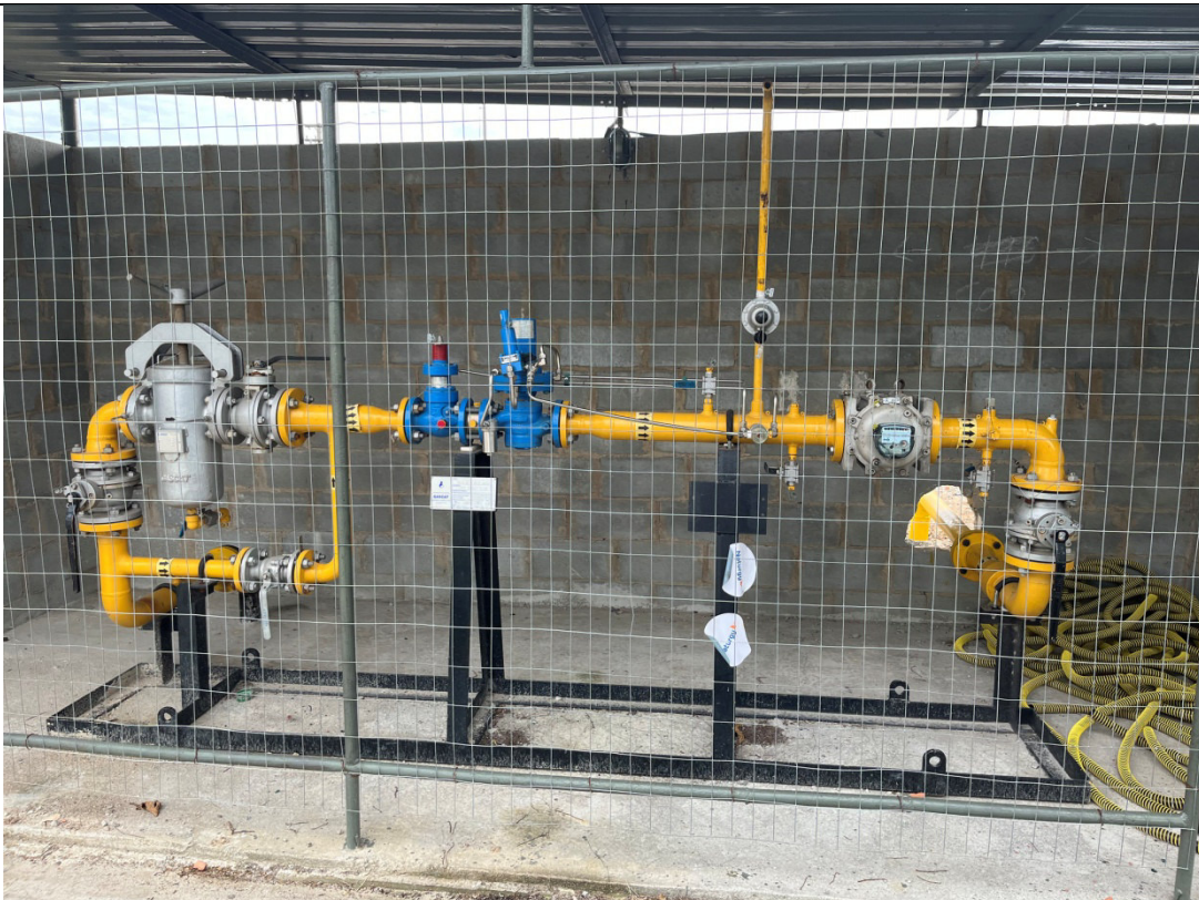
Foto 12: Estação de regulação e medição dentro da usina de asfalto.
