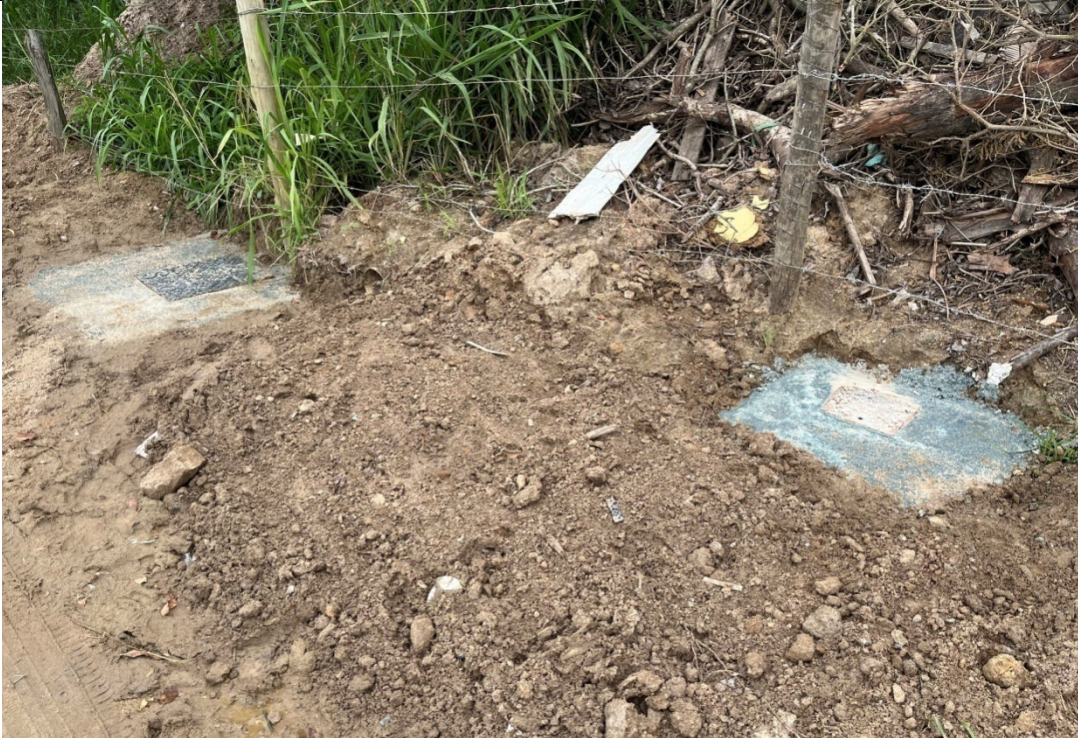
Foto 11: Caixa de válvula (à esquerda) e ramal que conecta a rede com a usina de asfalto (à direita).
