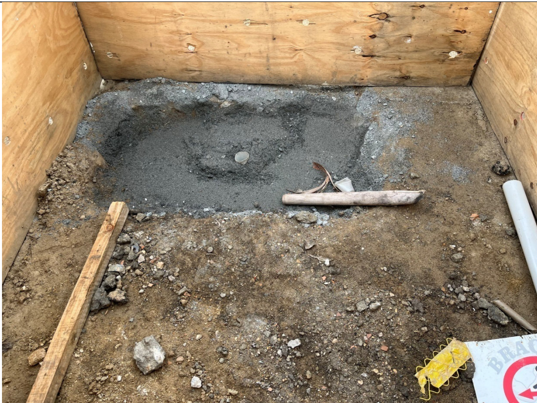
Foto 12: Ponto de interligação de rede com o Cond. Vila dos Ventos.
