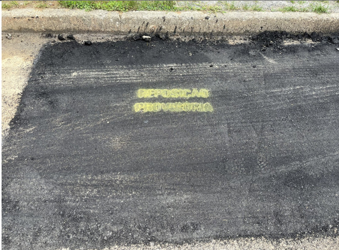
Foto 6: Trecho da via com recomposição provisória.
