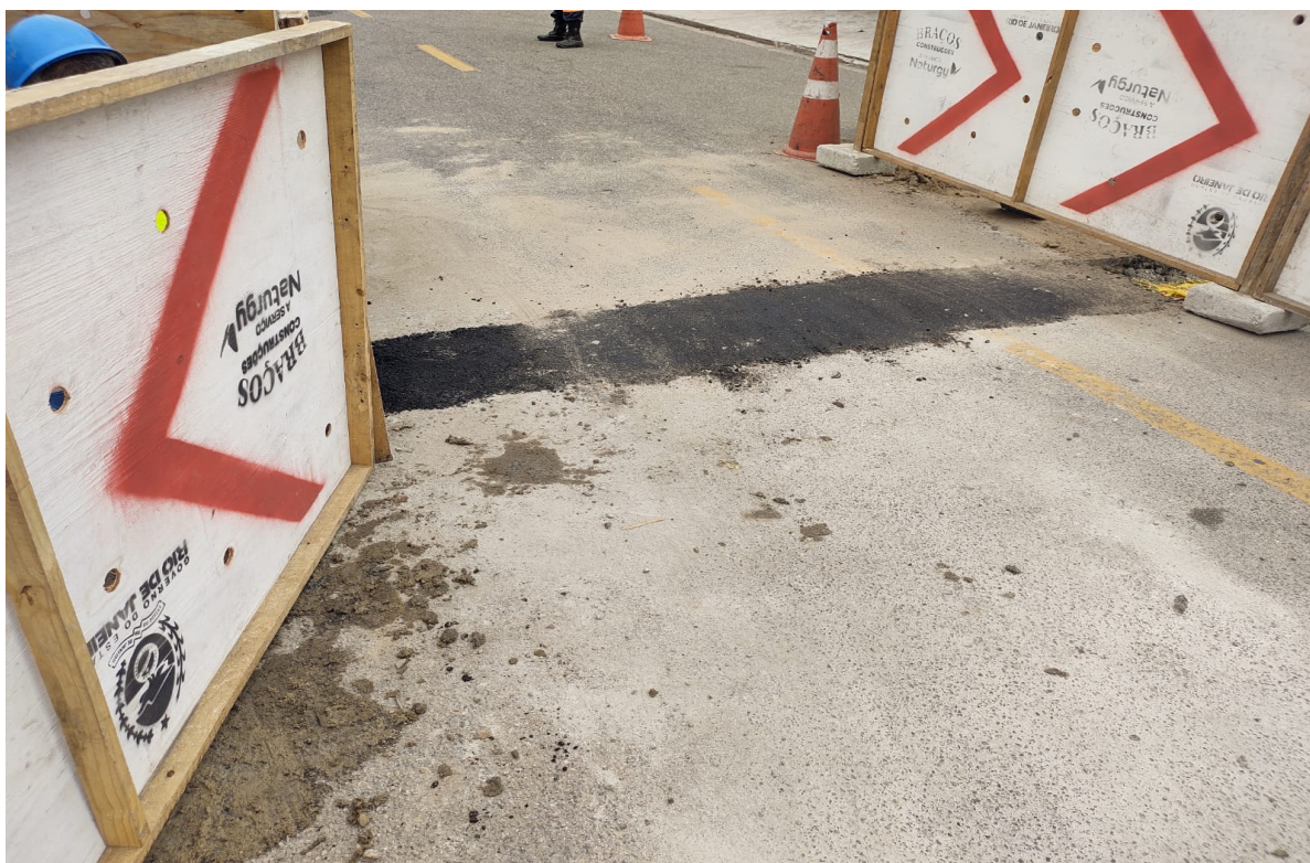
Foto 6: Recomposição provisória sem aviso.
