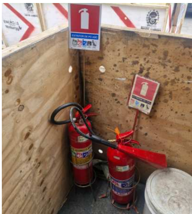
Foto 4: Extintores de Incêndio.
