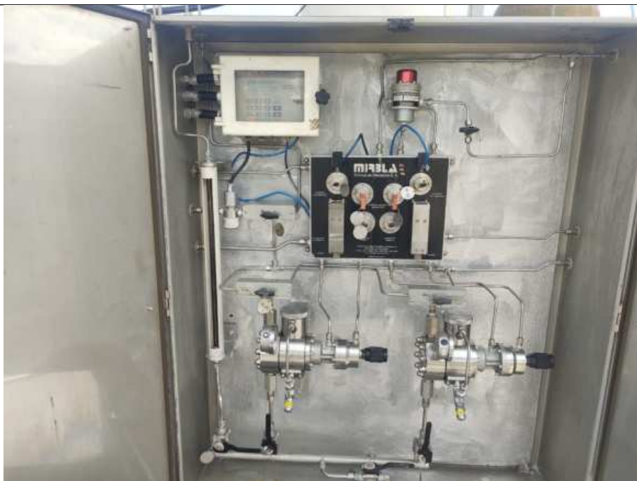
Foto 7 – Quadro de controle de injeção do odorizante (mecaptana)
