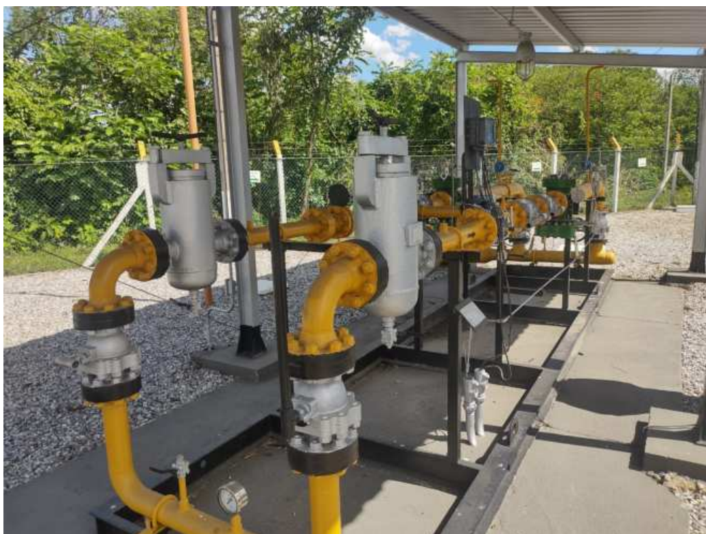
Foto 8: Skid da estação de regulação de pressão, medição de vazão e temperatura com linha duplicada.
