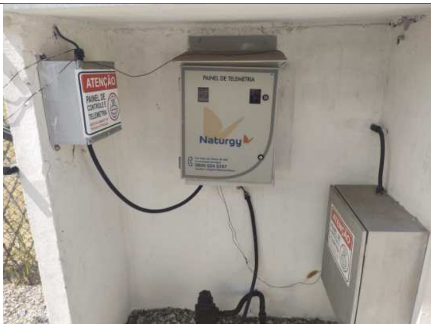
Foto 11: Painei de telemetria da estação
