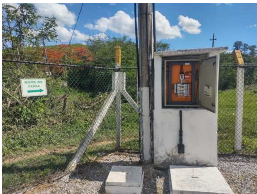
Foto 14: Paine de força da estação
