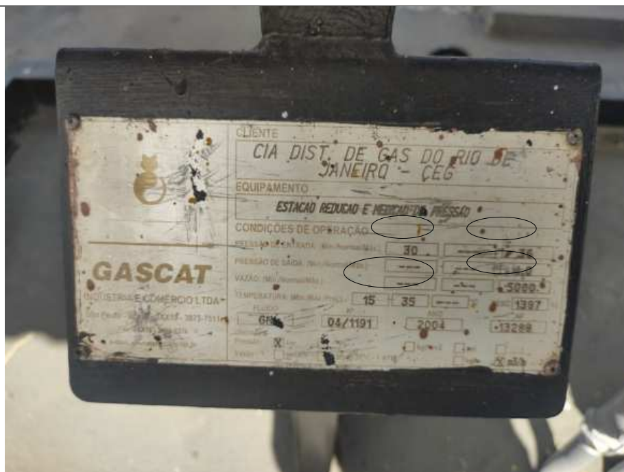
Foto 9: Placa do fabricante do skid com parâmetros de operação: pressão de entrada e saída, temperatura e vazão.
