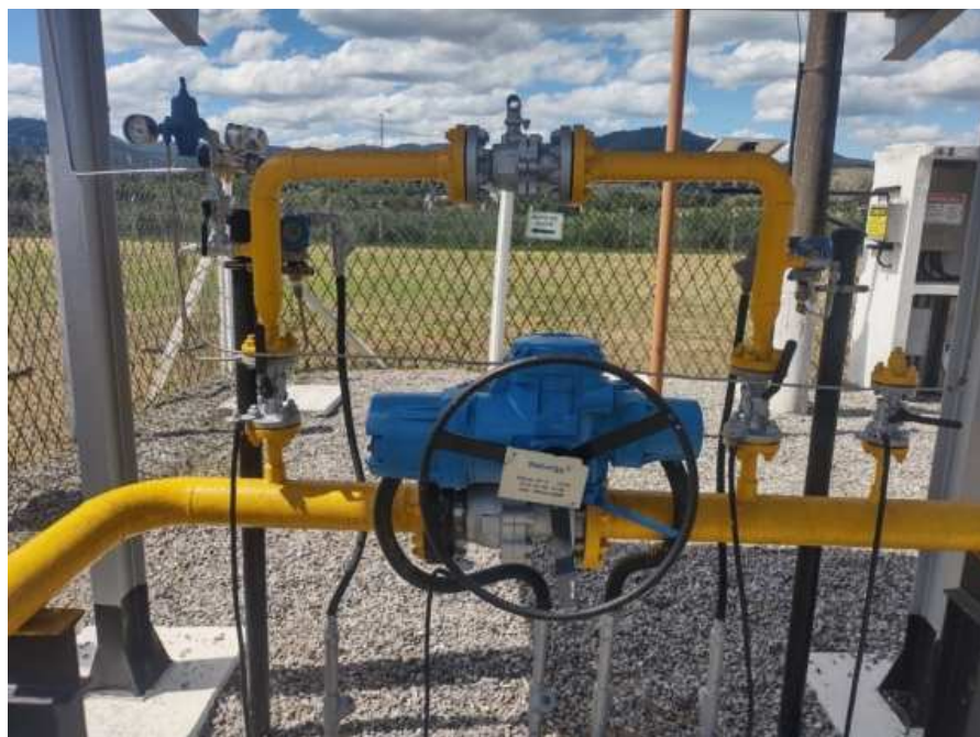
Foto 4: Válvula telecomandada na linha de entrada de gás.
