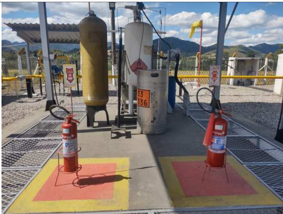
Foto 5: Estação de odorização
