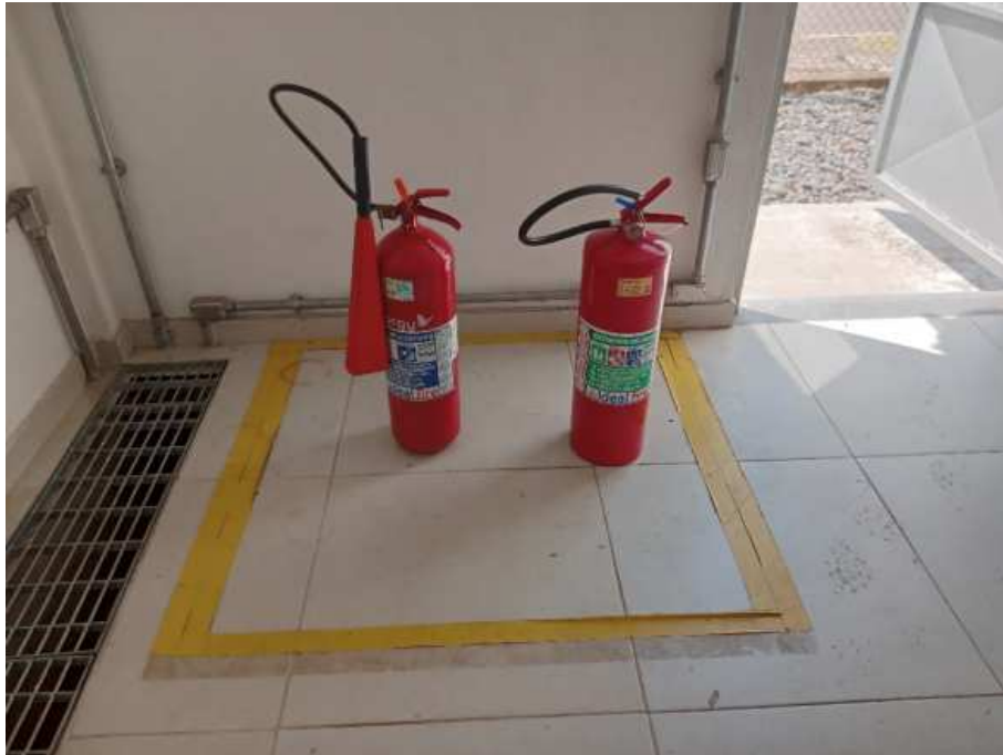
Foto 11: Extintores de incêndio sem suporte apropriado.
