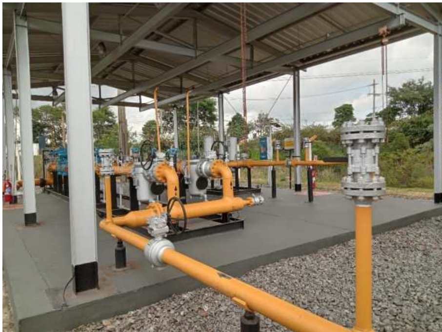
Foto 4: Tubulação de entrada de gás para ETC Cidade do Aço a 35 bar.
