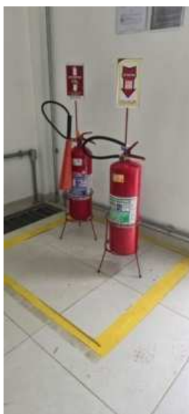
Foto 14: Adequação dos extintores de incêndio quanto à instalação de suportes apropriados.
