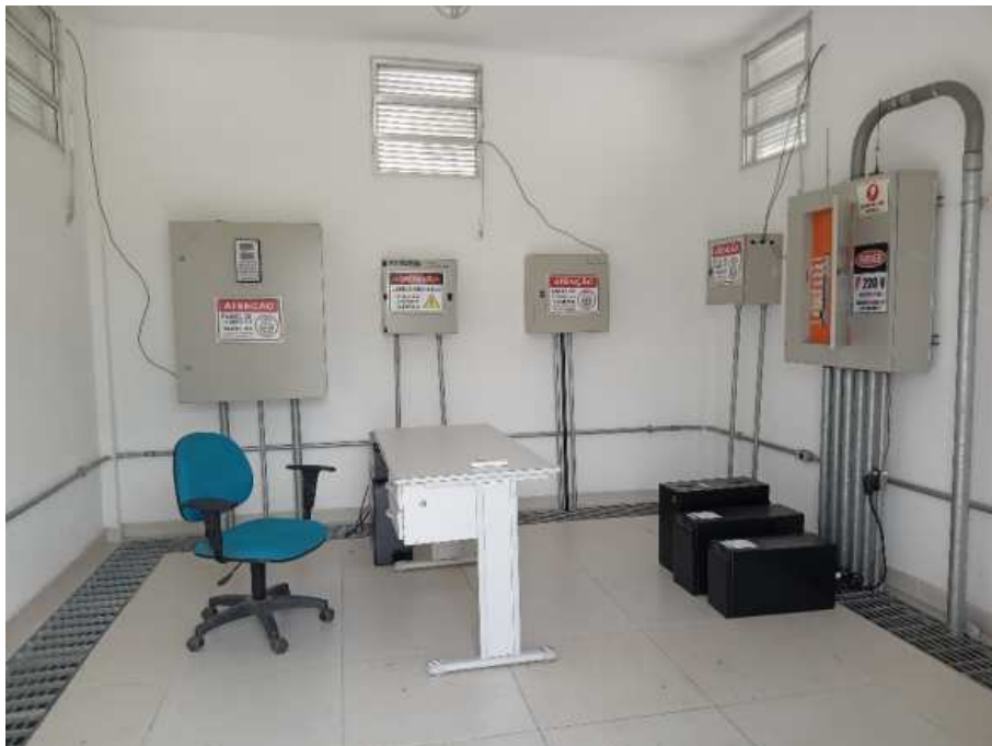
Foto 10: Sala de controle.
