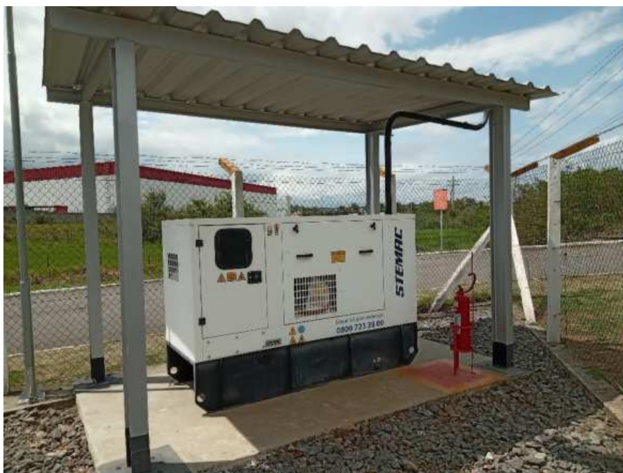
Foto 13: Gerador de emergência a diesel.
