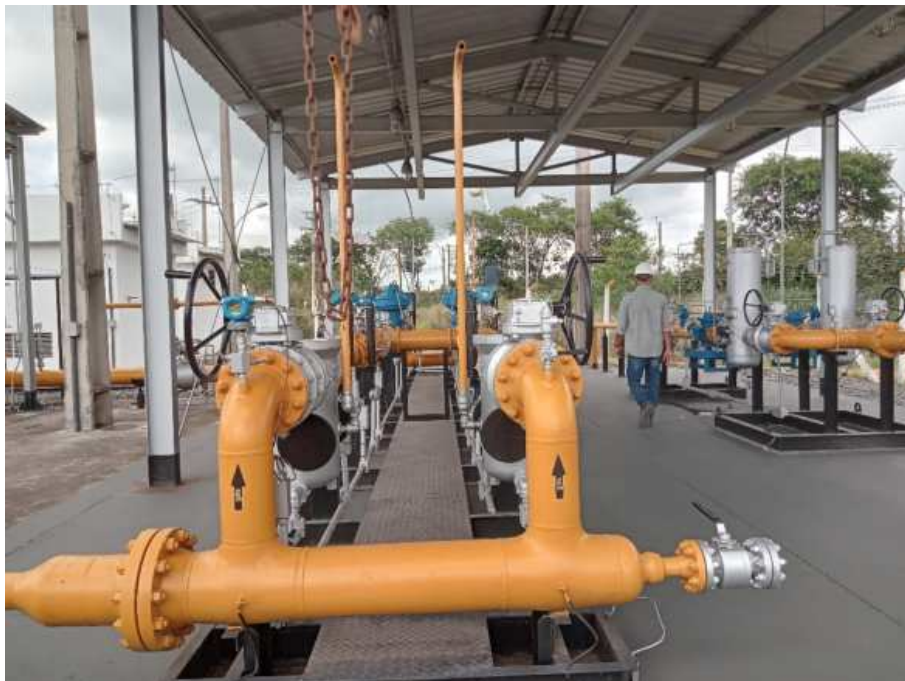
Foto 6: Skid industrial da ETC Cidade do Aço (entrada do gás).
