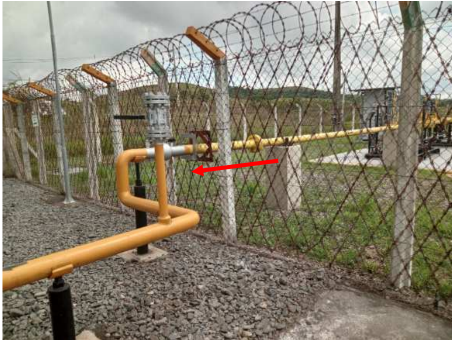
Foto 3: Tubulação de entrada do gás natural oriundo da NTS.
