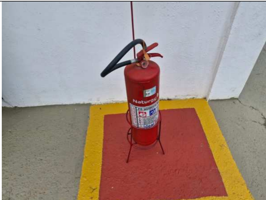
Foto 10: Extintor de incêndio e sinalização adequada no chão.
