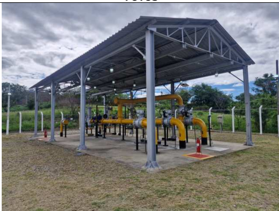
Foto 12: Visão geral da Estação
