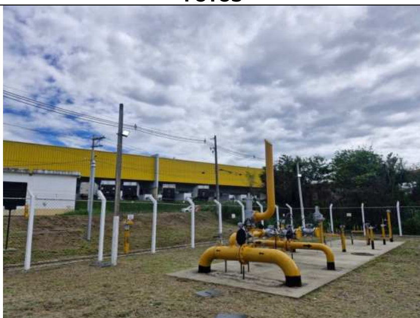
Foto 2: Linhas subterrâneas de entrada do gás.
