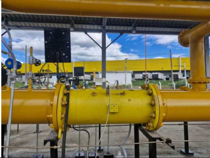
Foto 5: Medidor tipo turbina.
