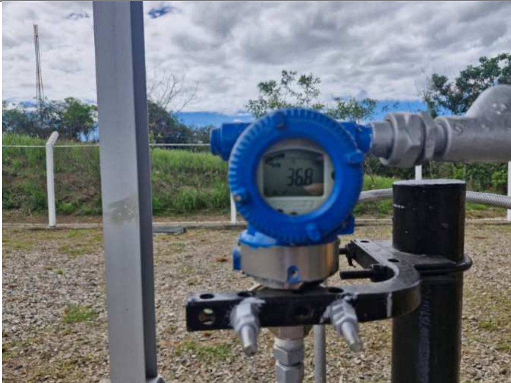
Foto 7: Pressão de Entrada.
