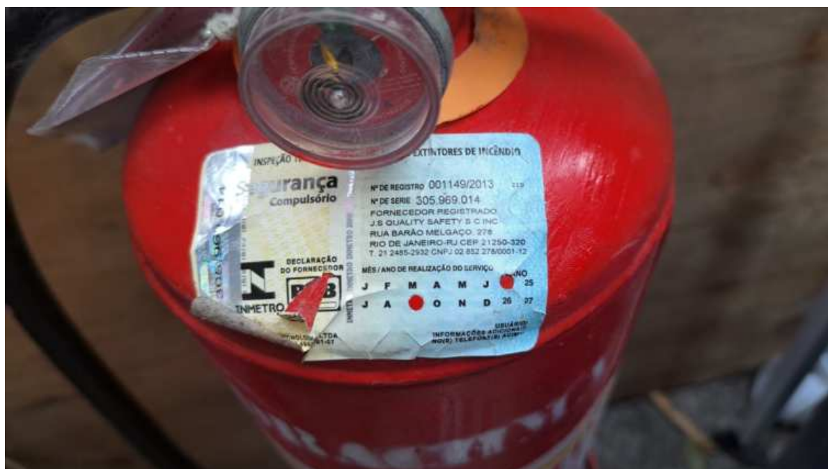
Foto 2: Extintor de água pressurizada na área de convivência.
