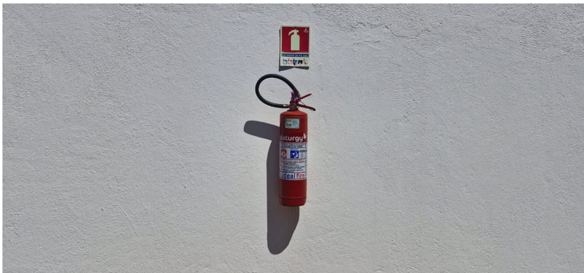
Foto 5: Extintor de incêndio exposto a intempéries.
