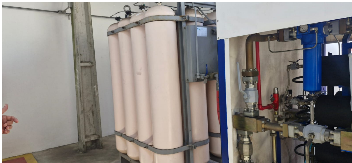
Foto 3: Cilindros de estocagem.
