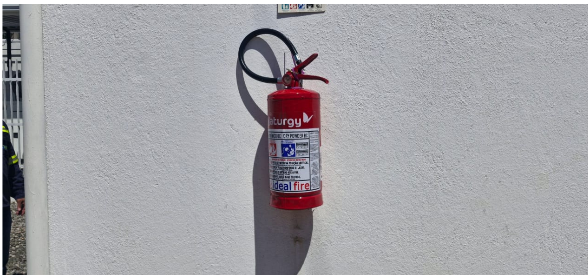
Foto 6: Extintor de incêndio exposto a intempéries.
