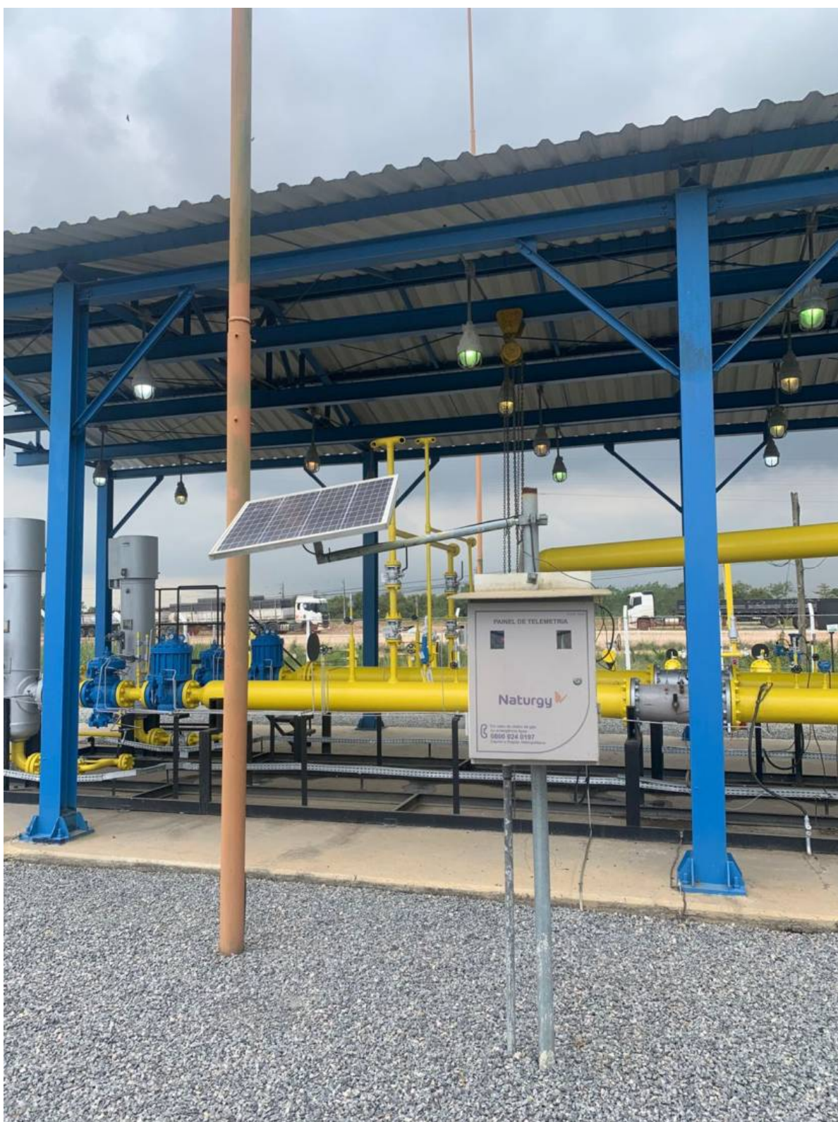
Foto 6: Visão da estação com o painel de telemetria à frente.
