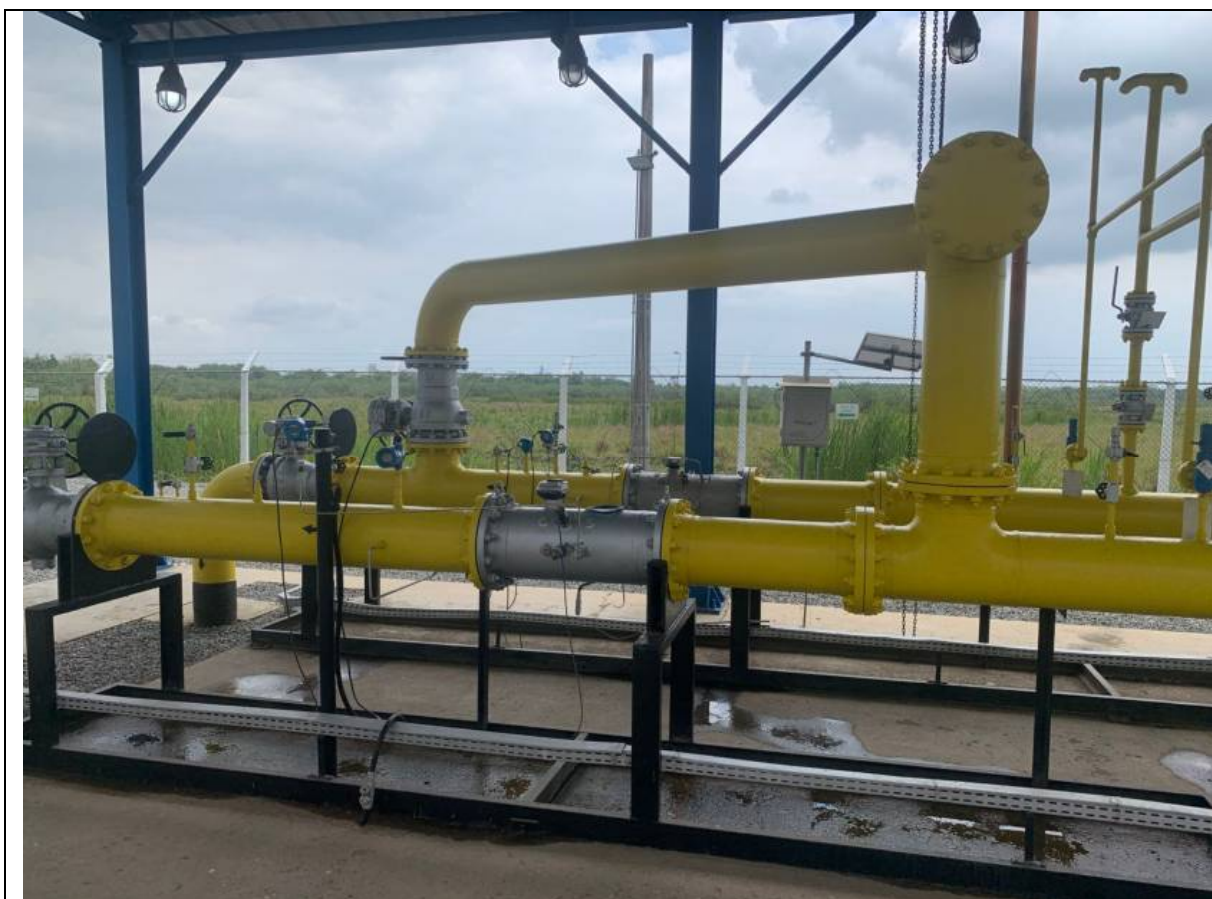
Foto 11: Dutos da estação.
