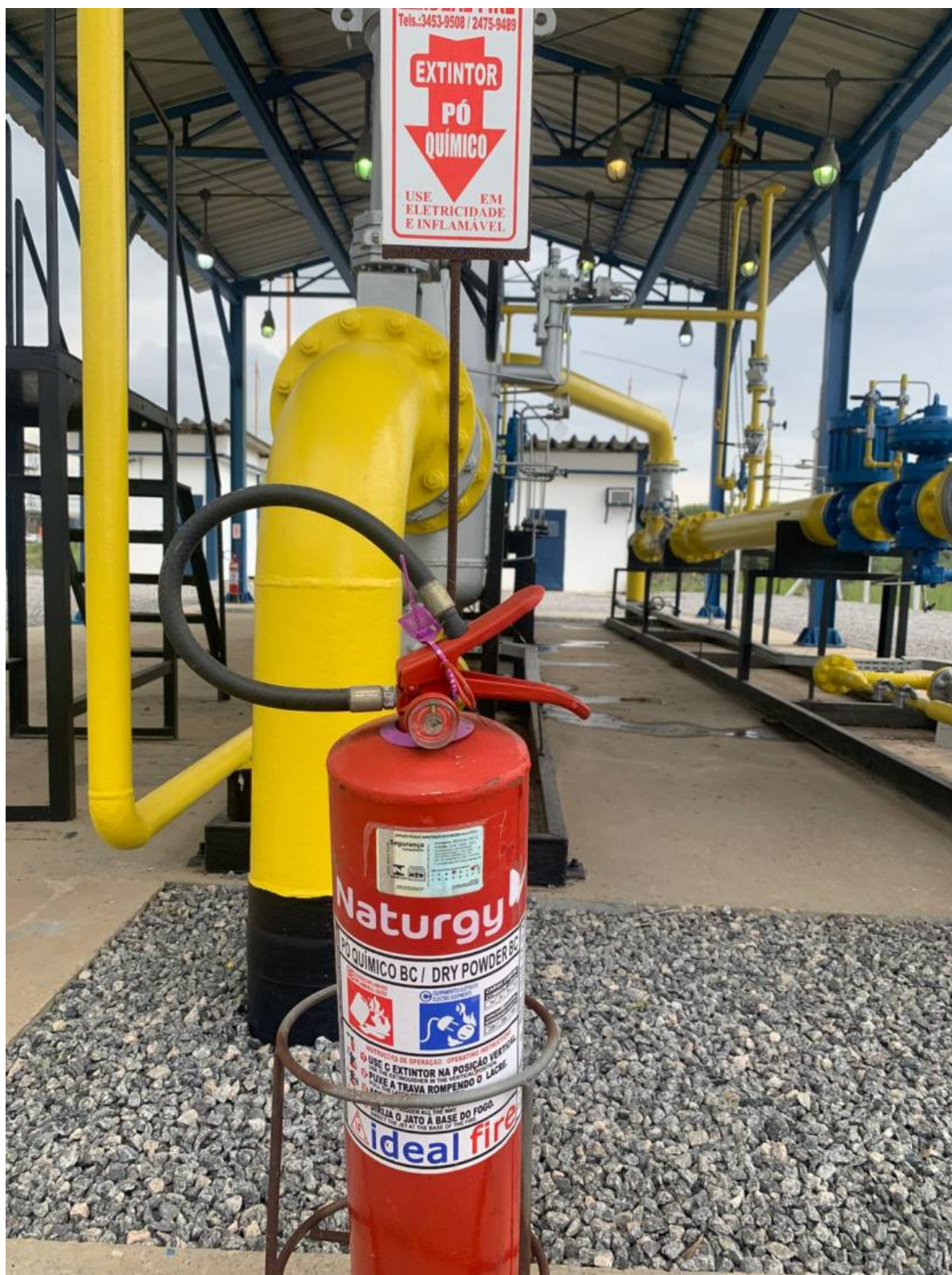
Foto 7: Um dos cinco extintores da estação.
