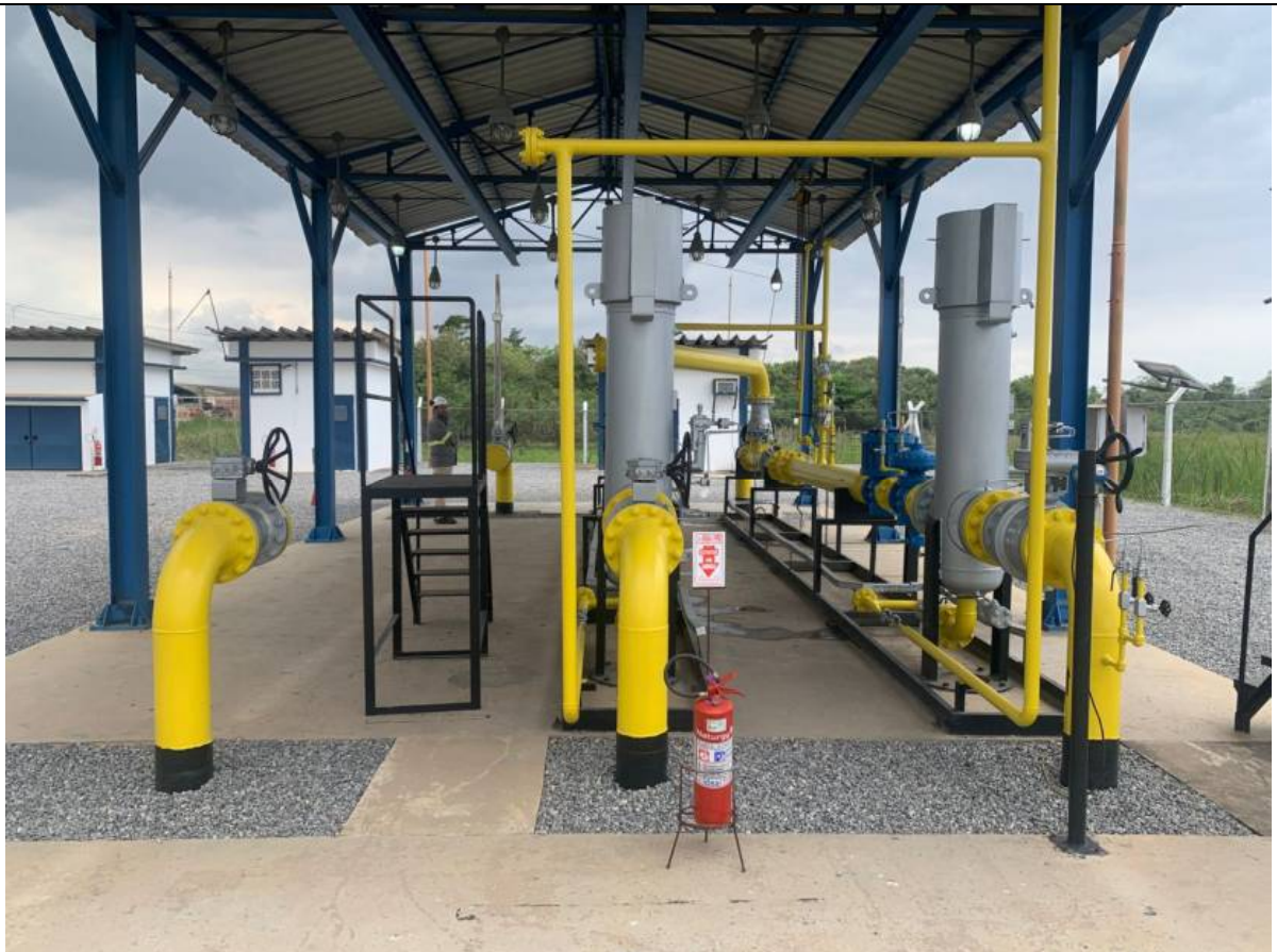
Foto 10: Visão geral da estação com o extintor à frente.
