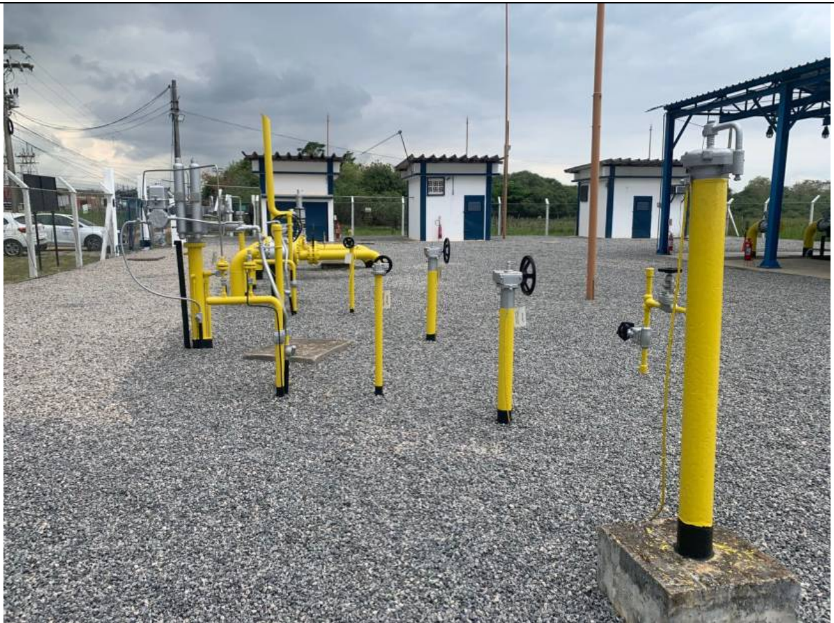
Foto 12: Visão geral da estação.
