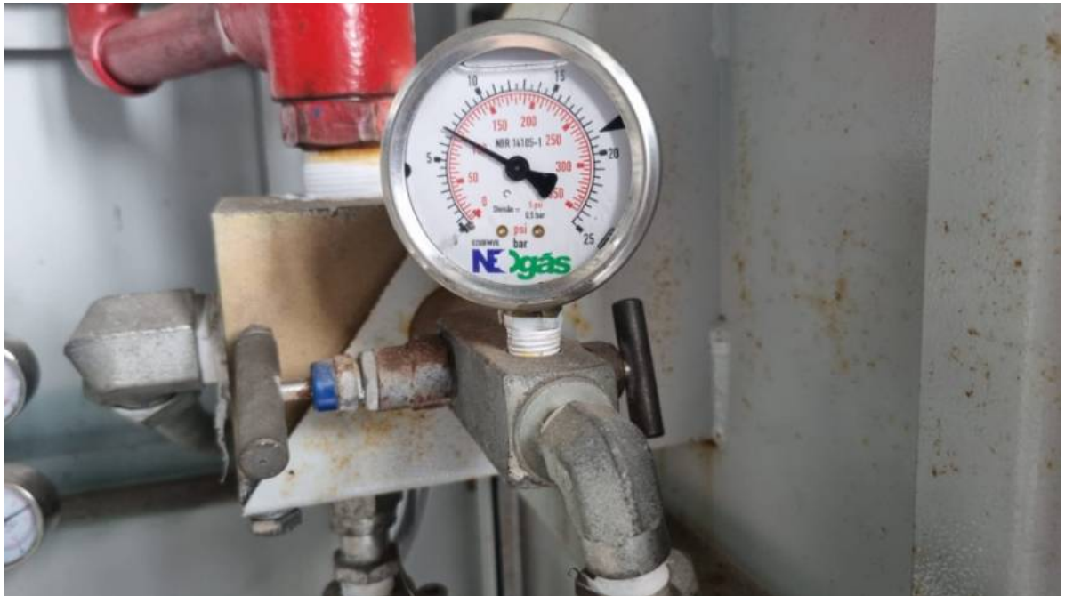
Foto 7: Medidor de pressão do gás dentro da RCU - a pressão é reduzida para 7 bar dentro da RCU através das válvulas de regulação.
