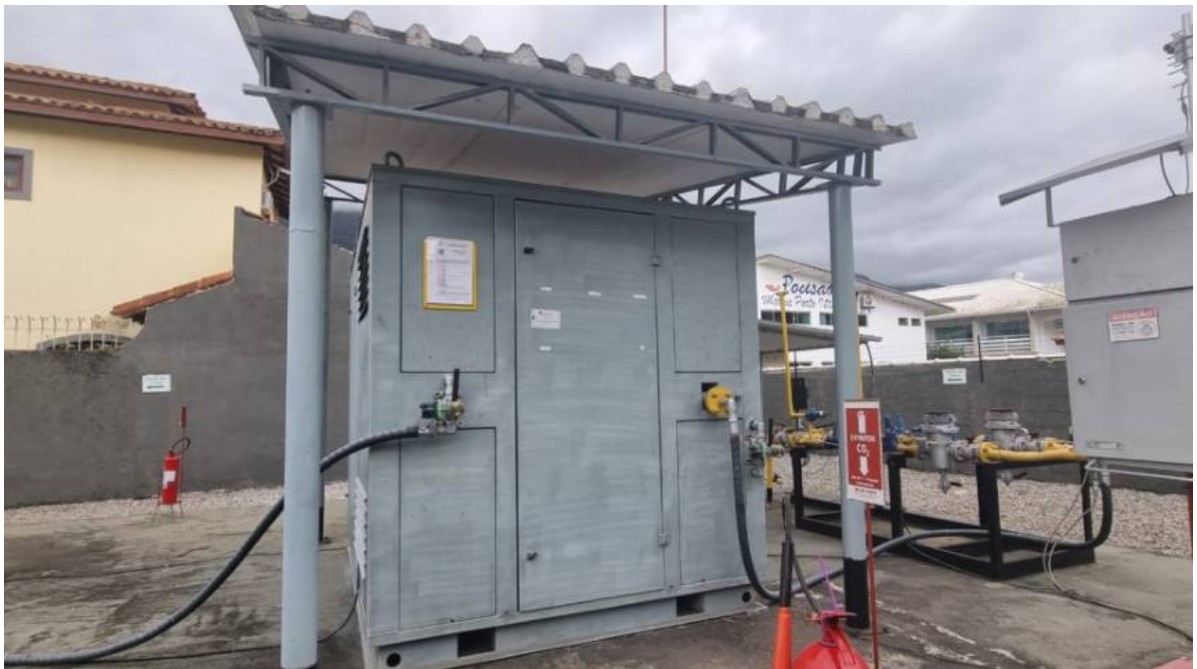
Foto 4: Unidade de Redução e Controle – RCU da estação.
