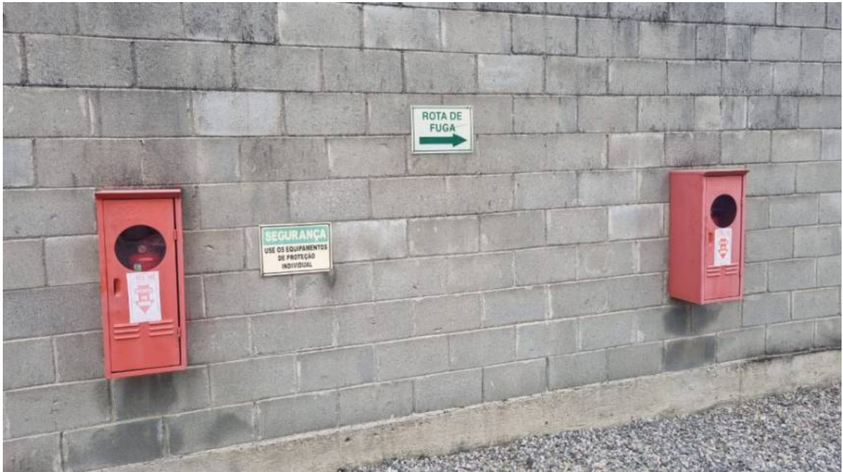
Foto 11: Sinalização de rota de fuga e de segurança e extintores com proteção contra intempéries.
