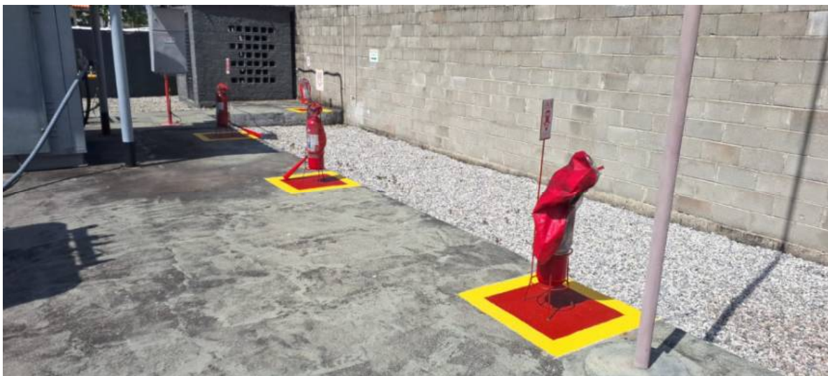
Foto 17: Extintores protegidos contra intempéries e com a sua demarcação pintada no piso após solicitação (comprovação fotográfica).
