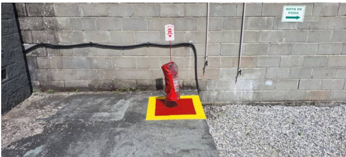
Foto 18: Extintor protegido contra intempéries e com a sua demarcação pintada no piso após solicitação (comprovação fotográfica).
