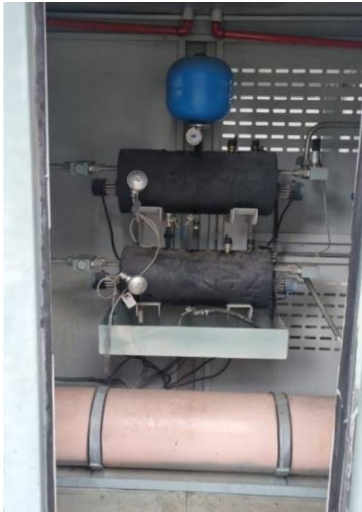
Foto 6: Parte interna da Unidade de Redução e Controle – RCU da estação.
