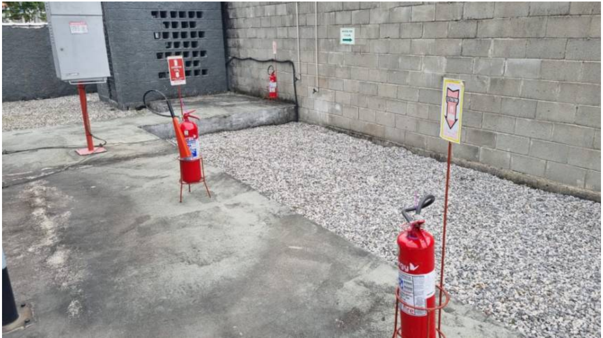
Foto 15: Extintores sem proteção contra intempéries.
