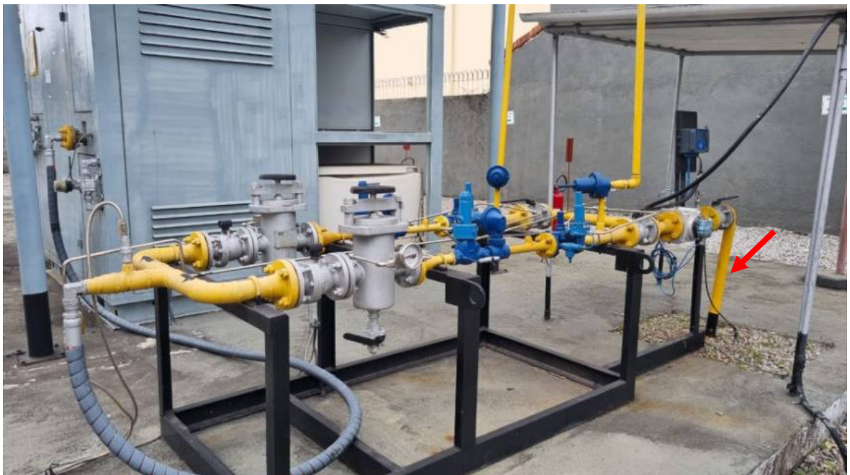
Foto 8: Módulo de regulação e medição composto por duas linhas – destaque para a linha de saída para distribuição na rede subterrânea.
