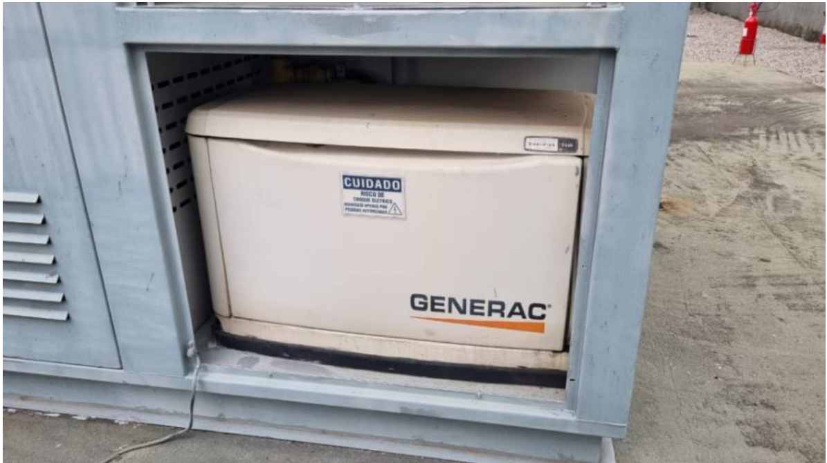
Foto 9: Gerador a gás localizado dentro da RCU.
