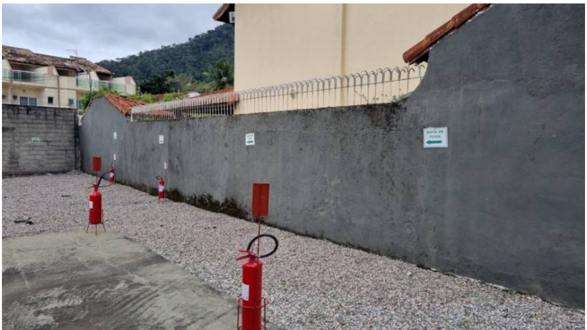
Foto 14: Extintores sem proteção contra intempéries.
