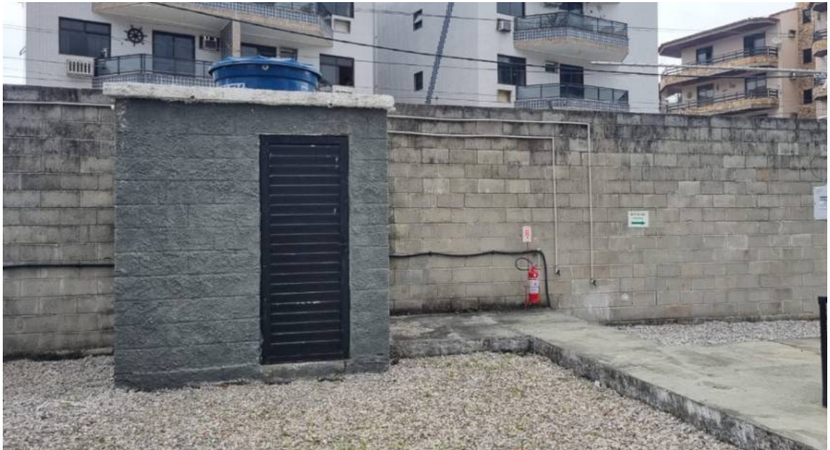
Foto 13: Local de abrigo do antigo gerador a óleo e extintor sem proteção contra intempéries.
