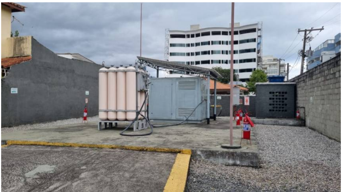
Foto 2: Vista frontal da Estação de Descompressão localizada em Itacuruá, Mangaratiba/RJ.
