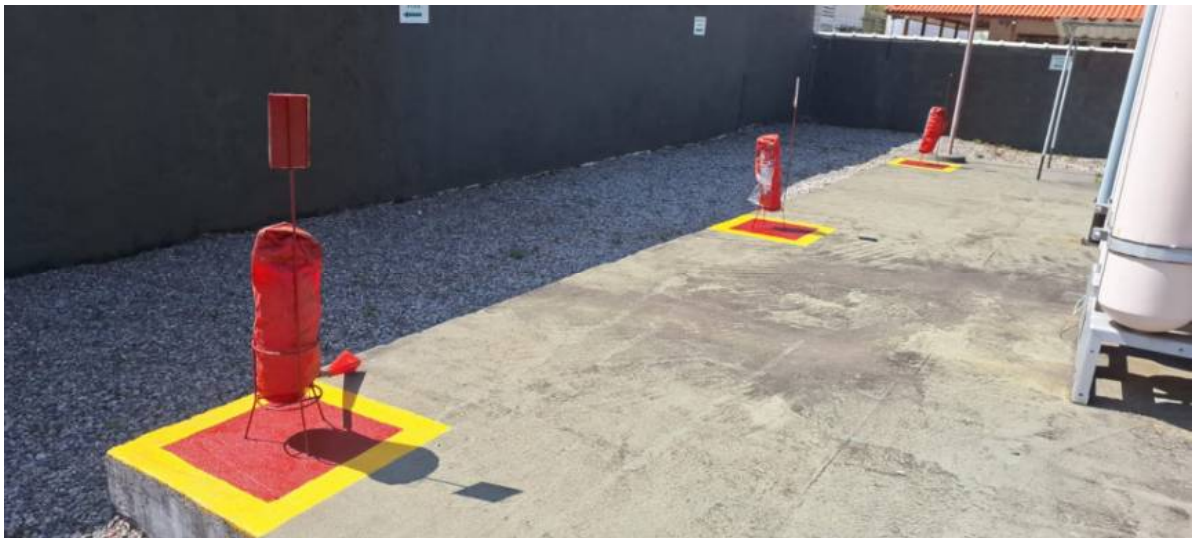
Foto 16: Extintores protegidos contra intempéries e com a sua demarcação pintada no piso após solicitação (comprovação fotográfica).
