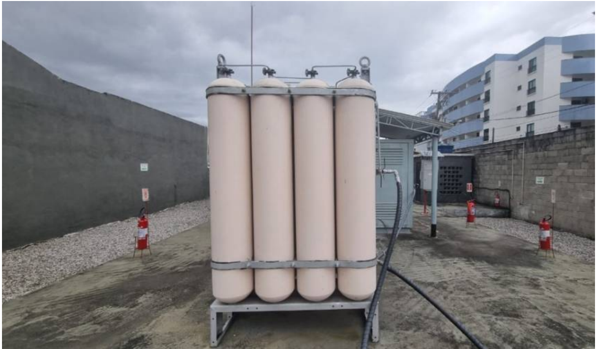
Foto 3: Sistema de estocagem de GNC composto por 16 cilindros verticais.
