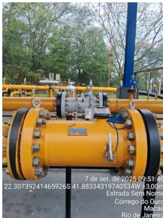
Foto 5: Desgaste do revestimento de proteção em turbina (foto enviada pelo representante da Concessionária).
