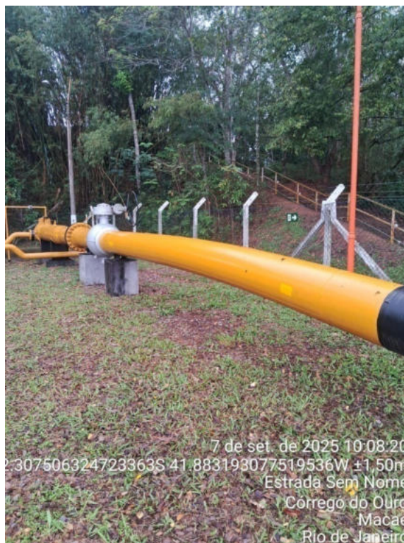
Foto 11: Correção do sentido das setas no canhão de PIG (foto enviada pelo representante da Concessionária).
