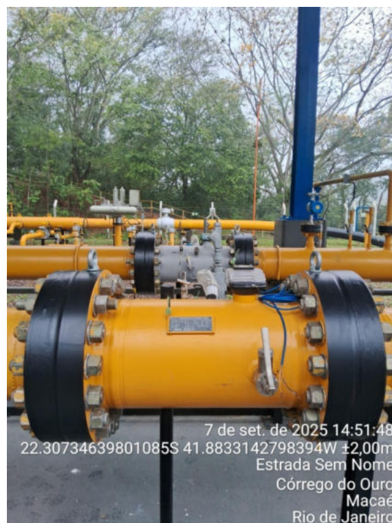
Foto 6: Fita de proteção reposta na turbina (foto enviada pelo representante da Concessionária).
