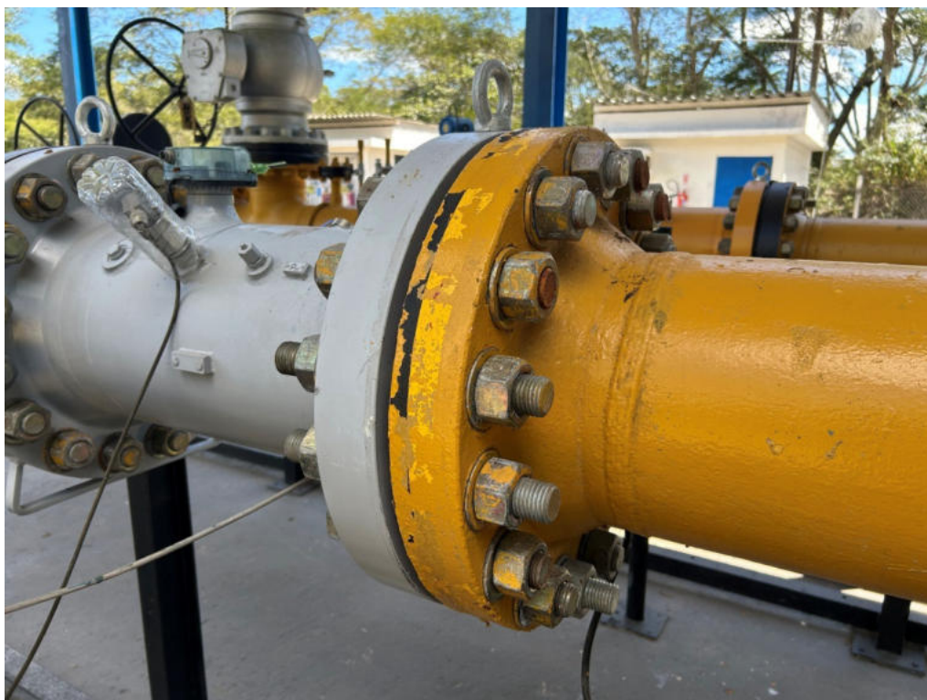
Foto 4: Descascamento de pintura na estação de medição.
