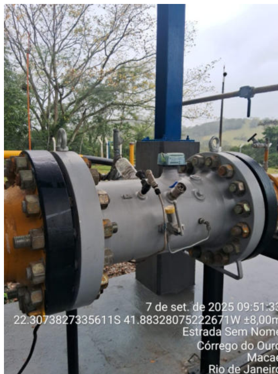
Foto 7: Desgaste do revestimento de proteção em turbina (foto enviada pelo representante da Concessionária).
