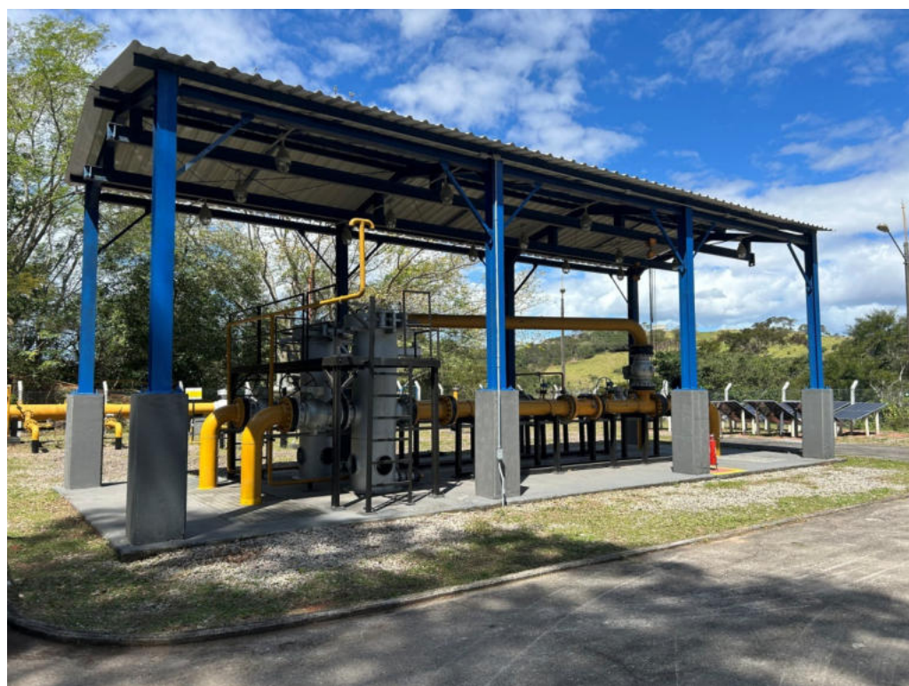
Foto 2: Estação de medição, com filtros visíveis.
