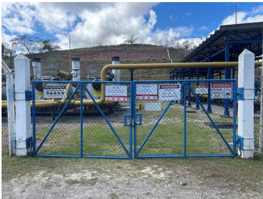
Foto 1: Entrada da estação com placas de identificação e sinalização de segurança.
