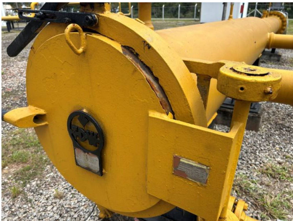
Foto 11: Tampa do canhão de PIG apresentando descascamento da pintura.
