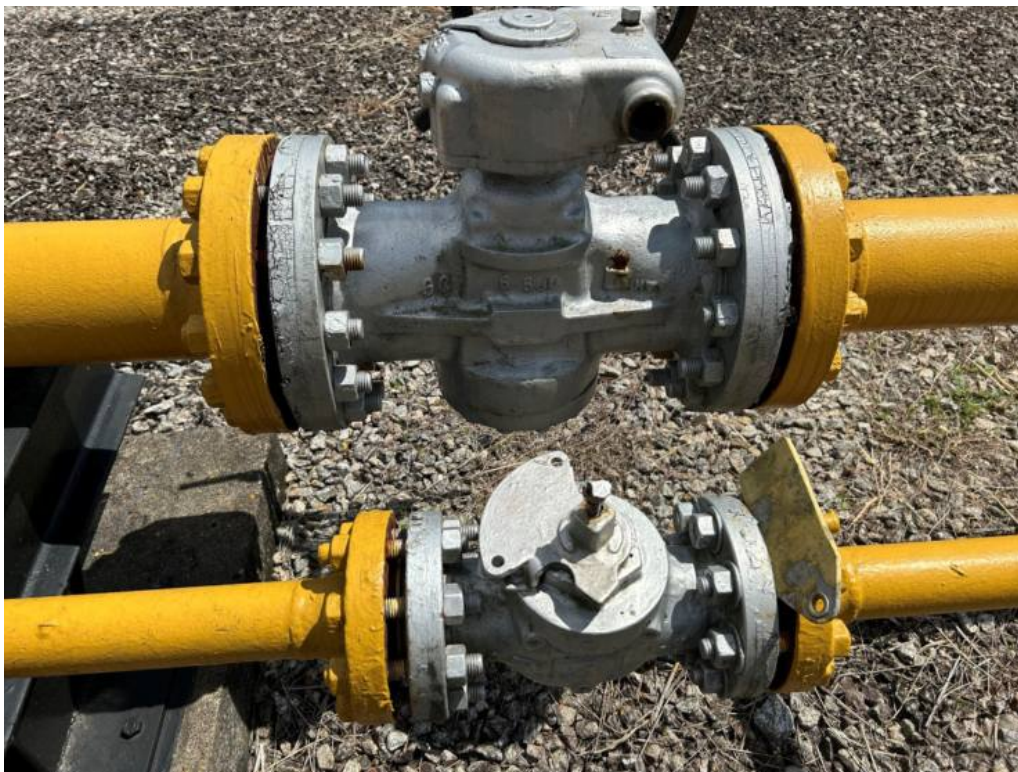
Foto 13: Flanges do bypass do canhão de PIG sem fitas de proteção e com descascamento de pintura.
