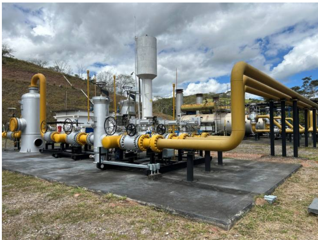
Foto 5: Direcionamento do duto para a estação, com sistema de filtragem.
