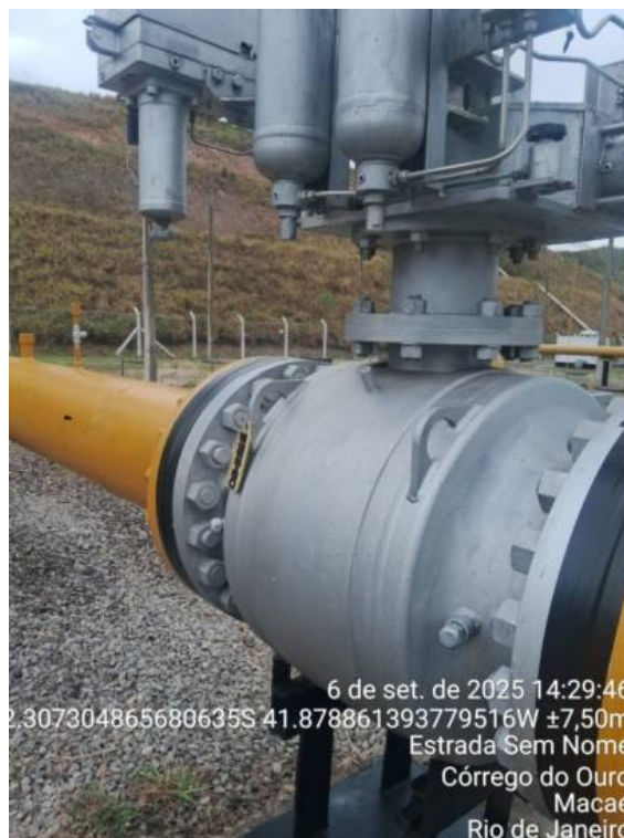
Foto 10: Válvula do canhão de PIG após a retirada do ninho (foto enviada pelo representante da Concessionária).
