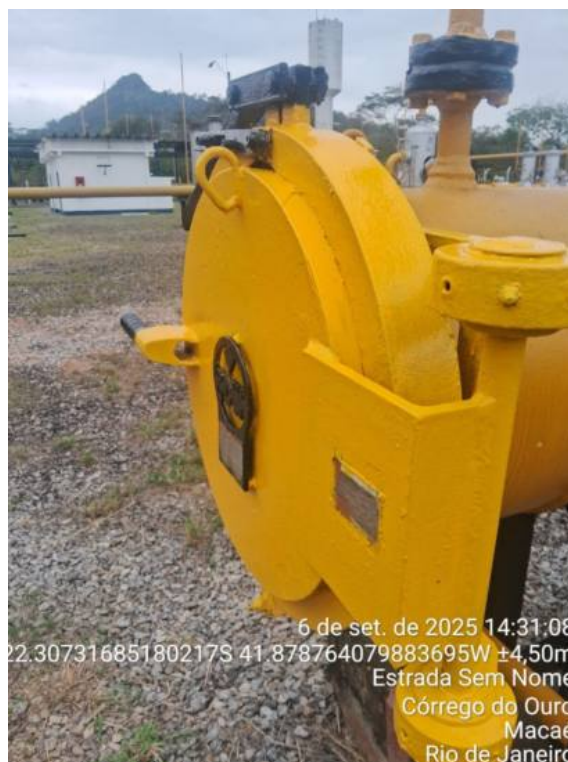
Foto 12: Tampa do canhão de PIG com pintura reparada (foto enviada pelo representante da Concessionária).
