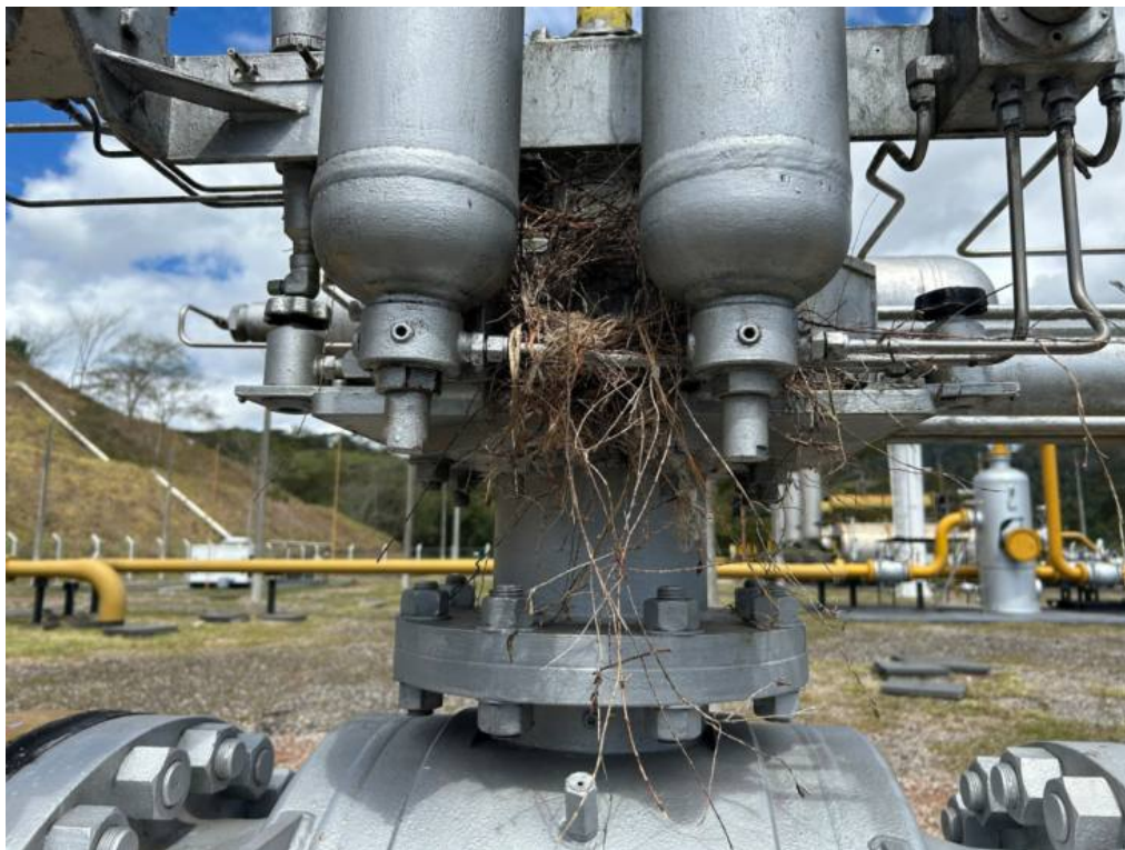
Foto 9: Ninho de pássaro na válvula de bloqueio do canhão receptor de PIG.
