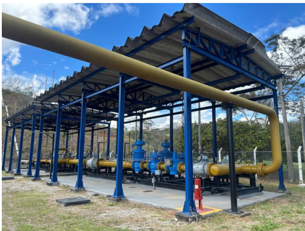
Foto 2: Entrada do gás na Estação de Regulagem e Medição.
