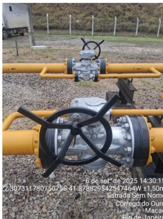
Foto 14: Flanges do bypass do canhão de PIG após reposição das fitas de proteção (foto enviada pelo representante da Concessionária).
