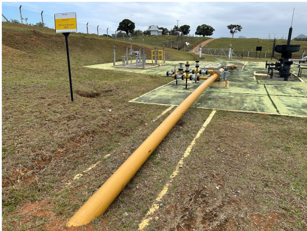
Foto 3: Placa de identificação e válvula da Concessionária.
