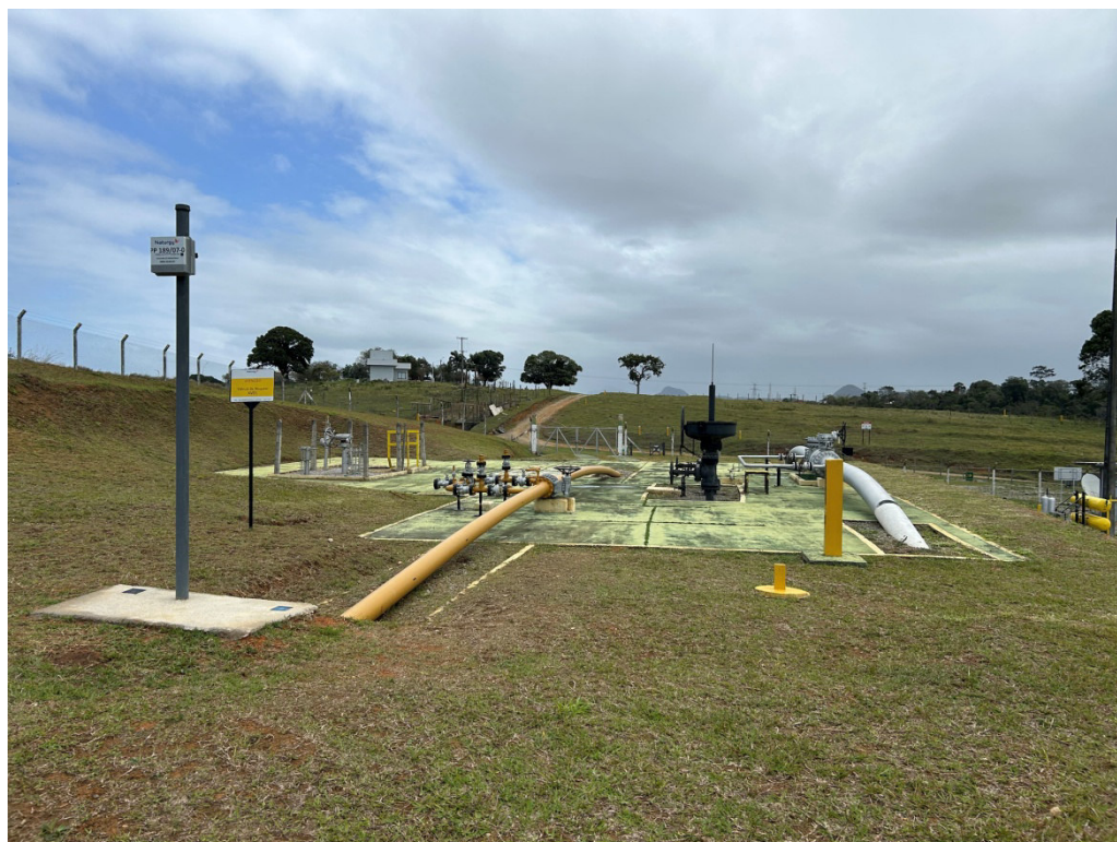
Foto 2: Área compartilhada da estação, com a válvula da Concessionária entre os gasodutos da NTS.
