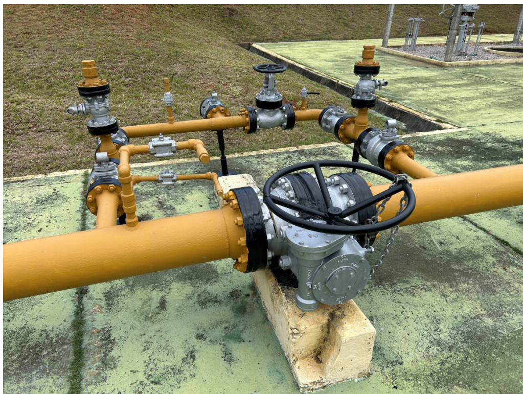
Foto 4: Válvula de bloqueio (à frente) e bypass (atrás).
