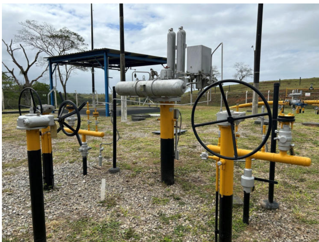
Foto 6: Válvulas de bloqueio e manobra para o canhão lançador de PIG da UTE Norte-Fluminense.
