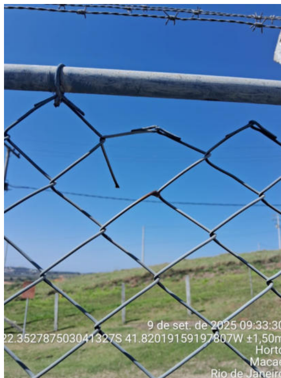
Foto 9: Falha na cerca (foto enviada pelo representante da Concessionária).
