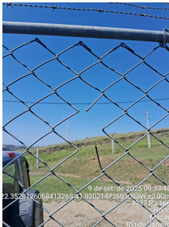
Foto 11: Falha na cerca (foto enviada pelo representante da Concessionária).
