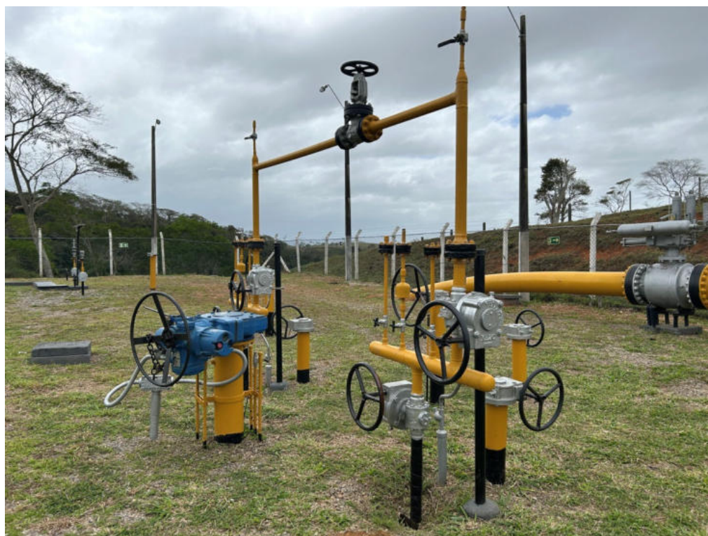
Foto 4: Válvulas de bloqueio e manobra para o canhão lançador de PIG da UTE Mário Lago.
