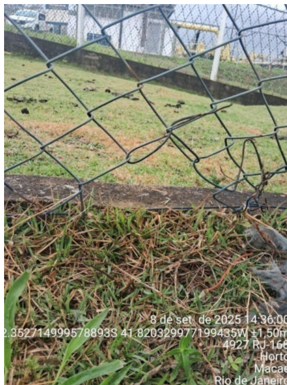
Foto 7: Falha na cerca (foto enviada pelo representante da Concessionária).
