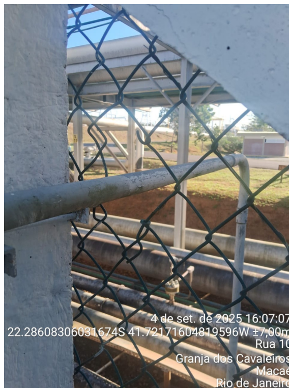
Foto 5: Falha observada na cerca (foto enviada pelo representante da Concessionária).
