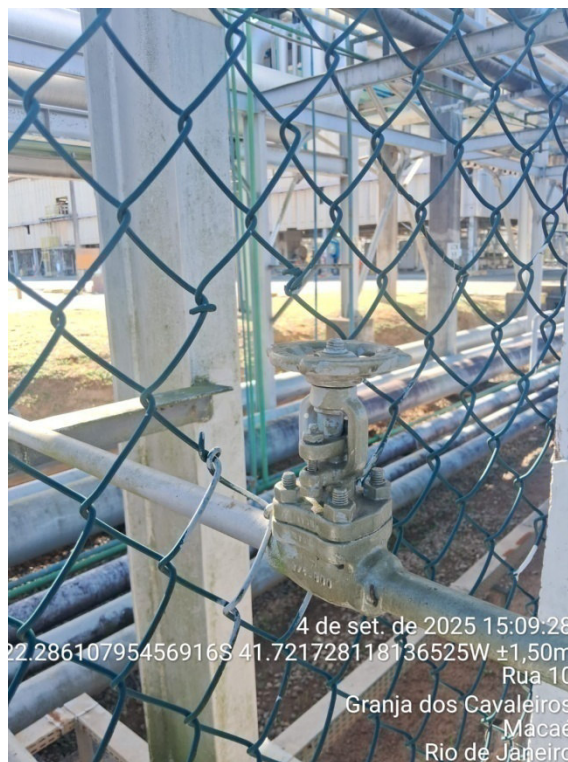
Foto 7: Falha observada na cerca (foto enviada pelo representante da Concessionária).
