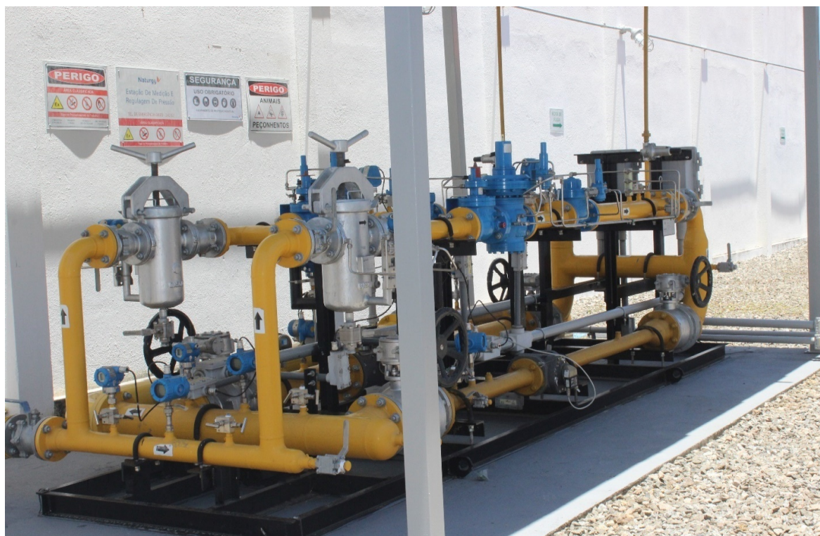
Foto 8: Estação de Regulação e Medição 7 / 4 bar
