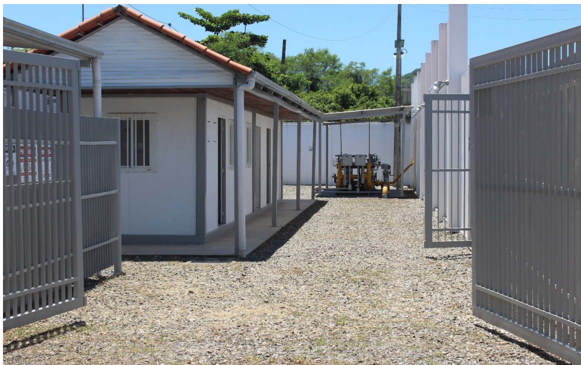
Foto 3: Entrada da estação de regulação e medição e salas de controle e operação
