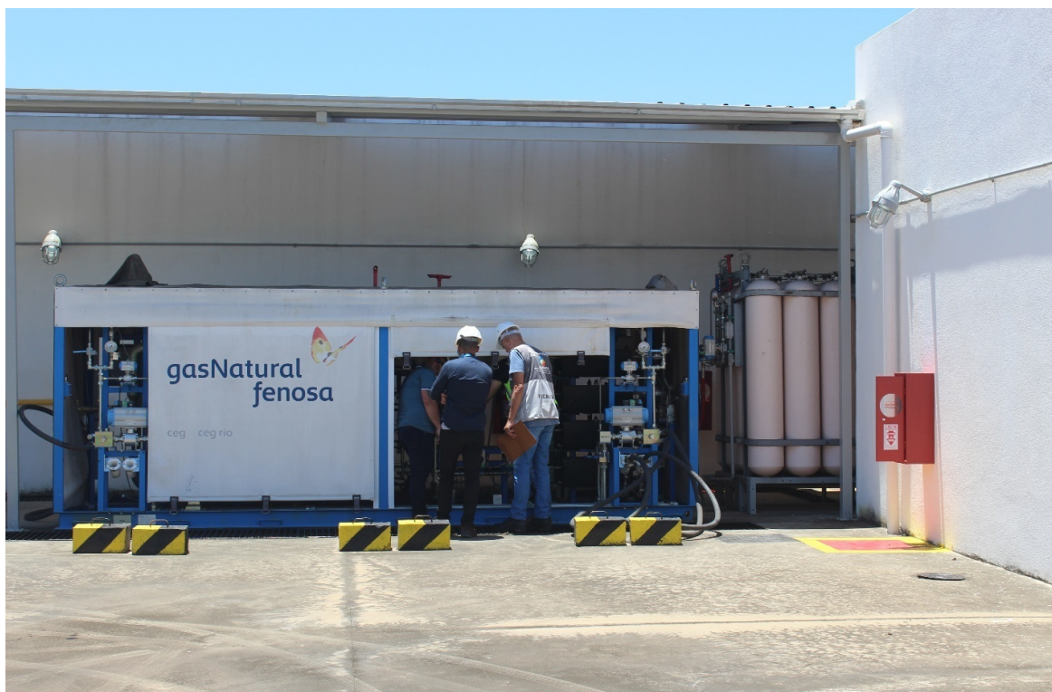
Foto 4: Unidade de Controle e Redução (RCU)
