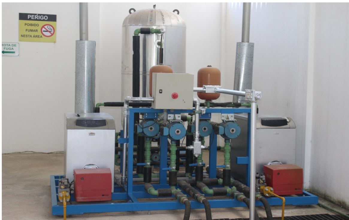
Foto 9: Sistema trocador de calor (aquecimento, armazenamento e recalque)
