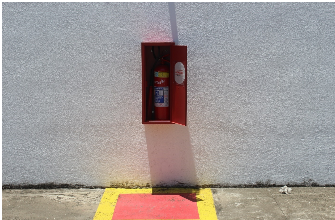
Foto 12: Extintor de CO2
