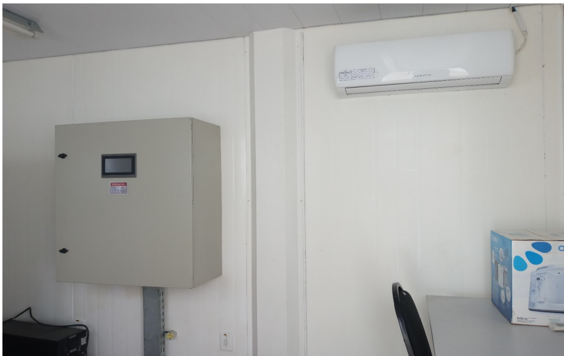
Foto 11: Sala de controle (RCU)
