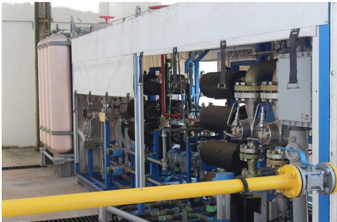
Foto 6: Sistema de regulagem, trocador de calor e estocagem
