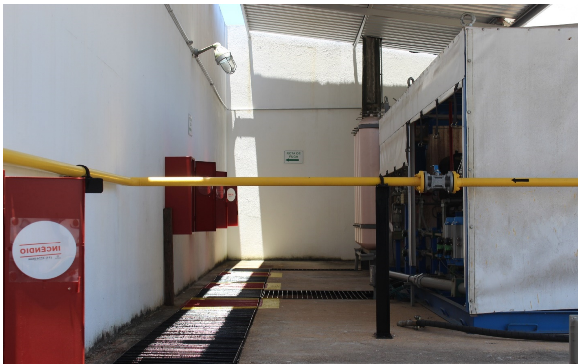
Foto 7: Tubulação de saída da RCU a 7 bar e extintores de incêndio
