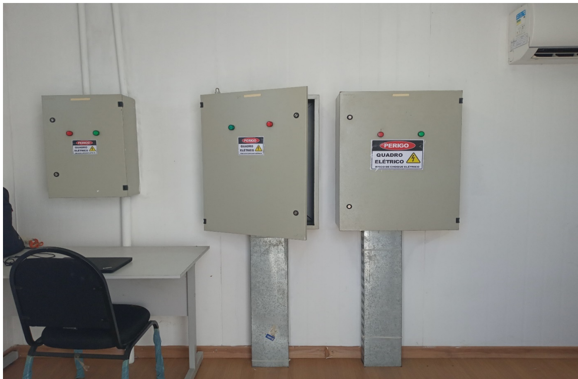
Foto 10: Sala de controle (sistema elétrico)
