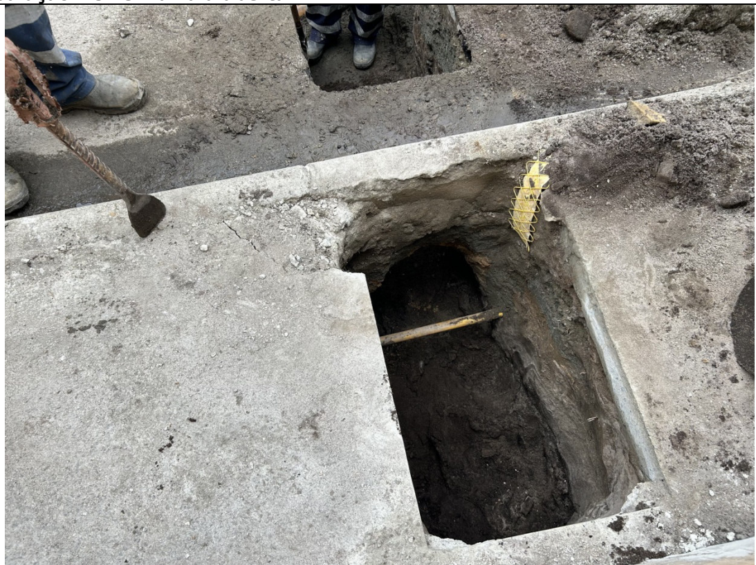
Foto 10: Rede antiga de PE Ø32 mm exposta ao lado da nova escavação.
