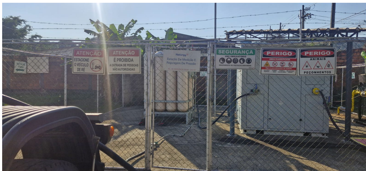
Foto 1: Identificação da Estação de Descompressão de Pequeno Porte - Cachoeiras de Macacu .
