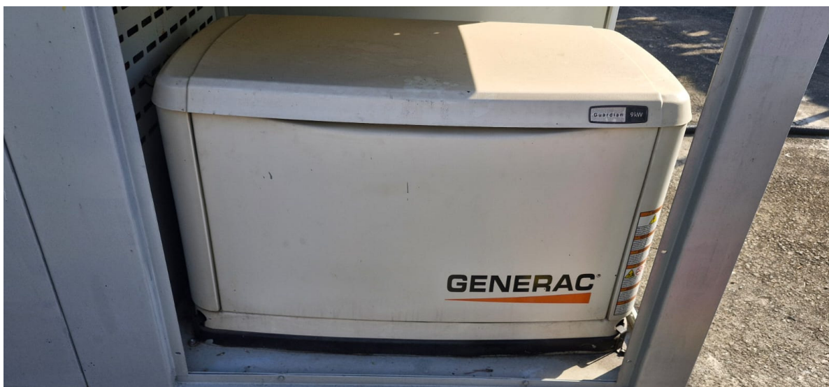
Foto 4: Gerador à gás.
