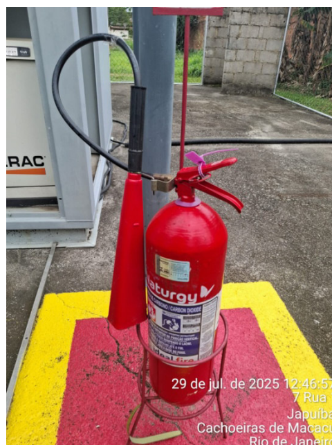
Foto 8: Extintor de incêndio
