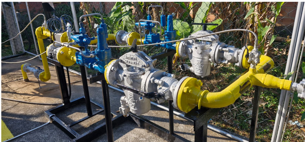
Foto 3: Estação de Regulação e Medição.
