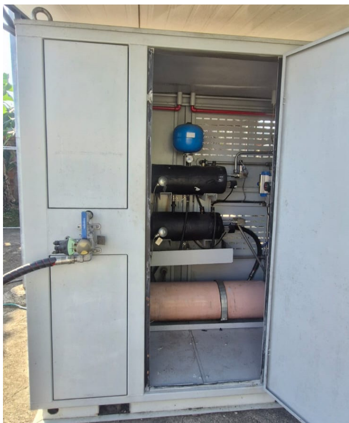
Foto 2: Unidade de Redução de Pressão (RCU)
