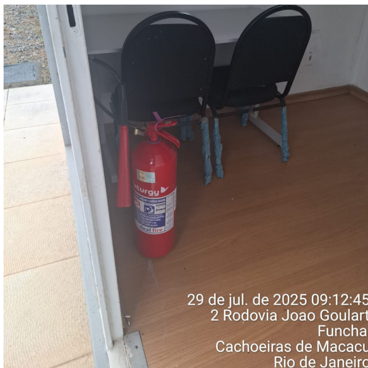
Foto 7: 15º Extintor de Incêndio.
