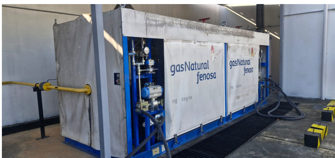
Foto 2: Unidade de Redução de Pressão (RCU)
