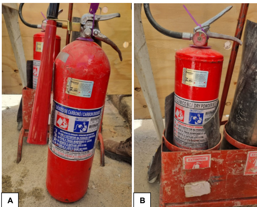
Foto 12: Extintores de incêndio dentro do local de vivência: A) Extintor tipo CO 2 ; B) Extintor tipo Pó Químico.
