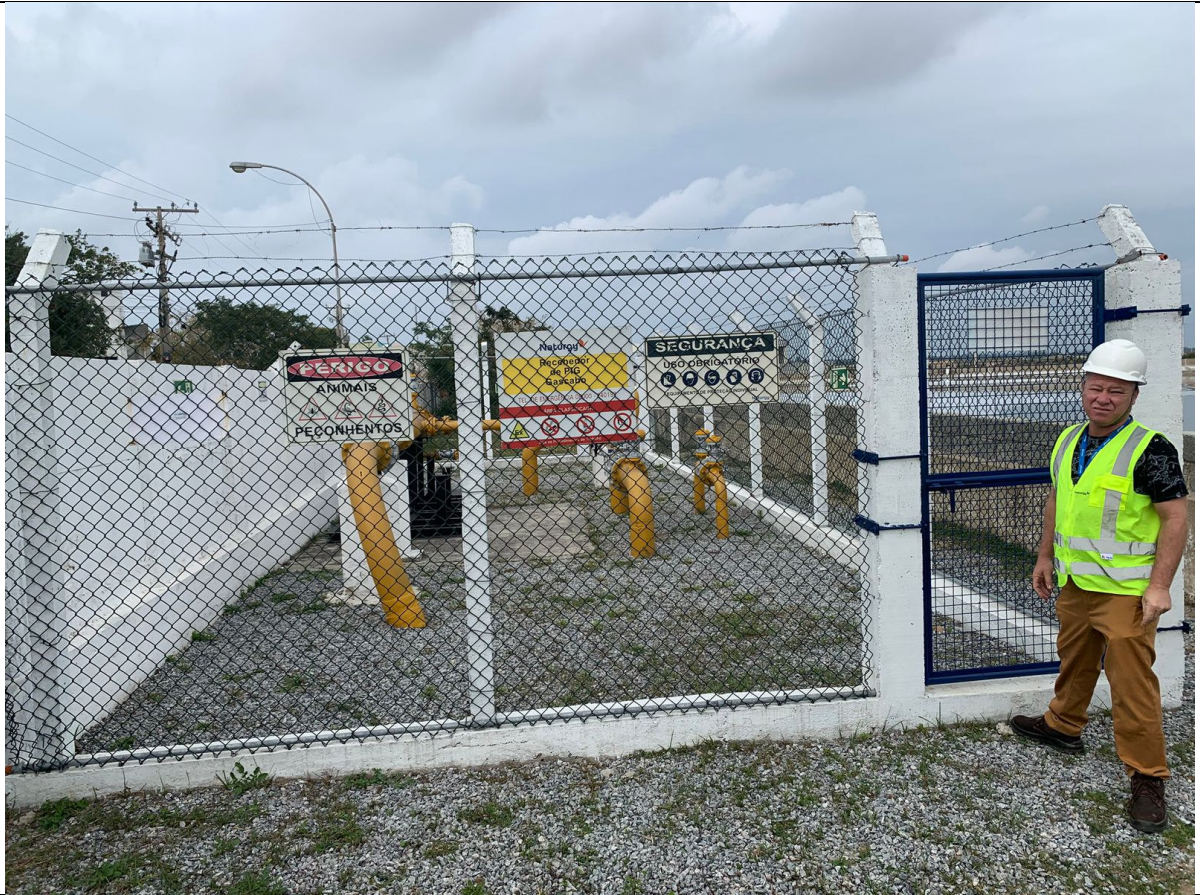
Foto 5: Placas de sinalização de segurança da estação.
