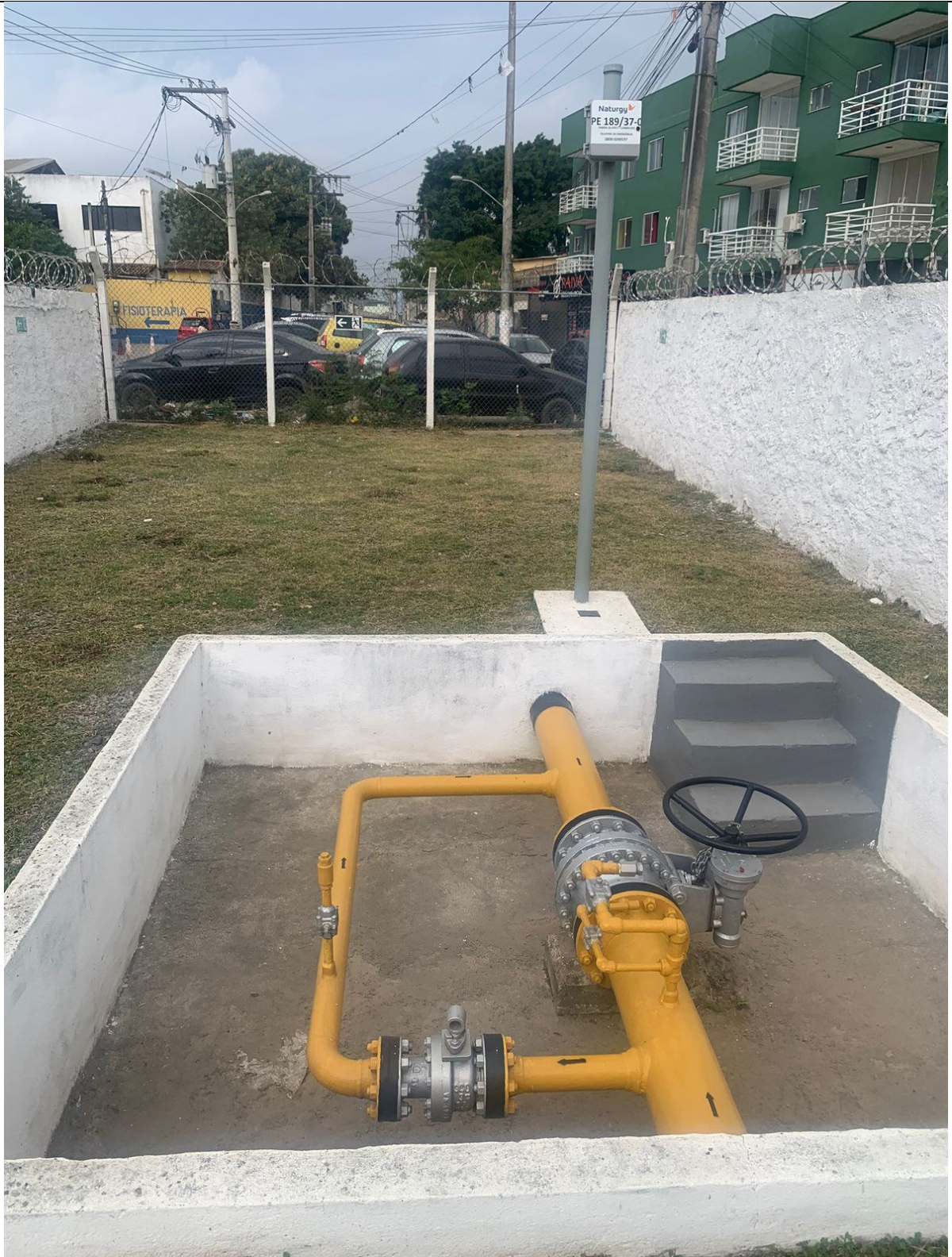
Foto 2: Válvula de linha e duto de aço 8".
