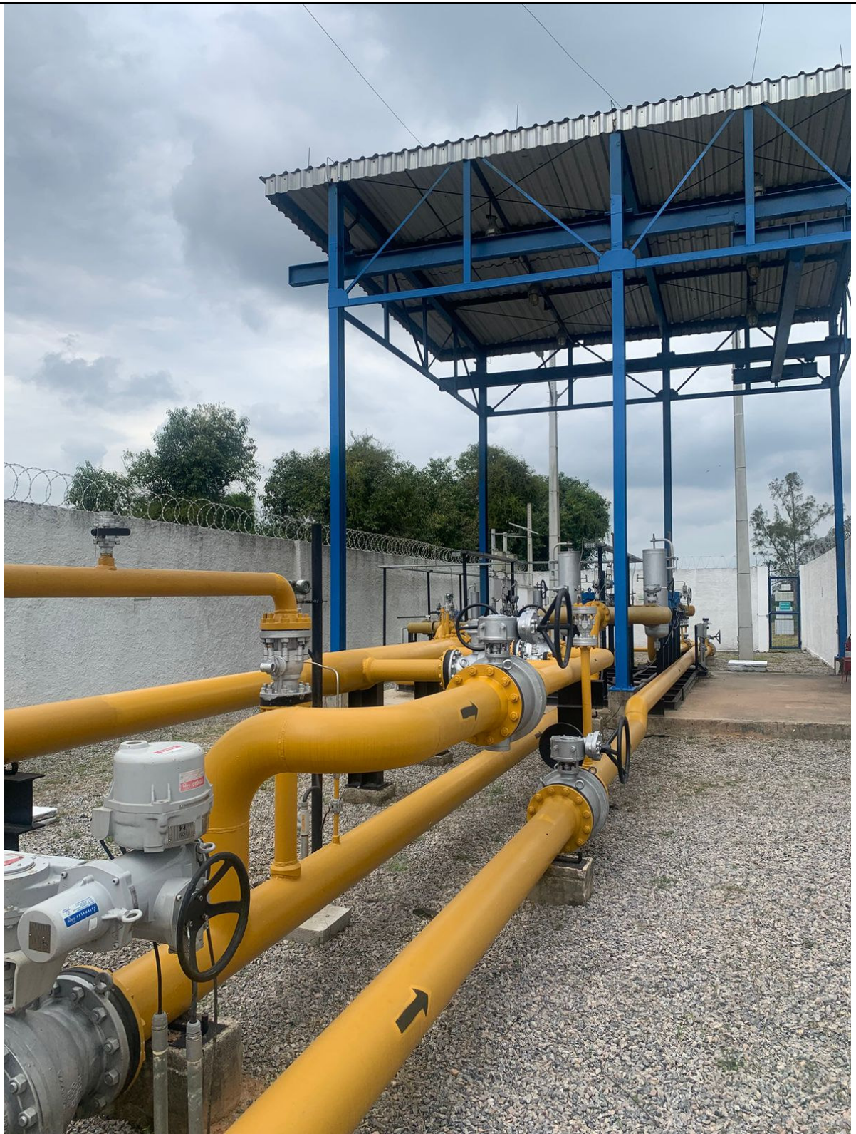
Foto 8: Tubulações da estação sinalizadas com setas indicativas da direção do fluxo de gás.
