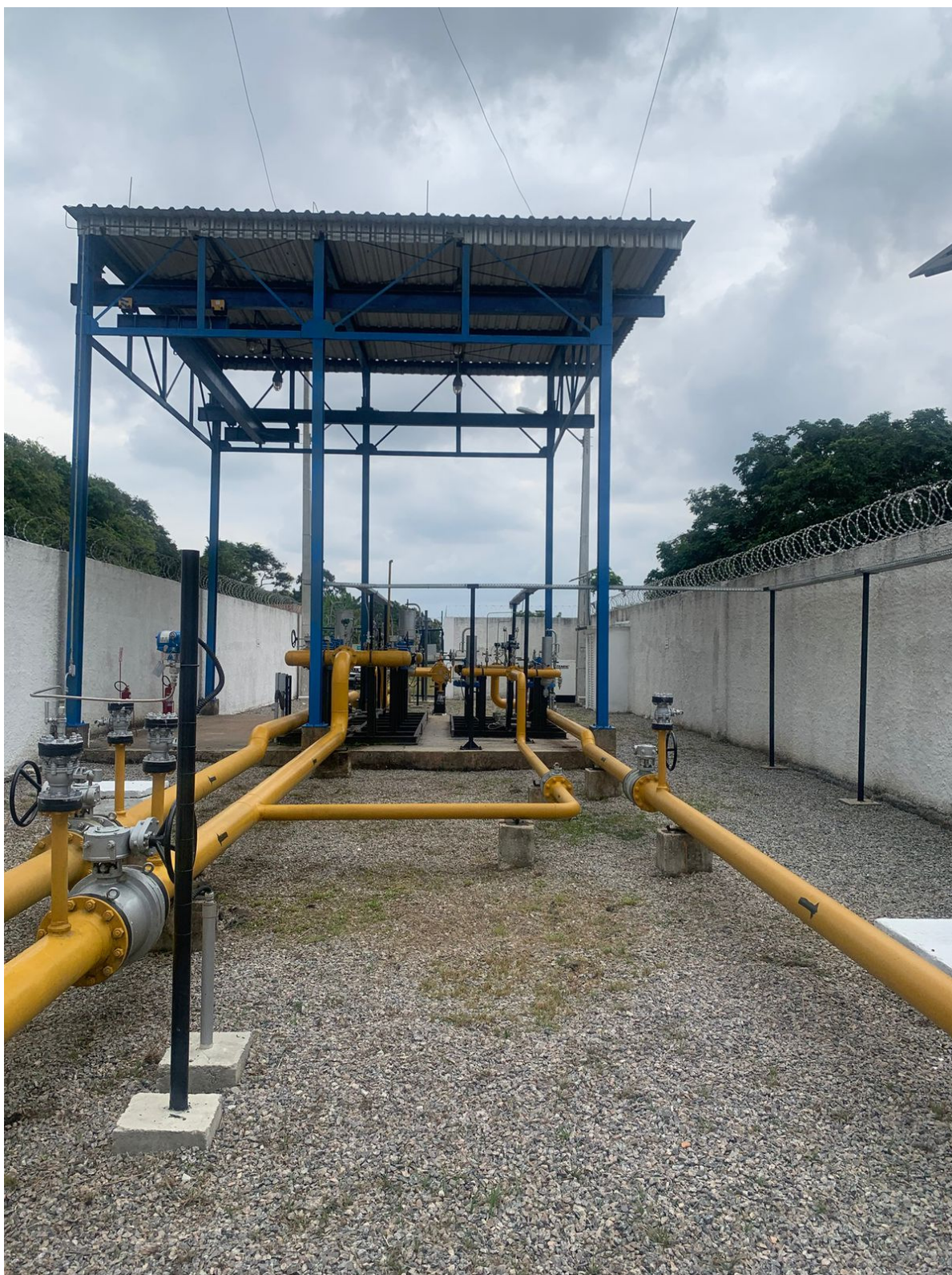
Foto 2: Estação de regulação e medição.
