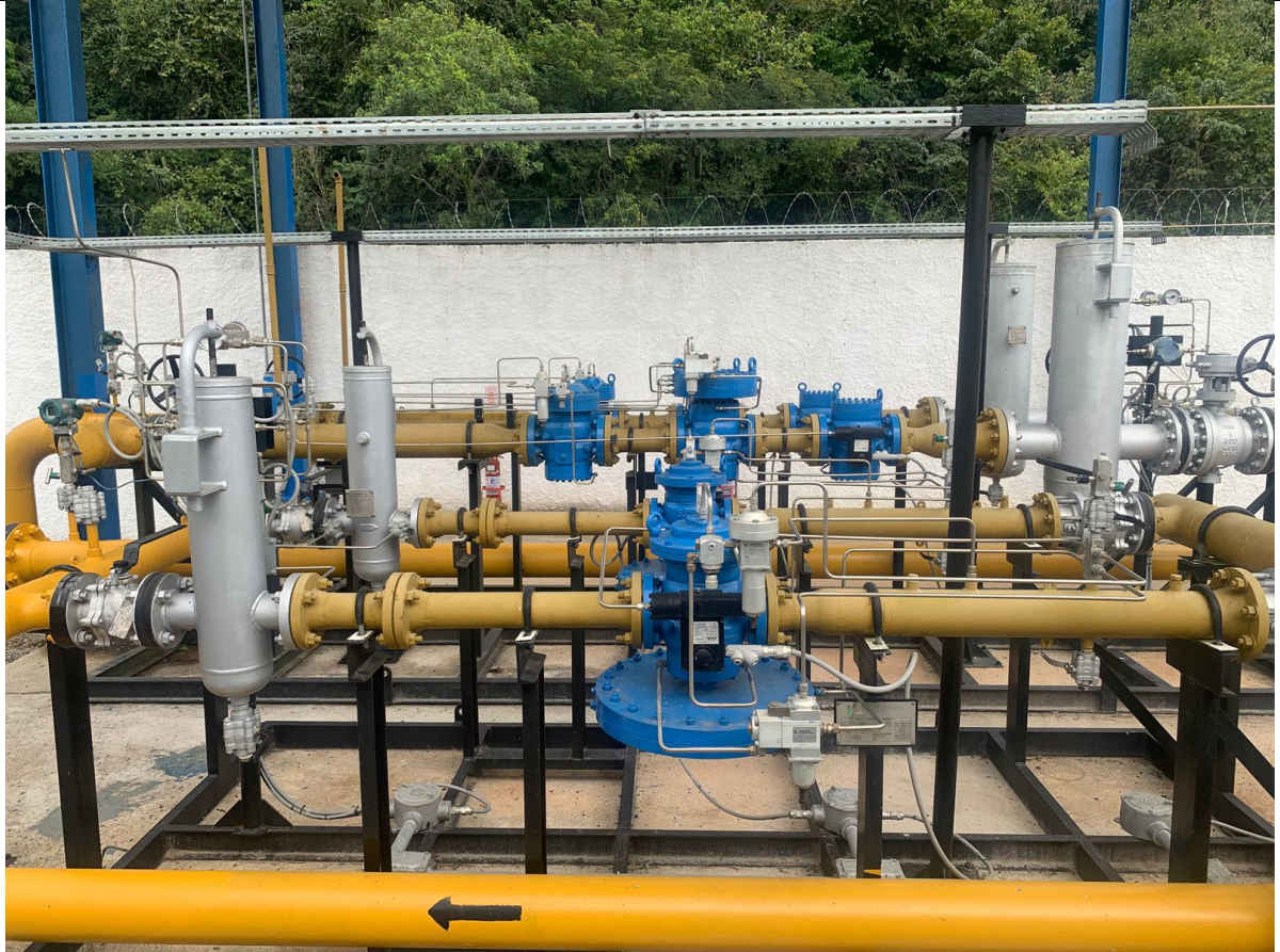
Foto 7: Visão geral da estação.
