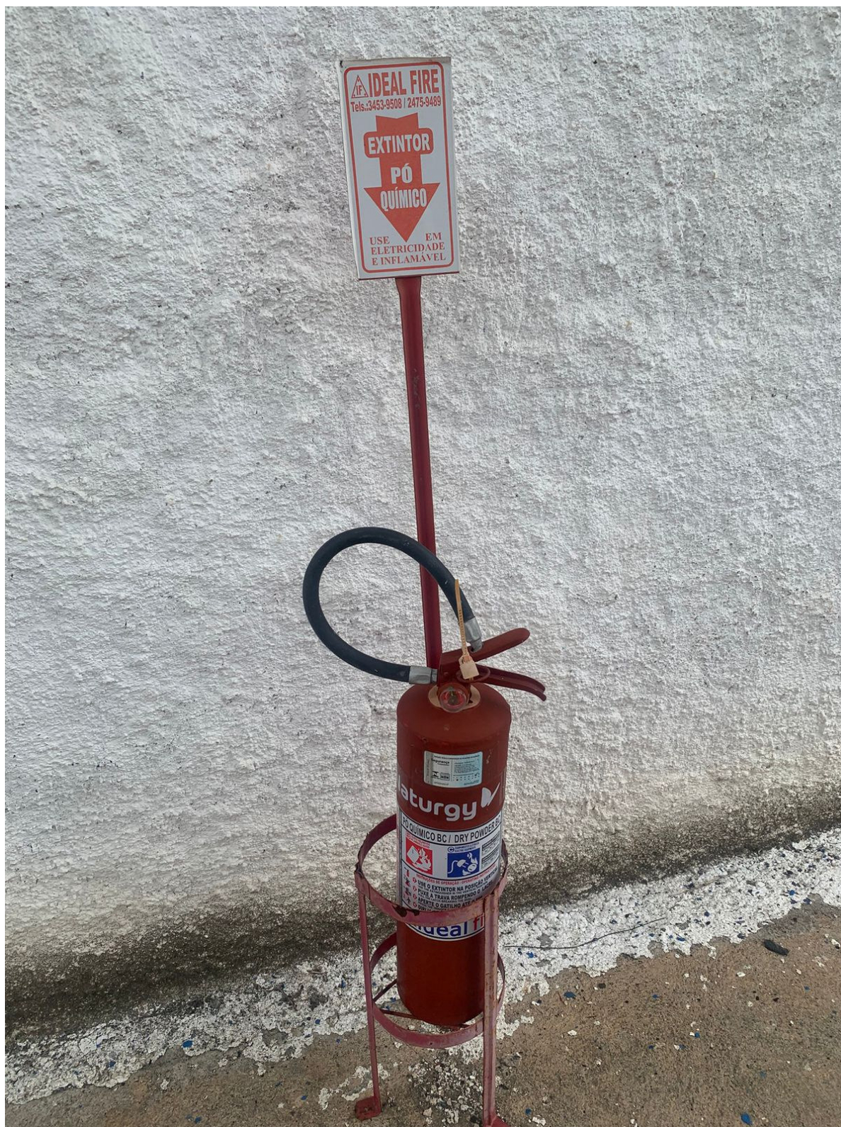
Foto 3: Extintor pó químico da estação.
