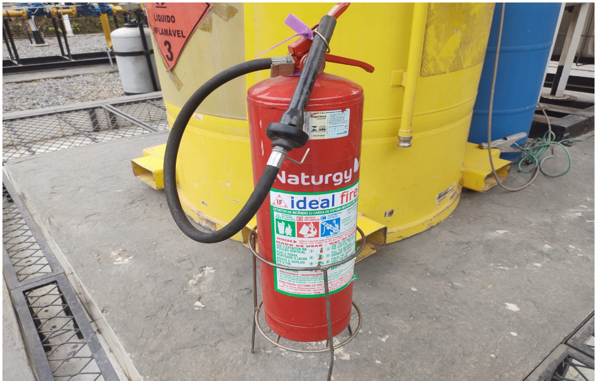
Foto 11: Extintor de espuma mecânica.
