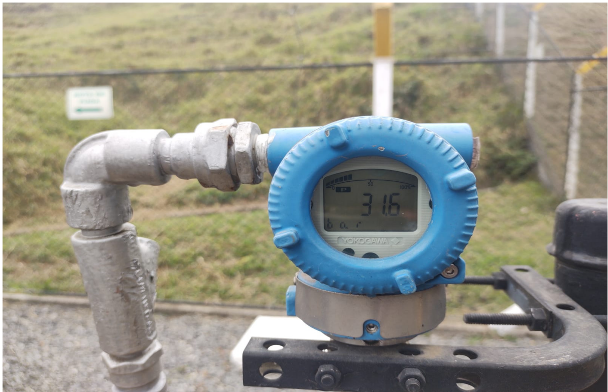
Foto 3: Manômetro localizado na estação ERM-D-R42.00-0021.
