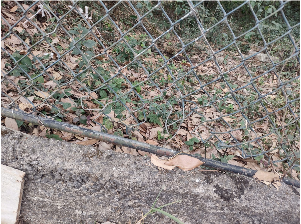
Foto 13: Buraco na cerca.
