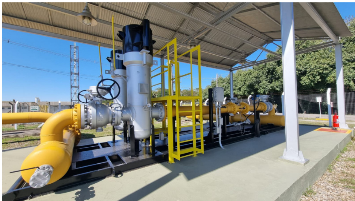
Foto 5: Estação de medição.
