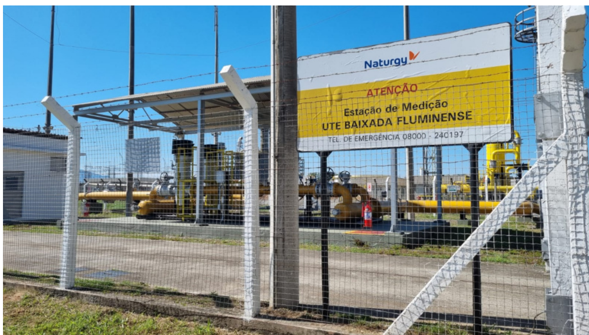
Foto 1: Placa de identificação da Estação de Medição UTE BAIXADA FLUMINENSE, no município de Seropédica/RJ.
