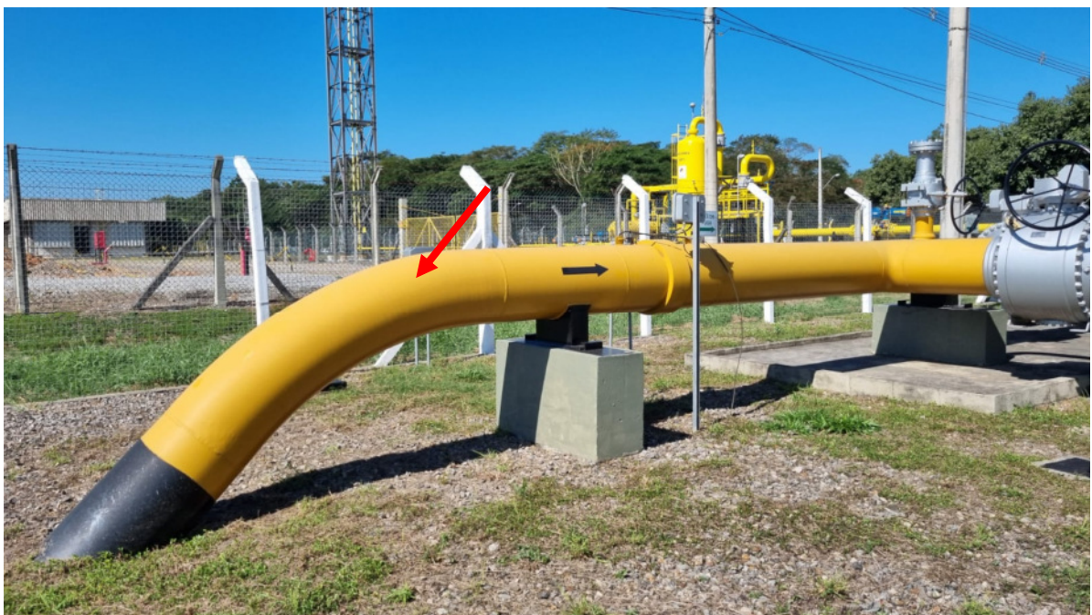
Foto 4: Linha de entrada de gás na estação (pressão de 40 bar em duto de aço de 20").
