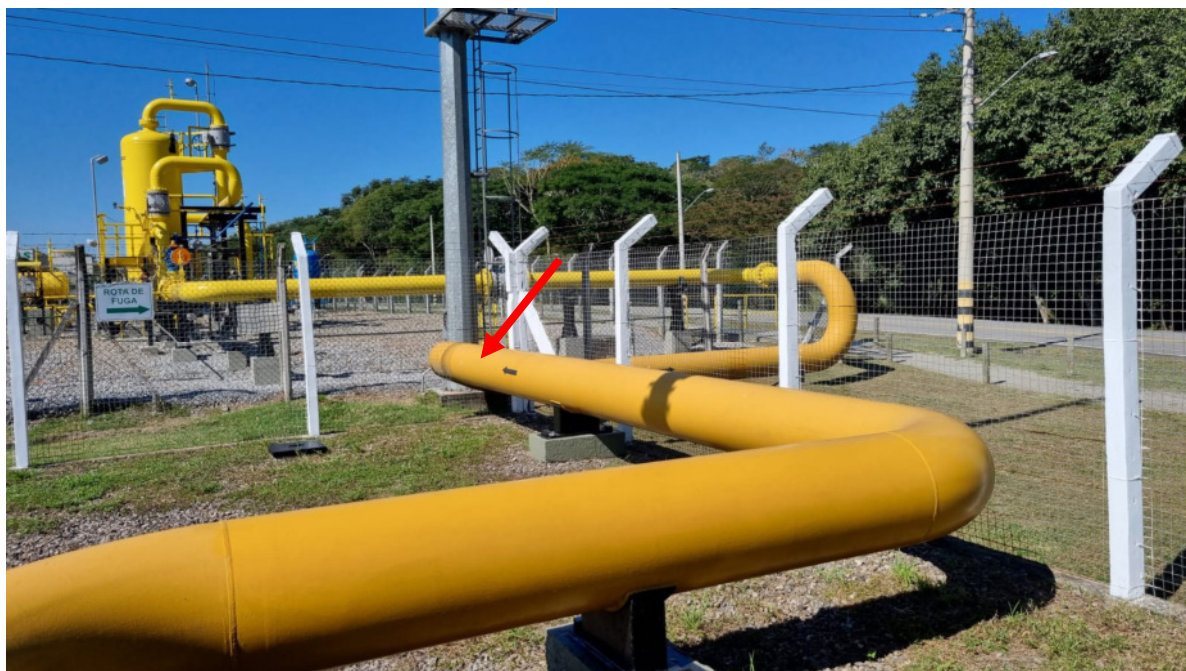
Foto 8: Linha de saída que segue para o abastecimento da UTE BAIXADA FLUMINENSE (pressão de 40 bar em duto de aço de 20").
