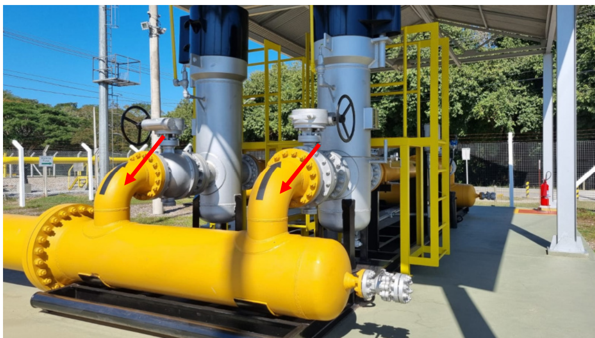
Foto 6: Linhas paralelas de medição de gás: uma fica em operação e a outra serve de back-up garantindo a redundância necessária para o funcionamento da estação.
