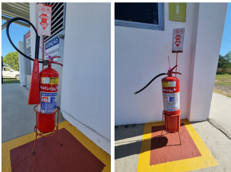
Foto 12: Extintores presentes na estação – os 2 (dois) foram verificados e estavam dentro da validade.
