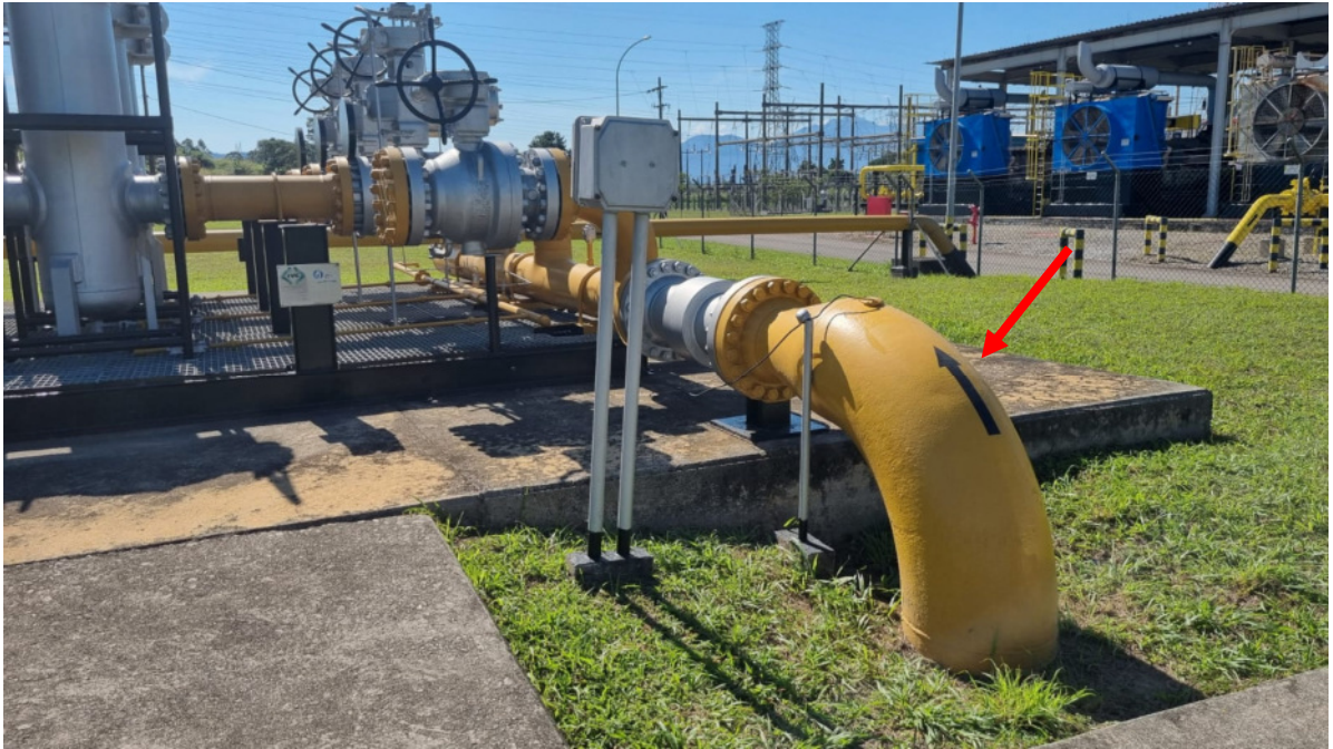
Foto 3: Linha de entrada de gás na estação (pressão de 40 bar em duto de aço de 20'').
