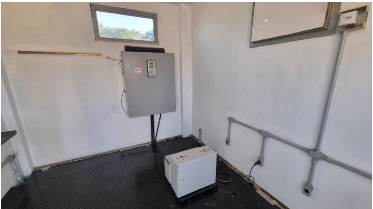
Foto 8: Centro de controle do sistema de telemetria e Nobreak.
