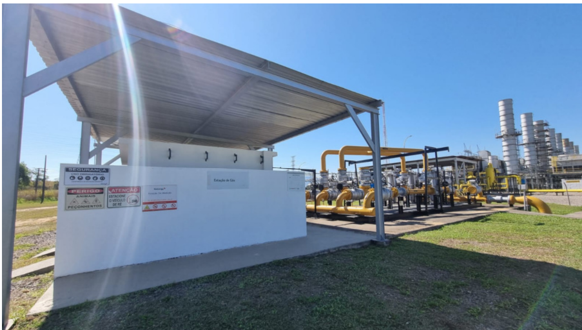
Foto 1: Estação de Medição - UTE ELETROBOLT (SEROPÉDICA), no município de Seropédica/RJ.
