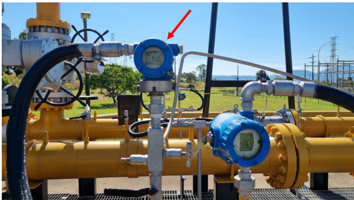
Foto 6: Medidor de pressão.
