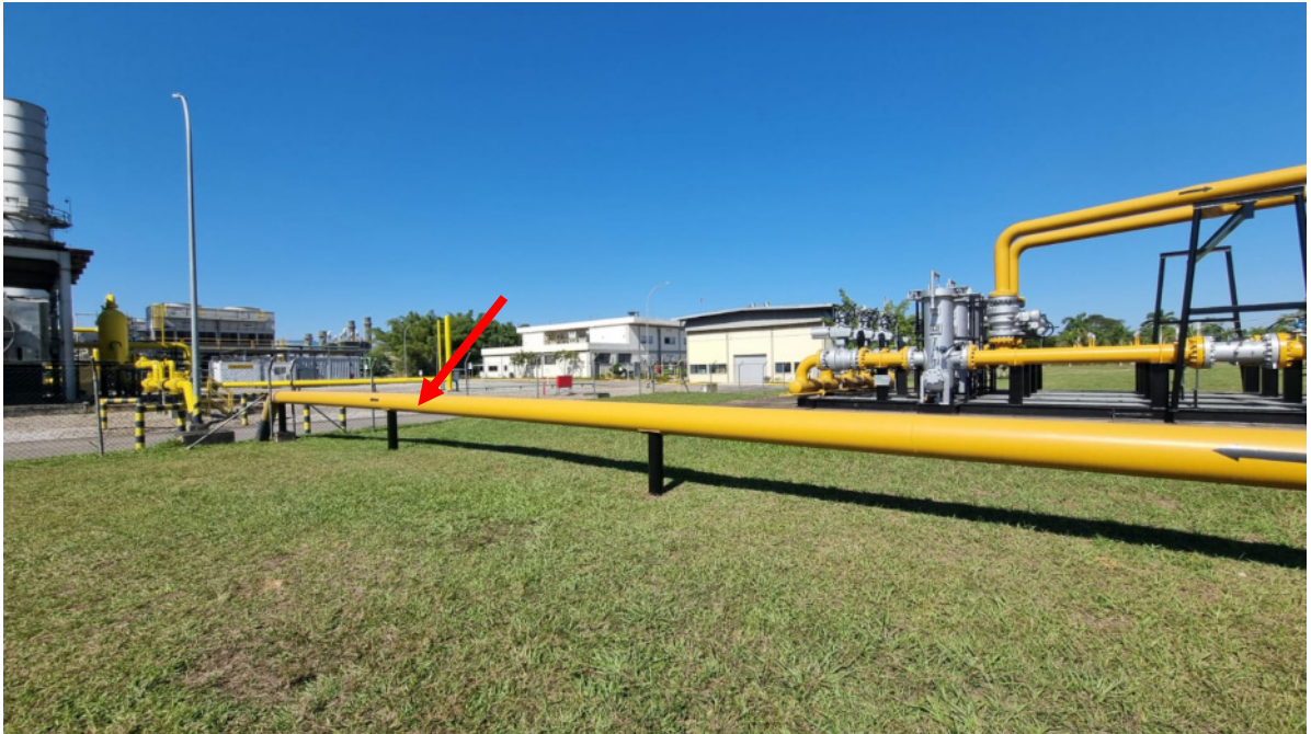
Foto 7: Linha de saída que segue para o abastecimento da UTE ELETROBOLT (SEROPÉDICA) (pressão de 40 bar em duto de aço de 20").
