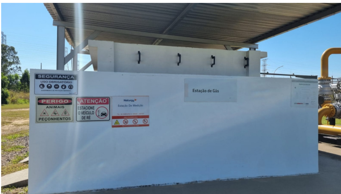
Foto 2: Placas de identificação e de sinalização de segurança da estação.
