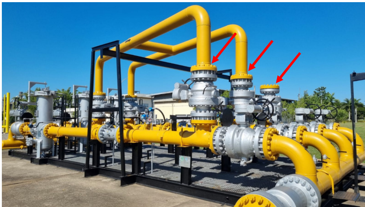
Foto 5: Linhas paralelas de medição de gás: uma fica em operação e as outras duas servem de back-up garantindo a redundância necessária para o funcionamento da estação.
