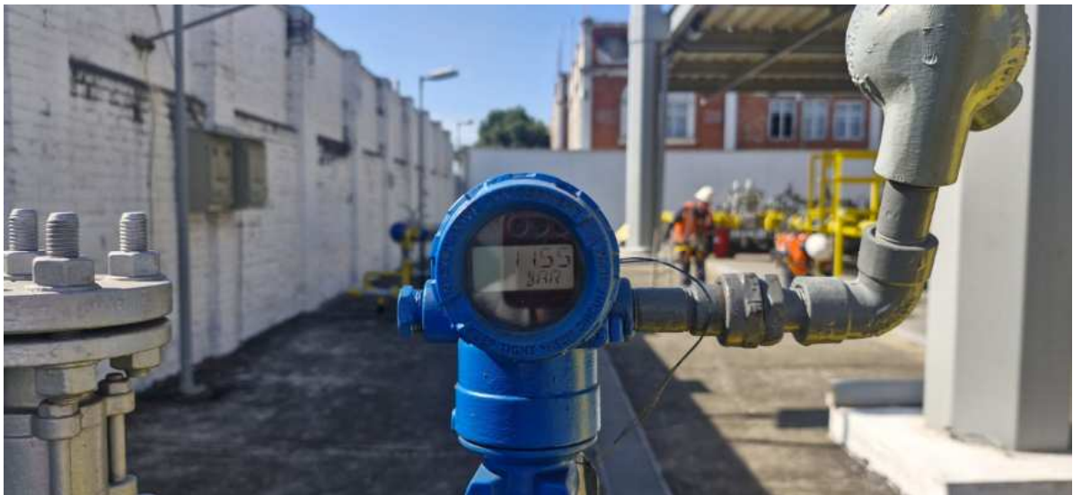
Foto 4: Pressão de entrada de aproximadamente 12 bar.
