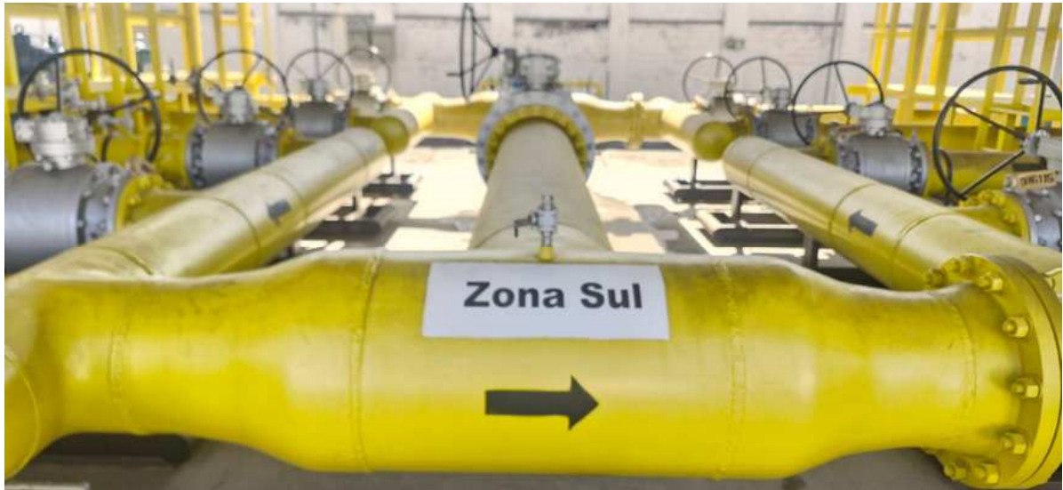
Foto 7: Três linhas que alimentam a zona sul.
