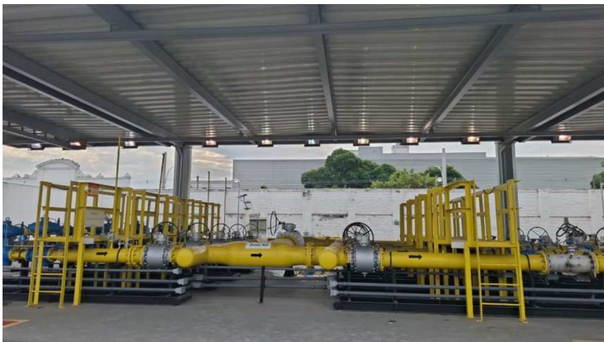
Foto 14: Lâmpadas em total funcionamento.
