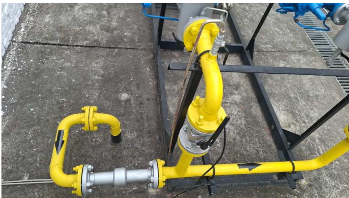
Foto 12: Linha de fluxo na Estação São Cristóvão.
