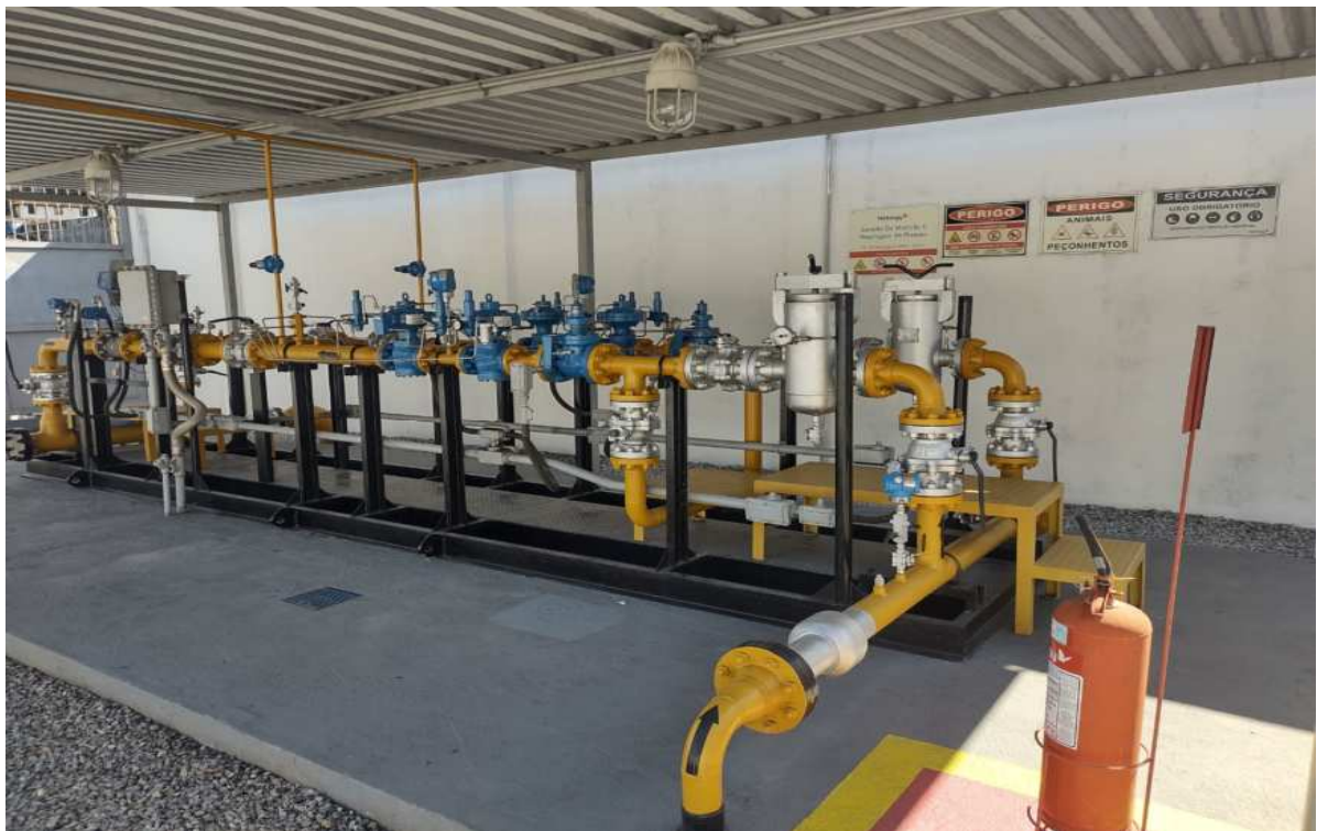
Foto 2: Estação de Regulação e Medição.
