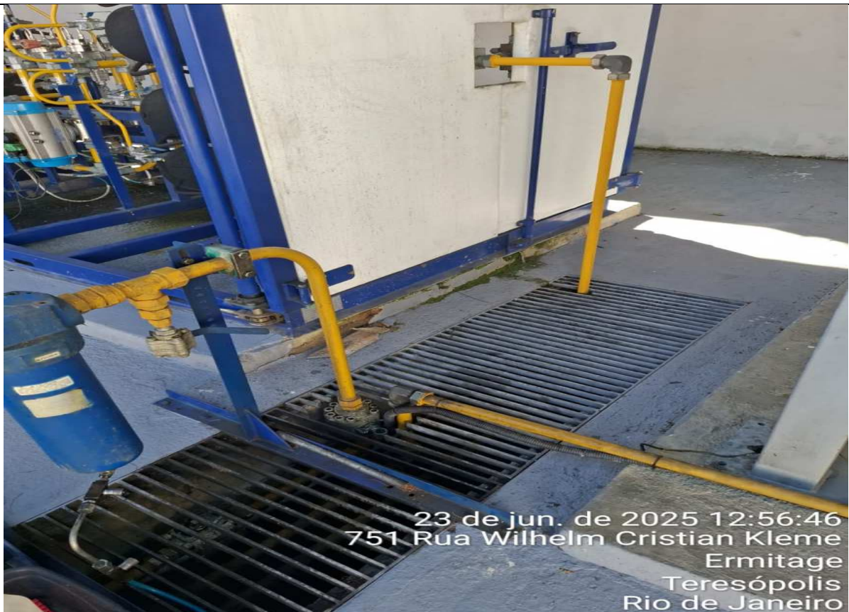
Foto 12: Borda do piso que sustenta RCU cedendo.
