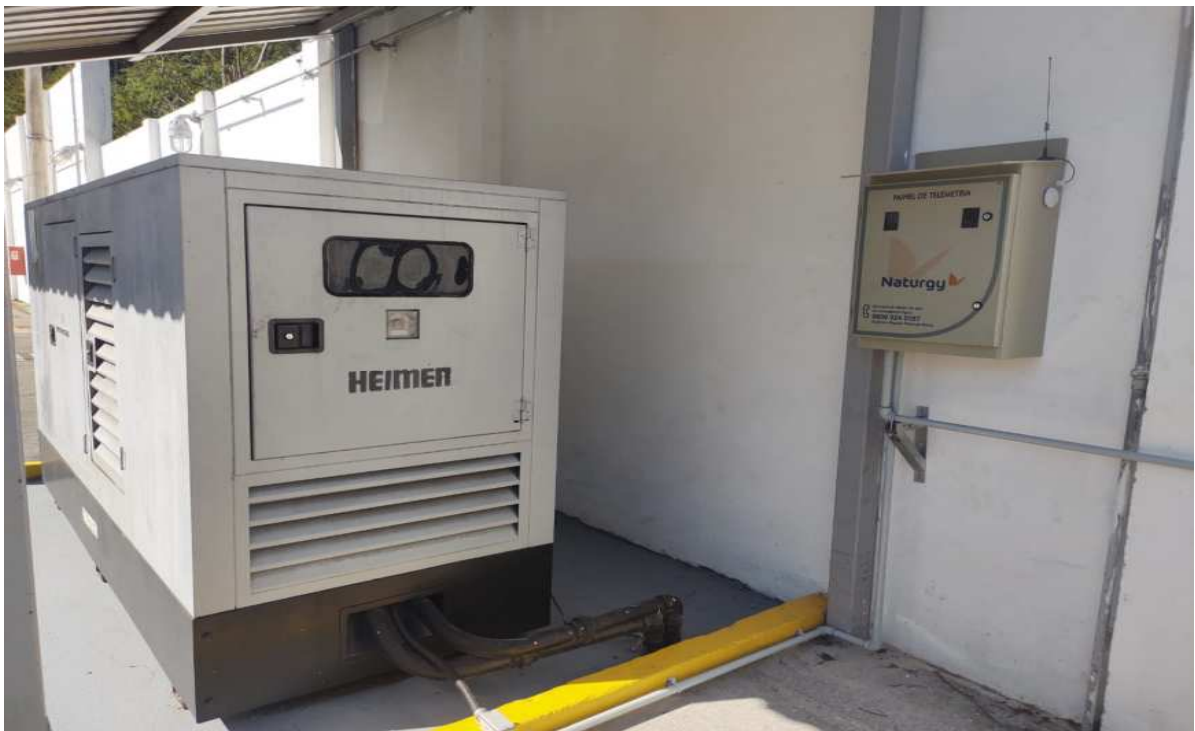
Foto 8: Gerador a diesel com sistema de telemetria.
