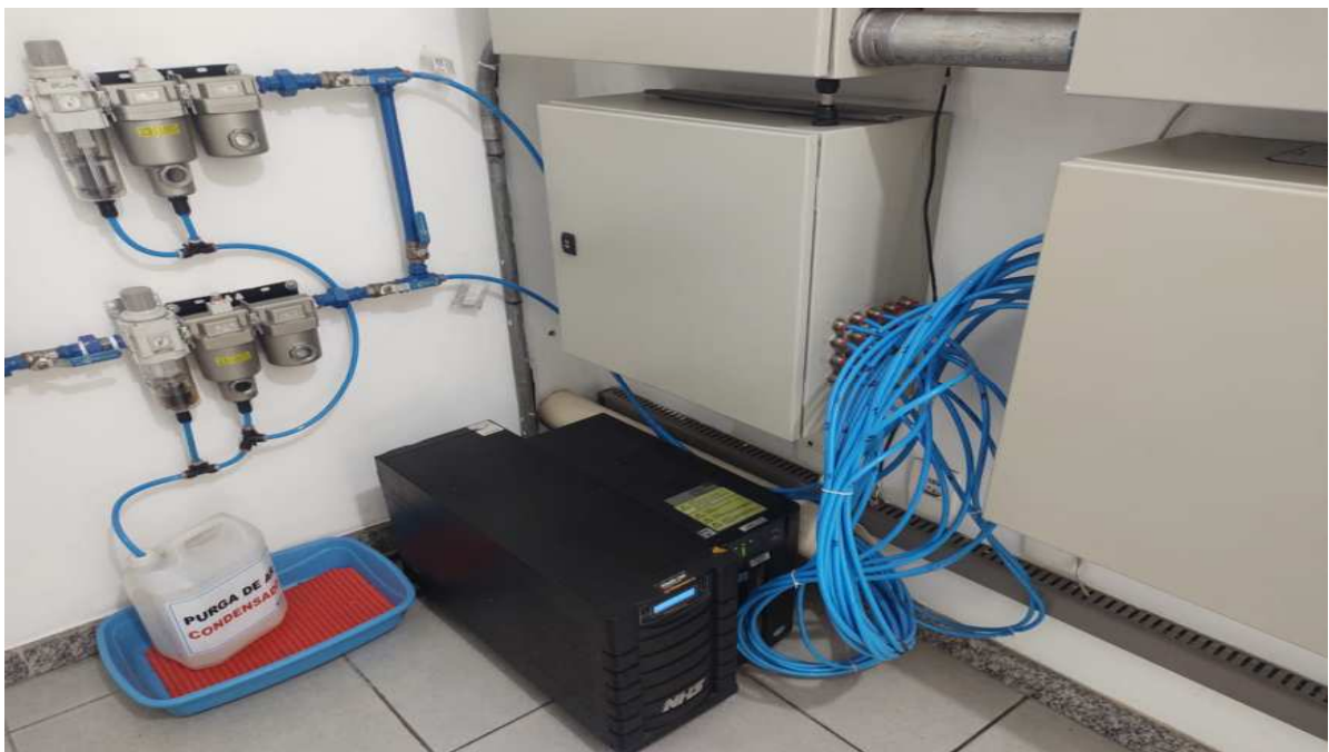
Foto 10: Sistema de válvulas a ar comprimido das RCUs.
