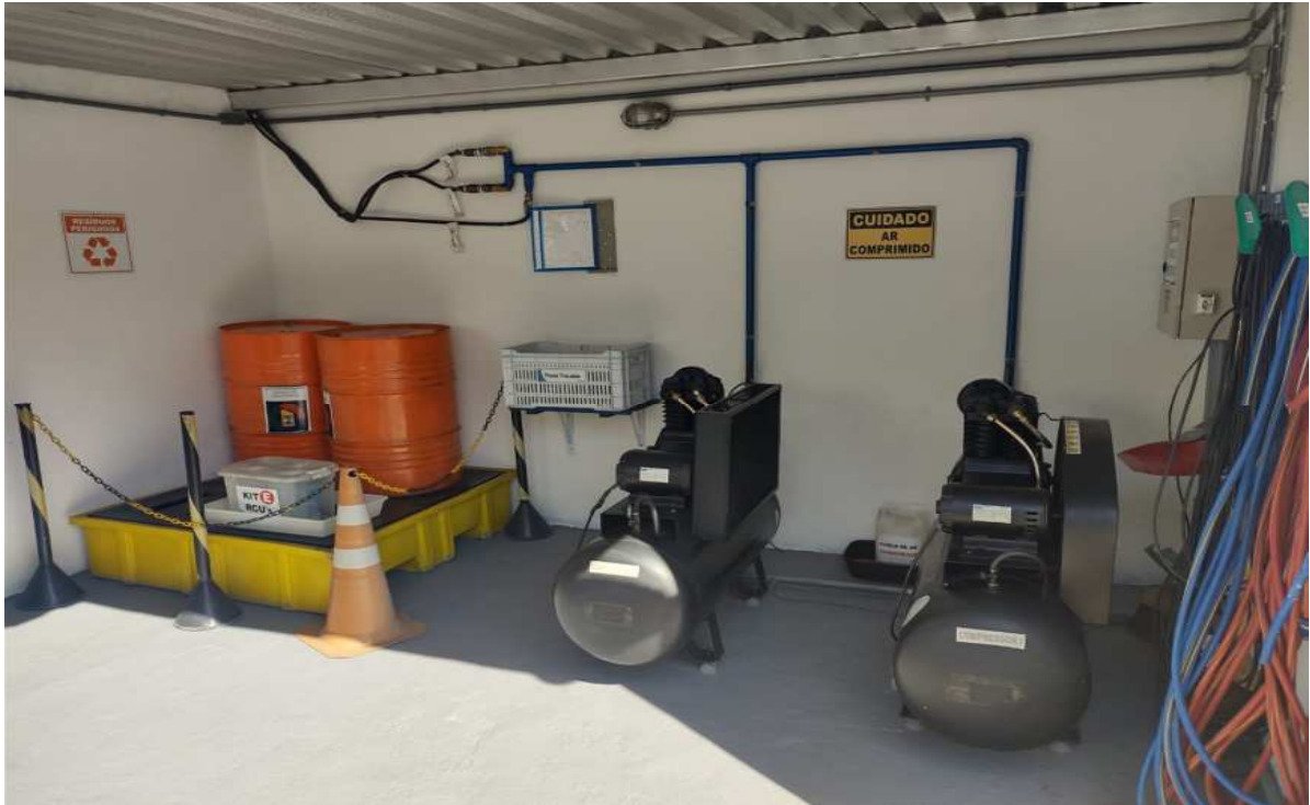
Foto 7: Estação de ar comprimido com dois compressores.
