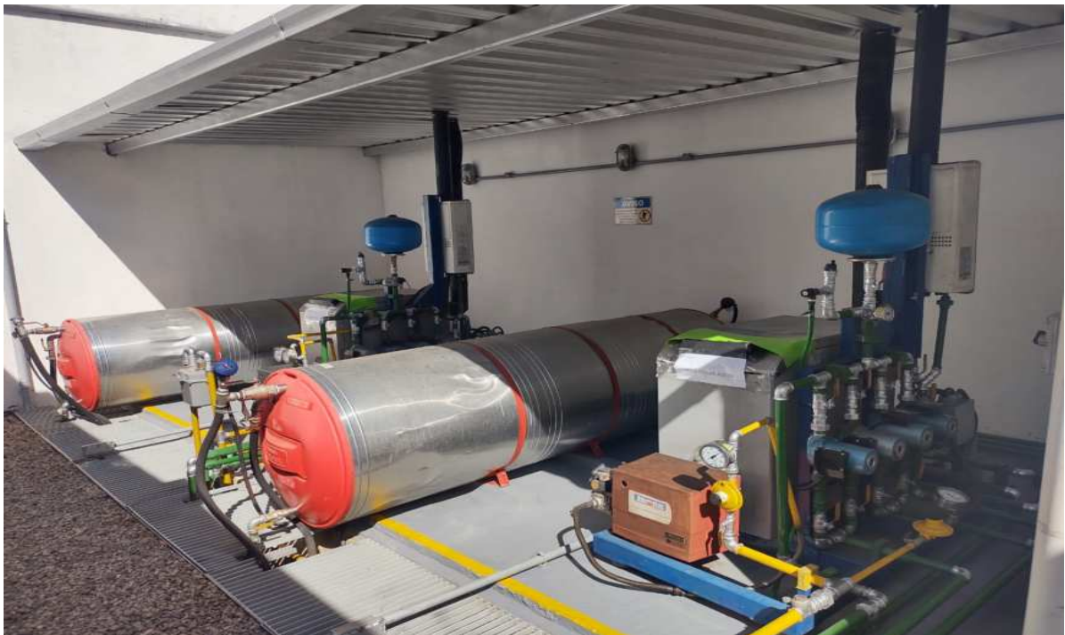
Foto 6: Sistema de aquecimento de gás e reservatórios de água.
