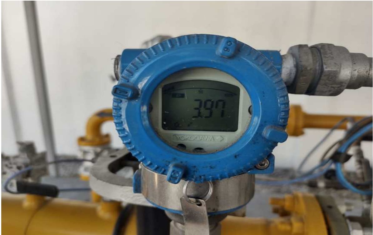
Foto 5: Manômetro na saída para a rede de distribuição.
