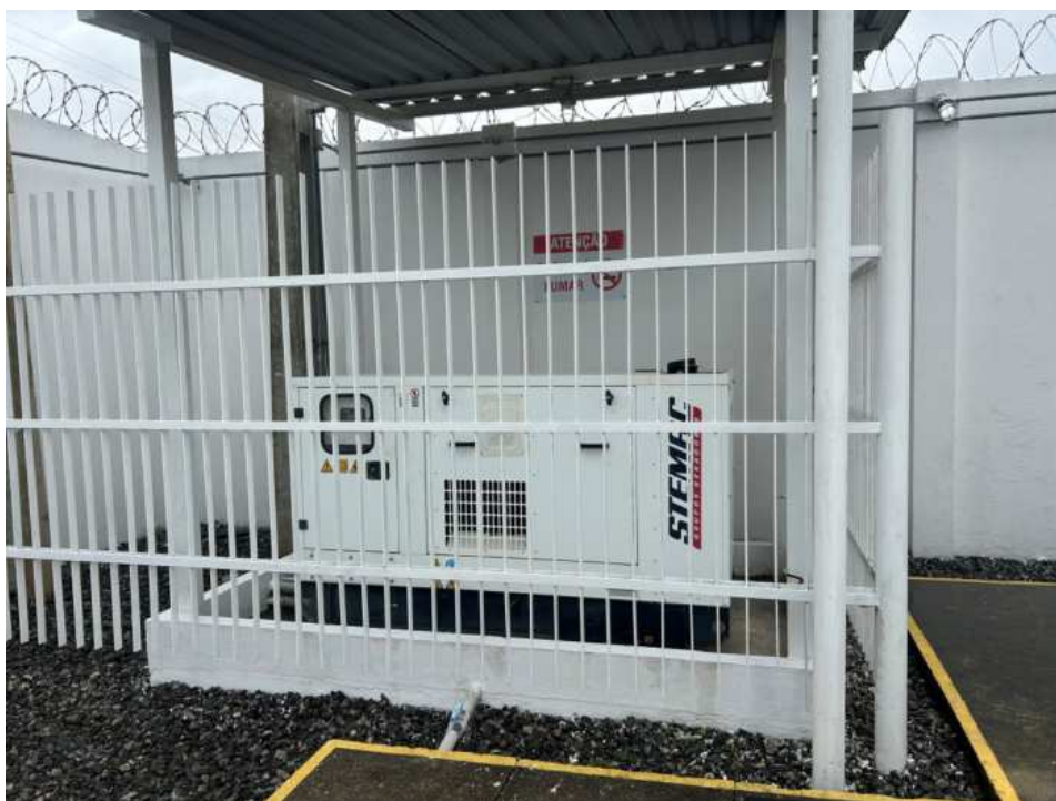
Foto 7: Gerador elétrico de emergência.
