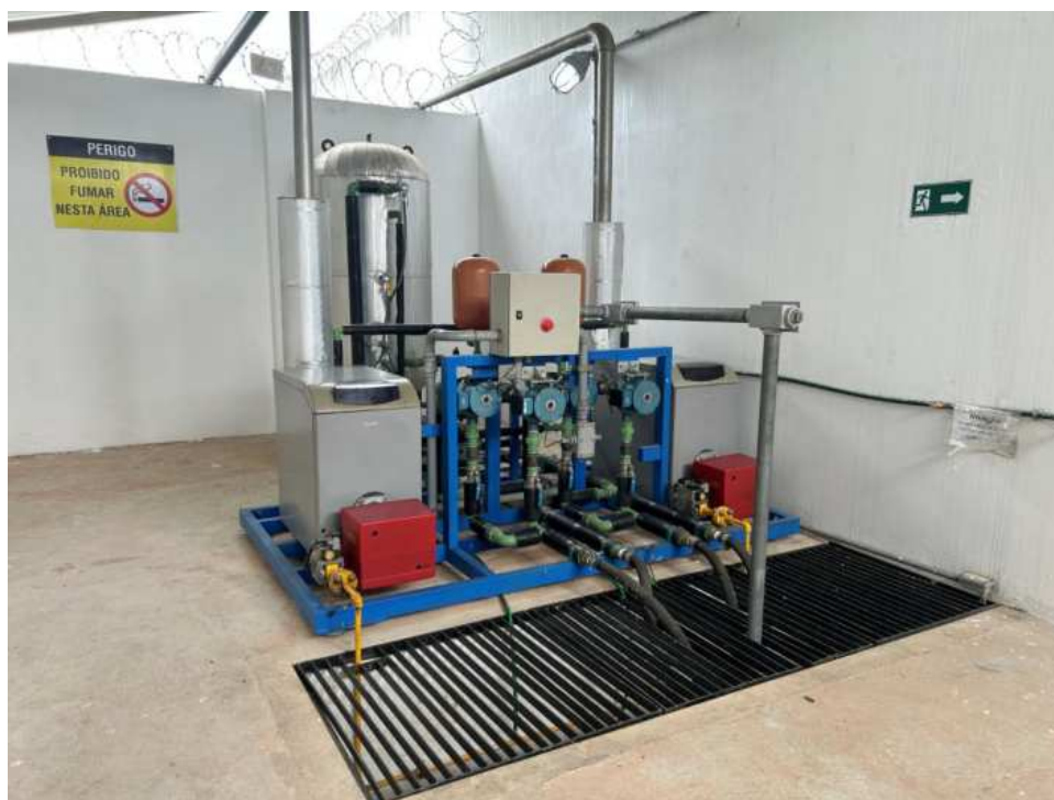
Foto 6: Sistema de aquecimento de água.
