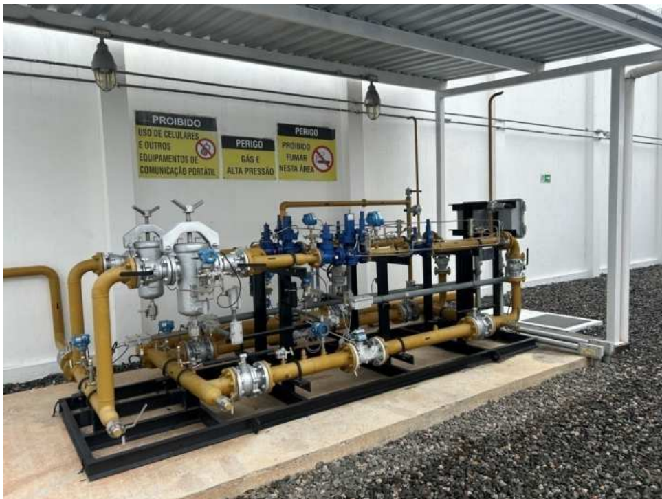
Foto 4: Vista geral da estação da ERM.
