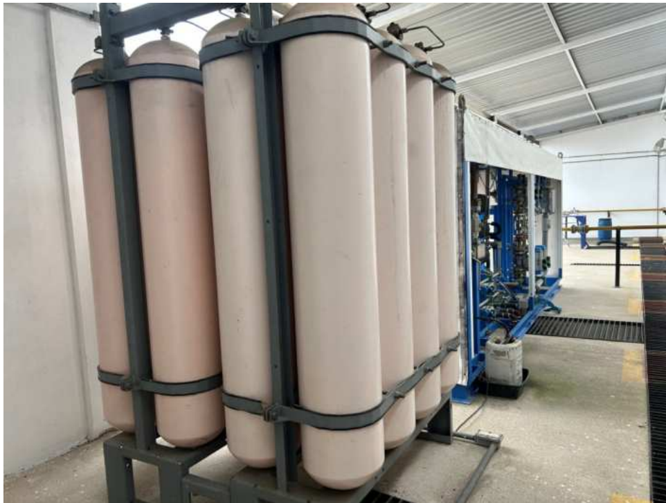
Foto 11: Sistema de estocagem com 16 cilindros.
