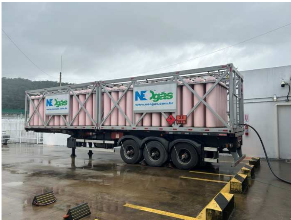
Foto 10: Carreta da NEOgás com cilindros em processo de descompressão.
