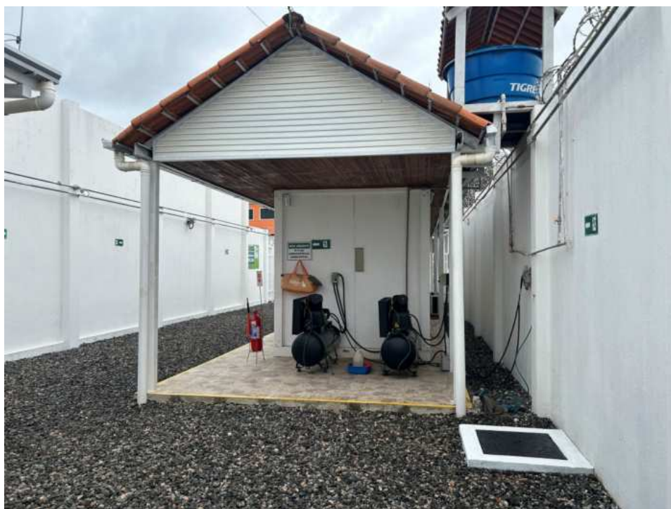
Foto 5: Sistema de ar comprimido para acionamento das válvulas da RCU.
