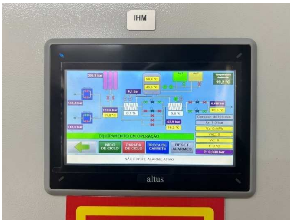
Foto 12: Painel de controle para monitoração da operação.
