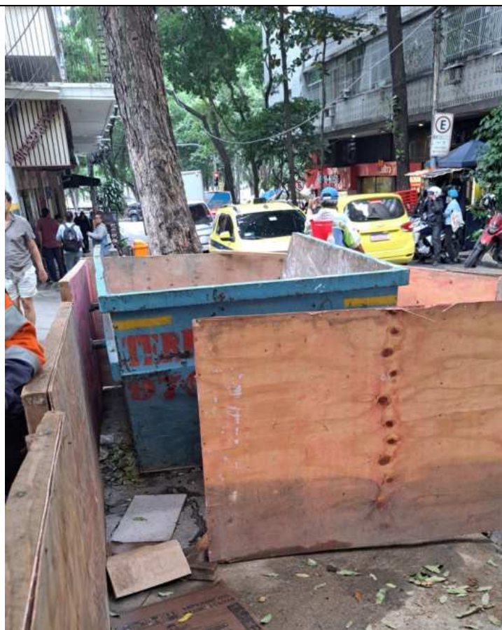
Foto 4: Área de descarte de entulho
