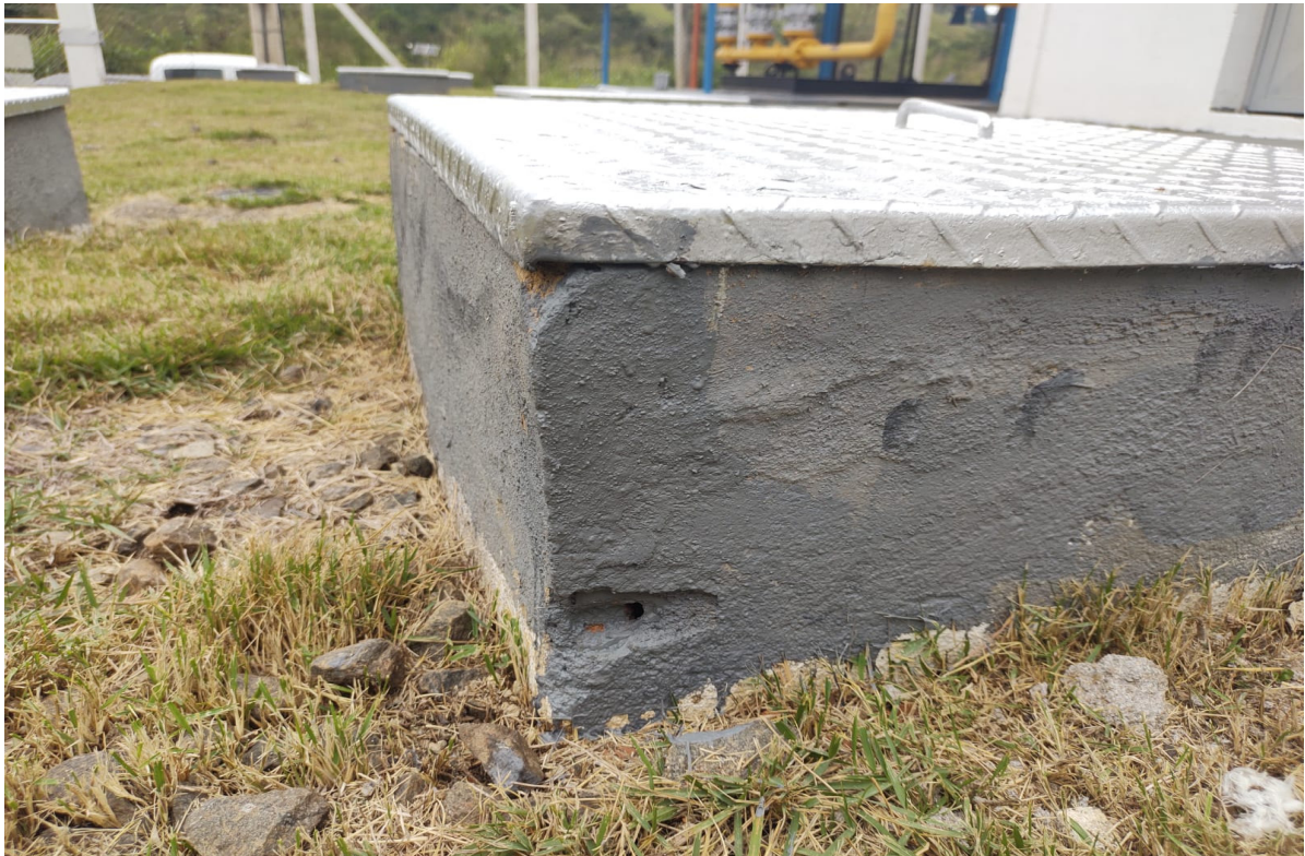
Foto 11: Furo na alvenaria da caixa de passagem.
