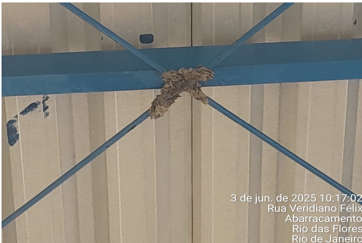
Foto 17: Resto de casa de marimbondo no telhado.
