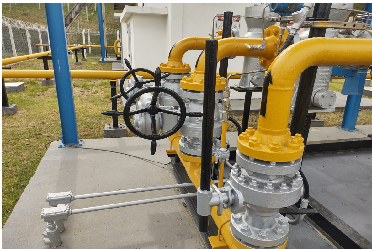
Foto 6: Válvulas de bloqueio, primeiro corte.
