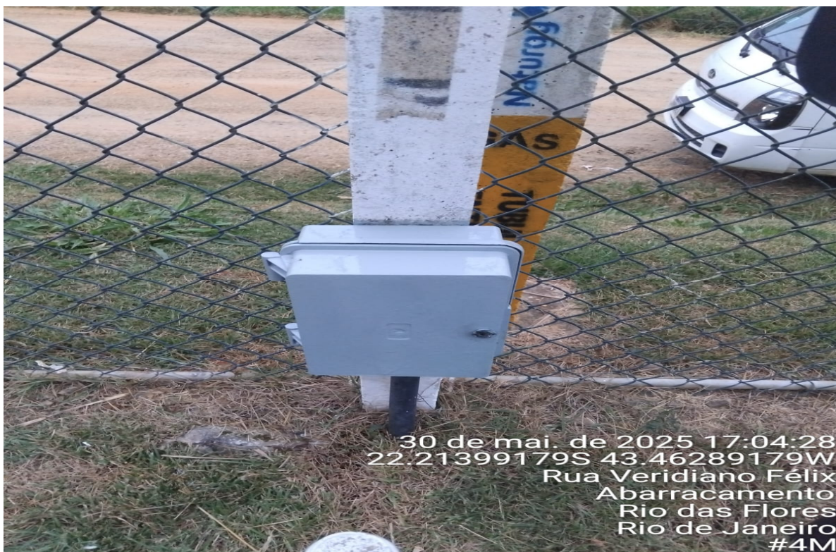
Foto 14: Troca da caixa do equipamento de proteção catódica.
