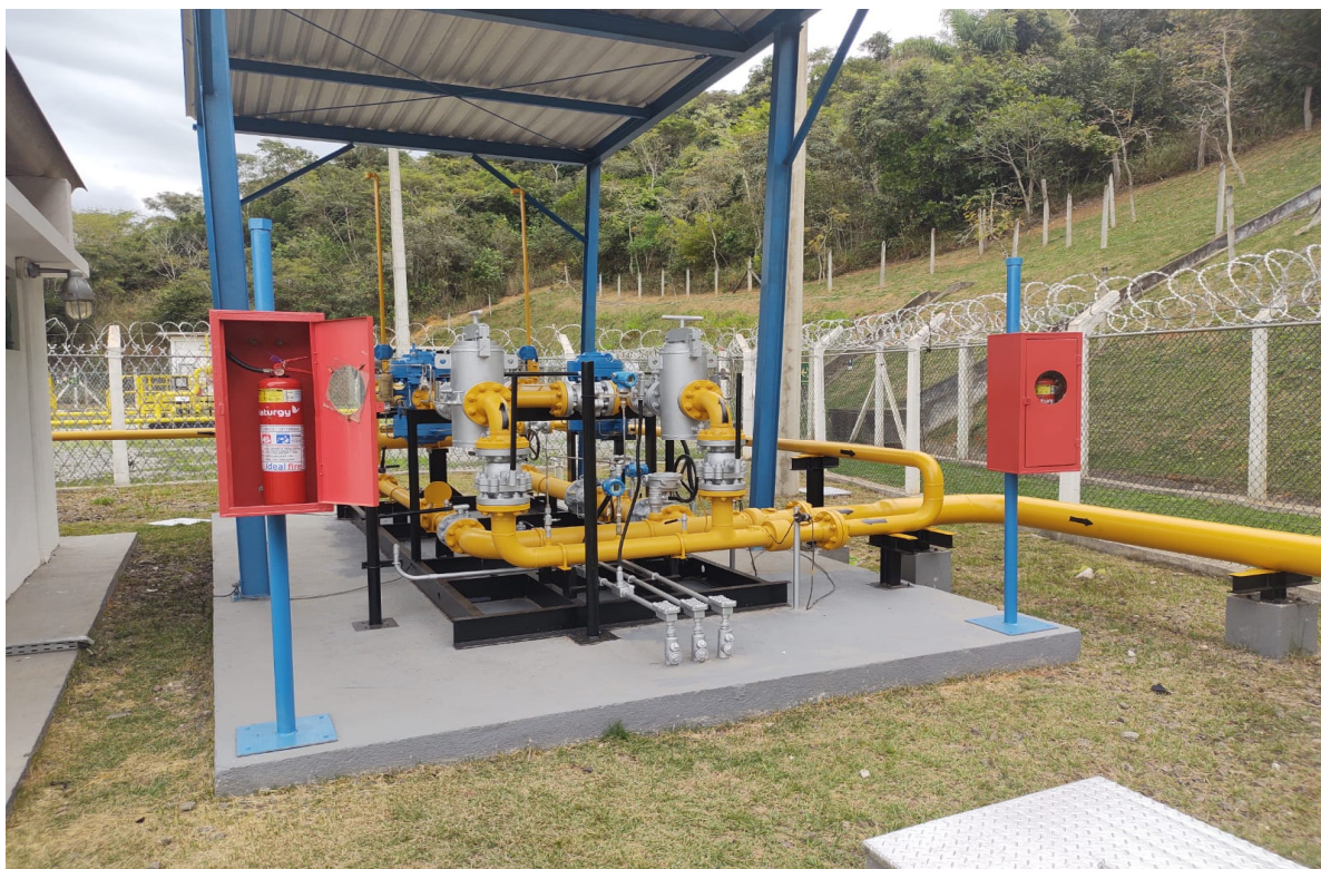
Foto 5: Estação de redução de pressão, segundo corte.
