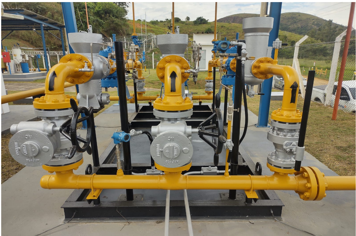
Foto 4: Estação de redução de pressão, primeiro corte.
