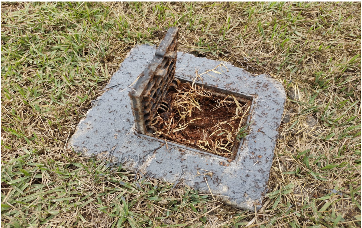
Foto 10: Formigueiro na caixa de passagem.
