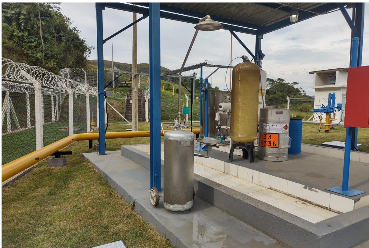
Foto 7: Sistema de odorização, chuveiro, lava olhos e iluminação.
