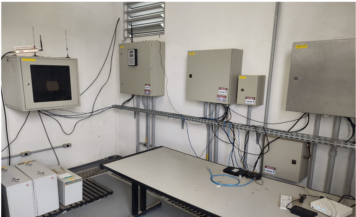
Foto 16: Sistema de telemetria.
