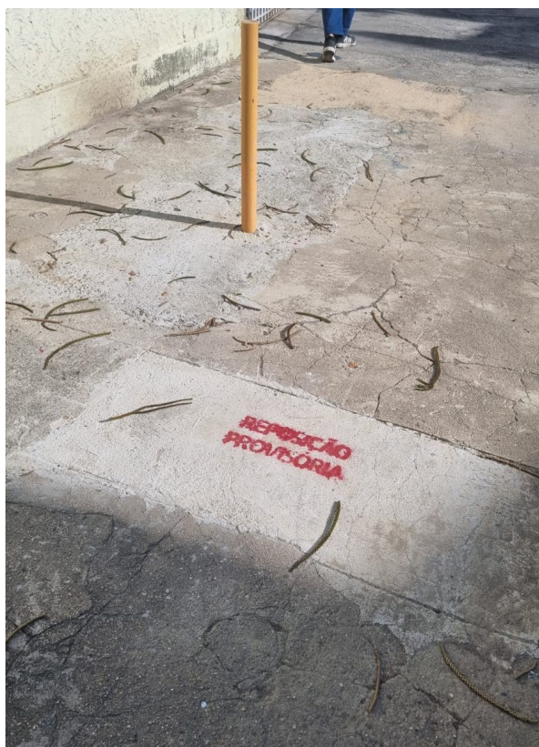
Foto 5: Trecho de recomposição provisória no passeio.
