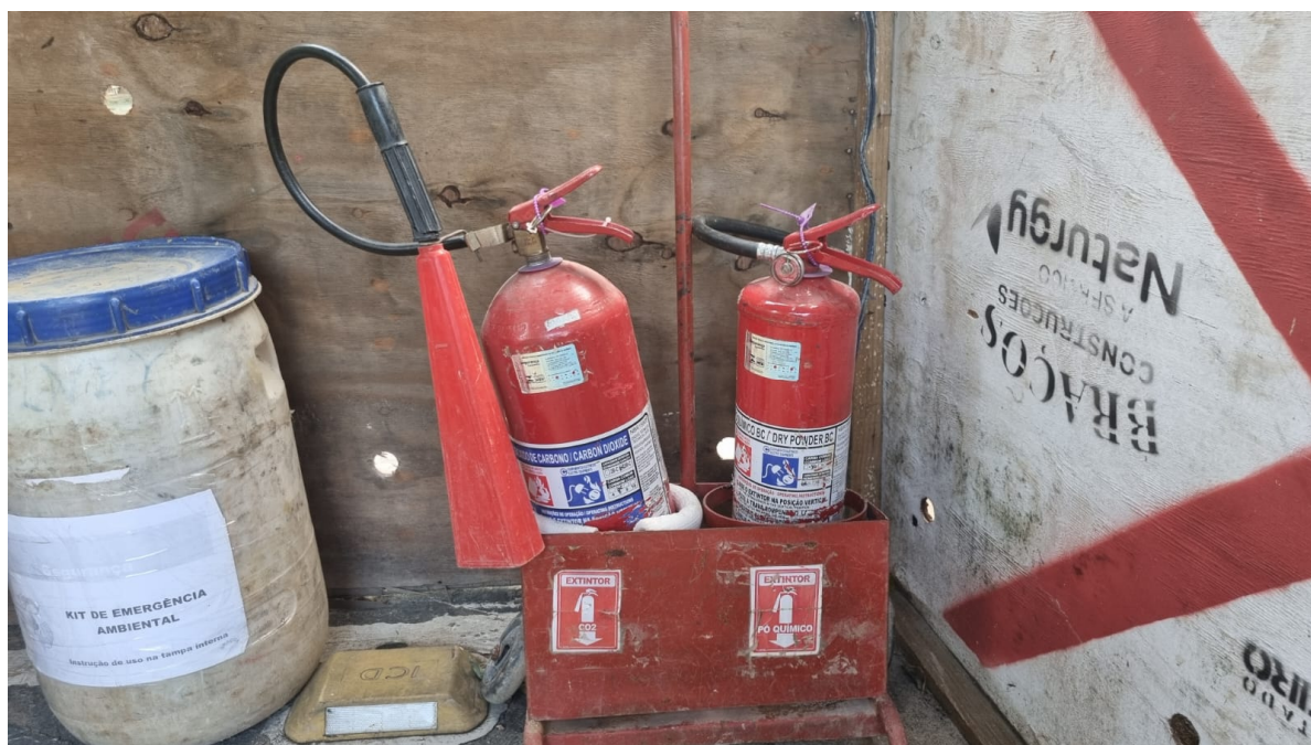
Foto 14: Extintores de incêndio dentro do local de vivência.
