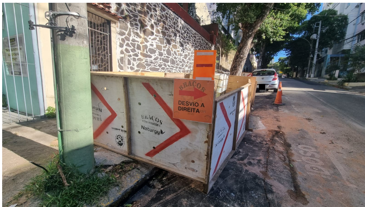
Foto 11: Placa de desvio de trânsito e sinalização noturna.
