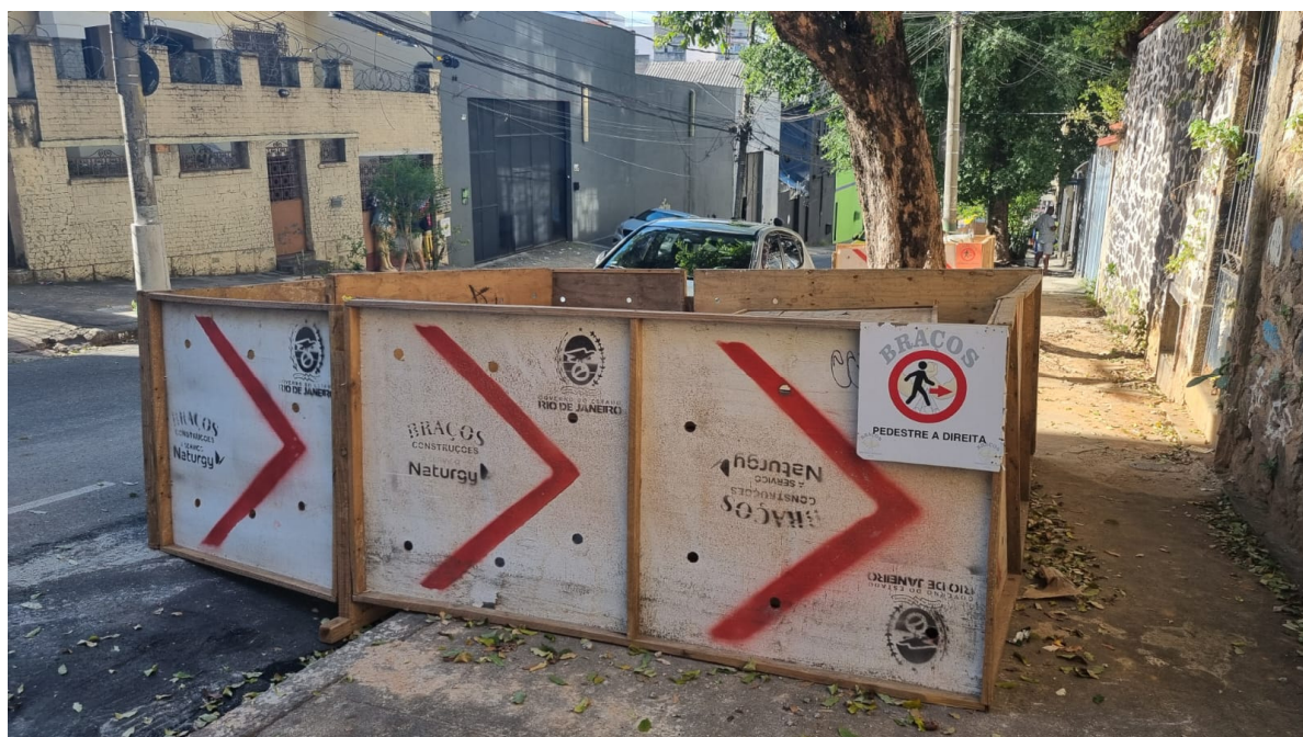
Foto 12: Placa de desvio de pedestre.
