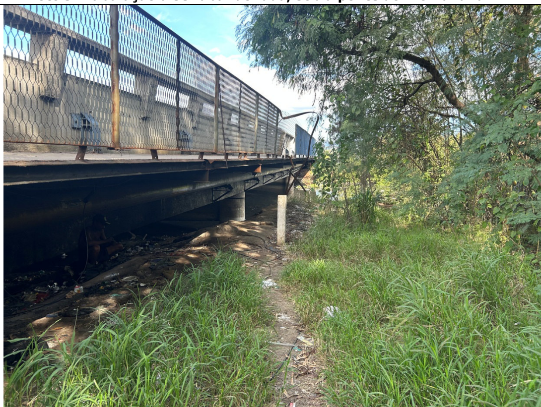
Foto 10: Tubulação a ser abandonada, sob a ponte do Rio Pavuna.
