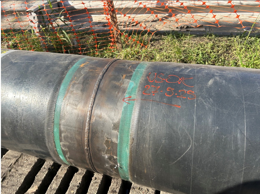
Foto 7: Ponto de solda entre dois segmentos da tubulação.
