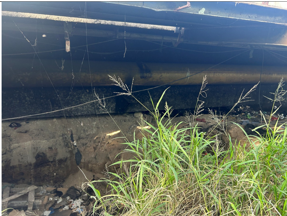
Foto 9: Tubulação a ser abandonada, sob a ponte do Rio Pavuna.
