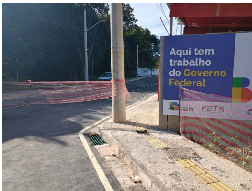
Foto 4: ponto de interligação para abastecimento do novo condomínio.
