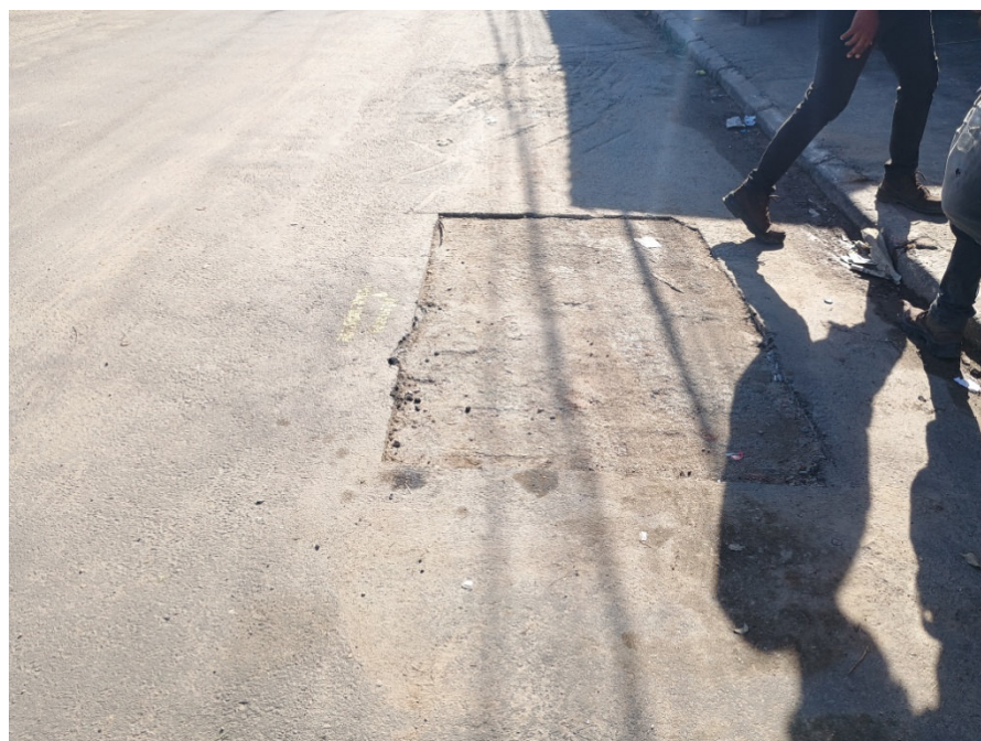
Foto 8: trecho com recomposição provisória identificada.
