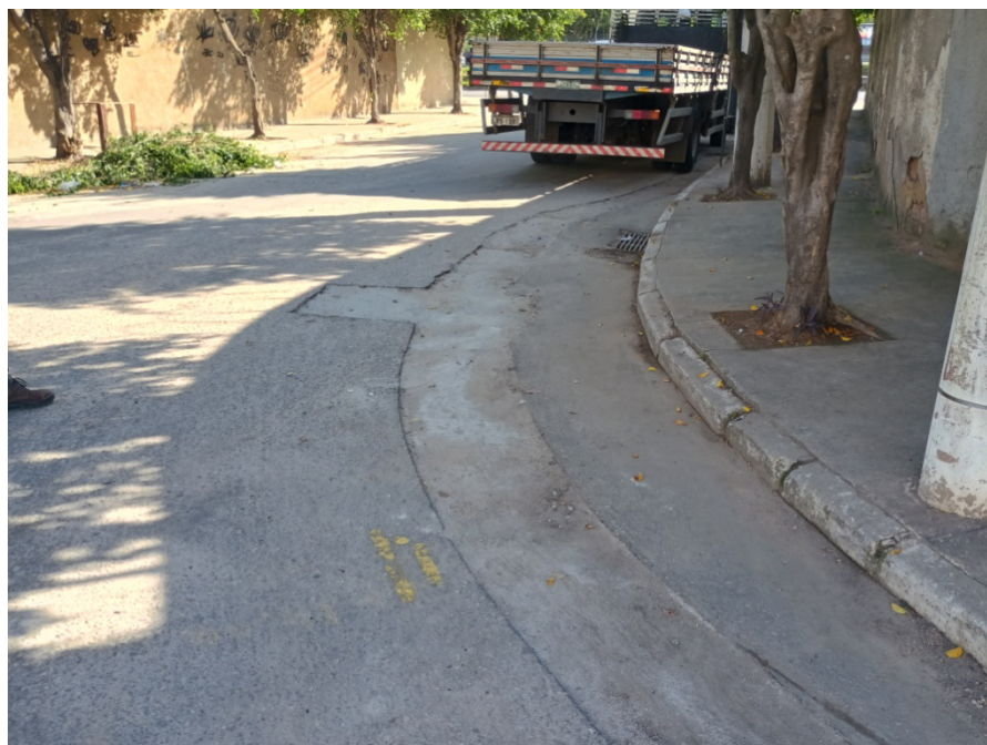
Foto 7: trecho com recomposição provisória identificada.
