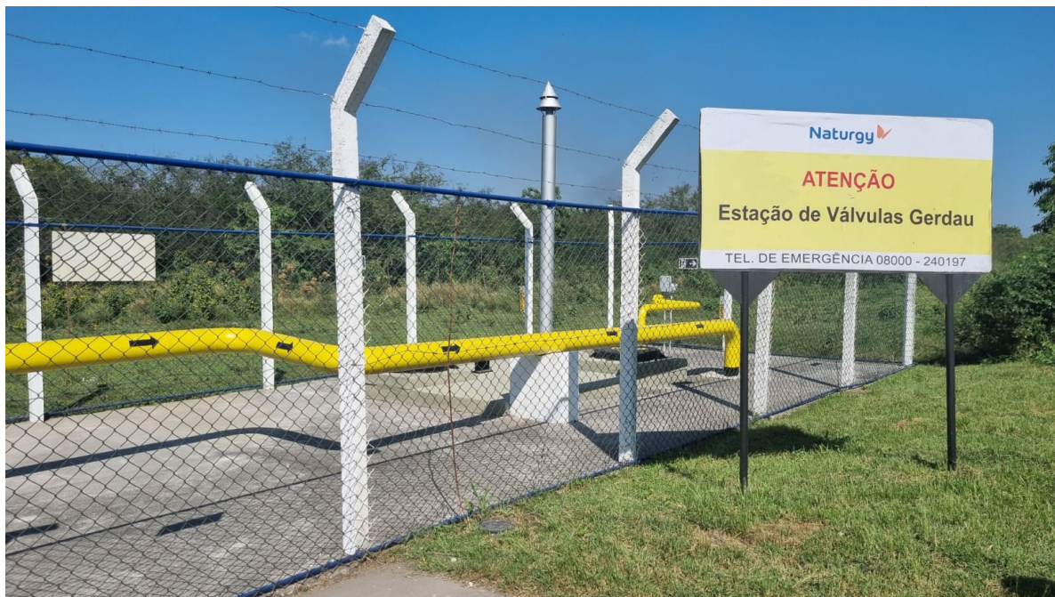
Foto 1: Placa de identificação da Estação de Válvulas GERDAU no bairro de Santa Cruz, Rio de Janeiro/RJ.
