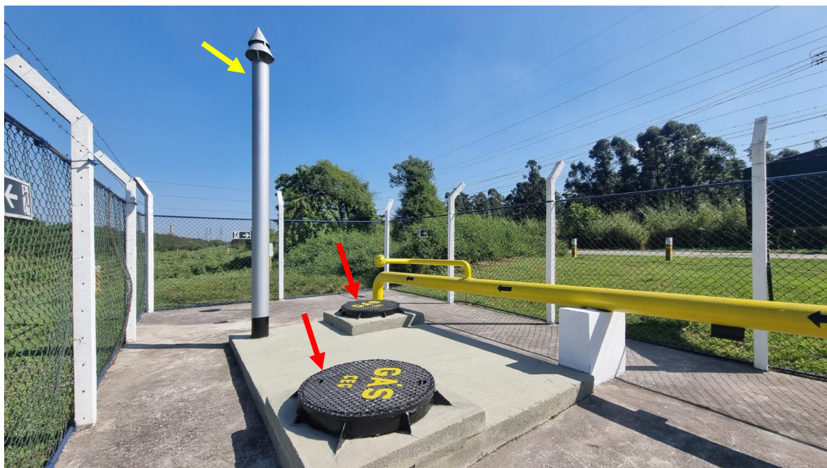
Foto 6: Válvulas de acesso ao duto subterrâneo que segue para a Estação FURNAS (setas vermelhas) e exaustor do duto subterrâneo (seta amarela).
