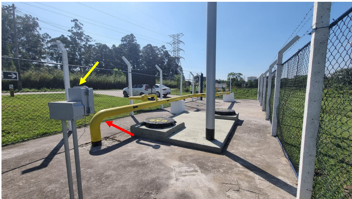
Foto 5: Linha de saída (pressão de 40 bar em duto de aço de 8") (seta vermelha) que segue para a Estação FURNAS de Lançamento de PIG 8" e sistema de proteção catódica da estação (seta amarela).
