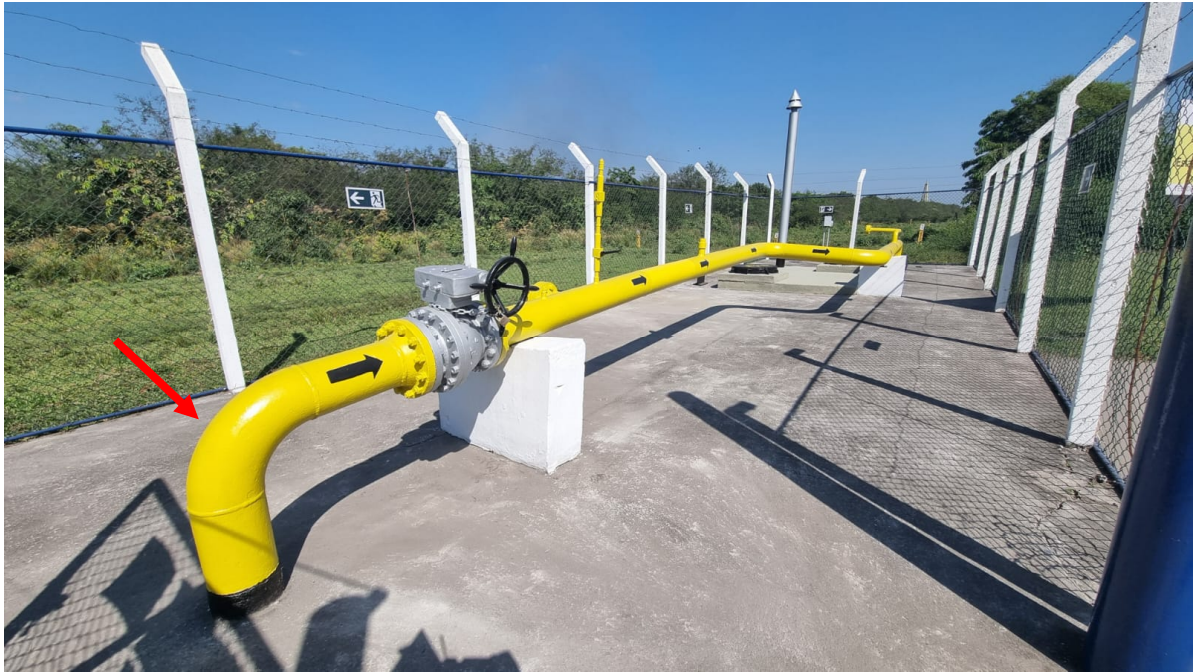
Foto 3: Linha de entrada (pressão de 40 bar em duto de aço de 8").
