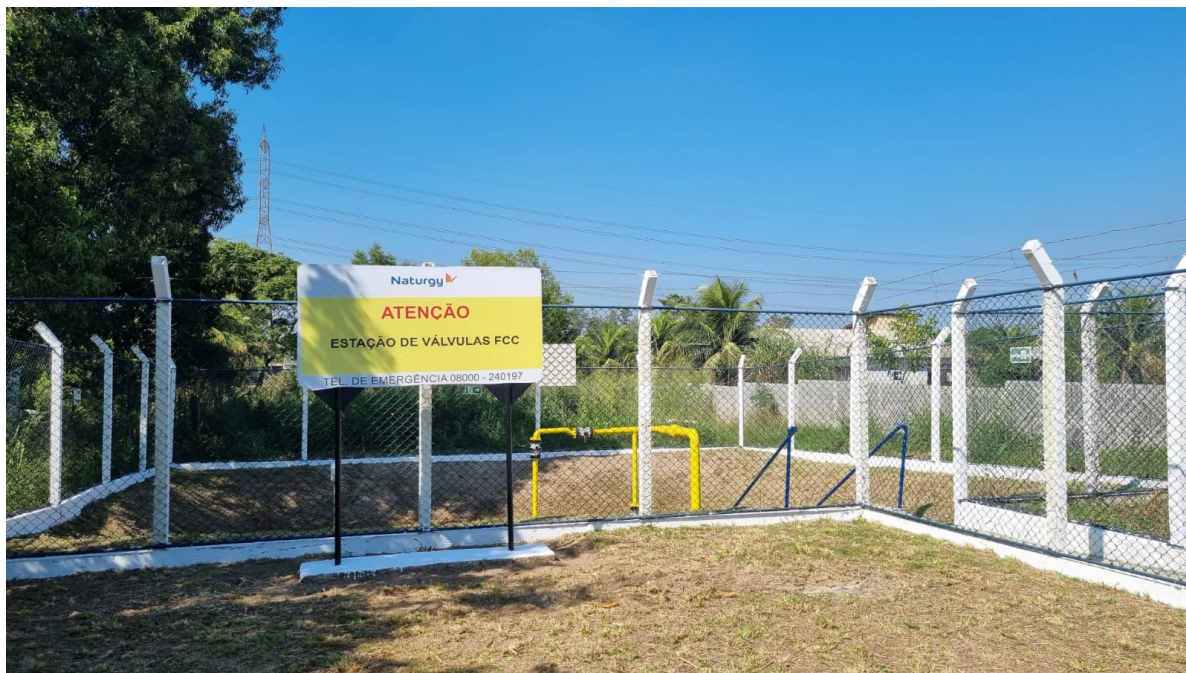
Foto 1: Vista frontal da Estação de Válvulas FCC em Santa Cruz, Rio de Janeiro/RJ.
