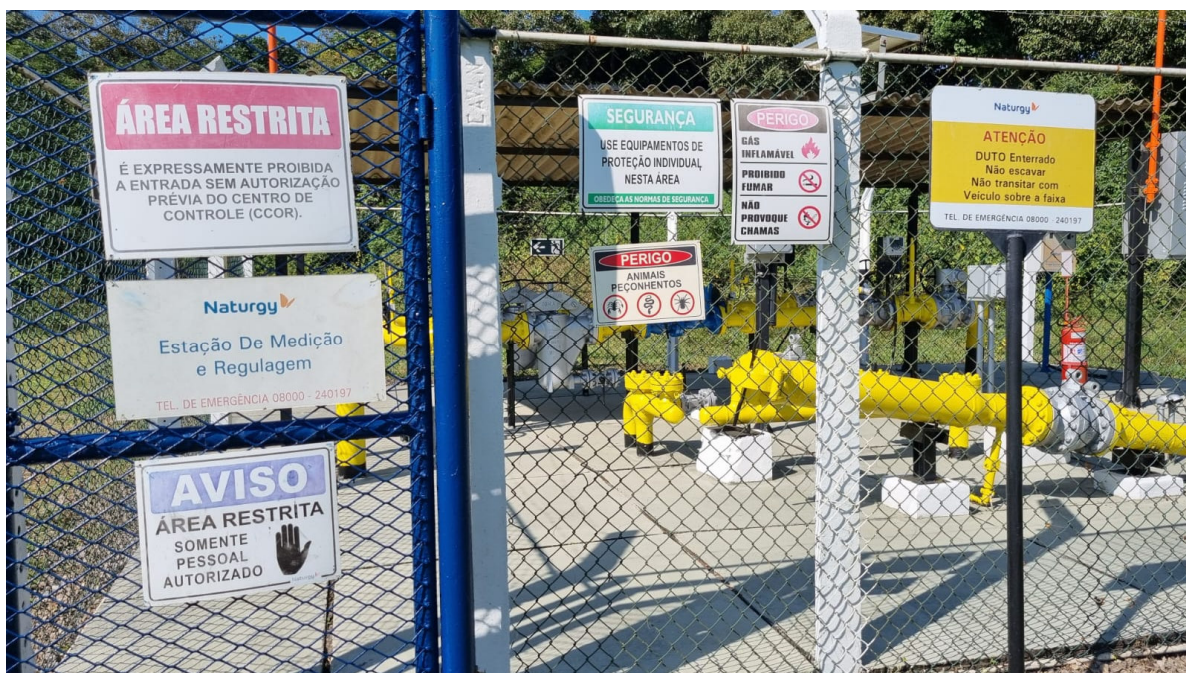
Foto 10: Placas da sinalização de segurança da estação.
