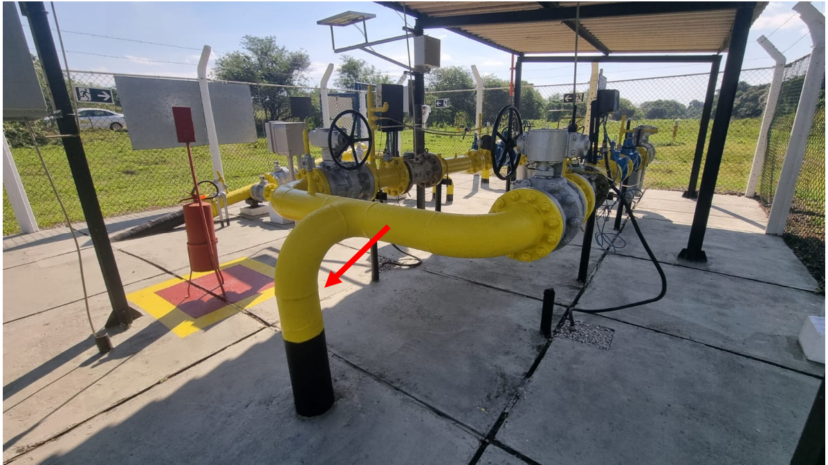
Foto 7: Linha de saída (pressão de 26 bar em duto de aço de 8").
