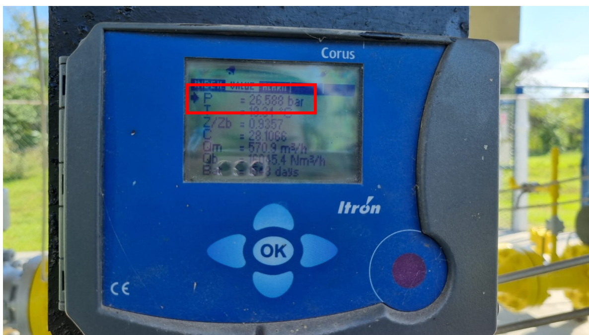
Foto 6: Pressão de saída – o gás entra na estação a uma pressão de 40 bar e, posteriormente, tem sua pressão reduzida para 26 bar através das válvulas de regulação.
