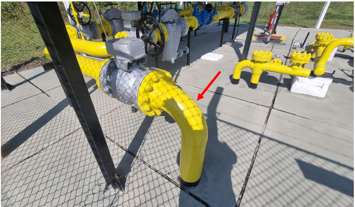
Foto 4: Linha de entrada (pressão de 40 bar em duto de aço de 8").
