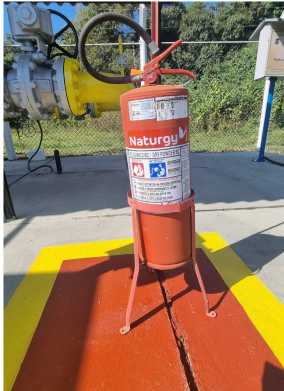
Foto 13: Extintor tipo pó químico.
