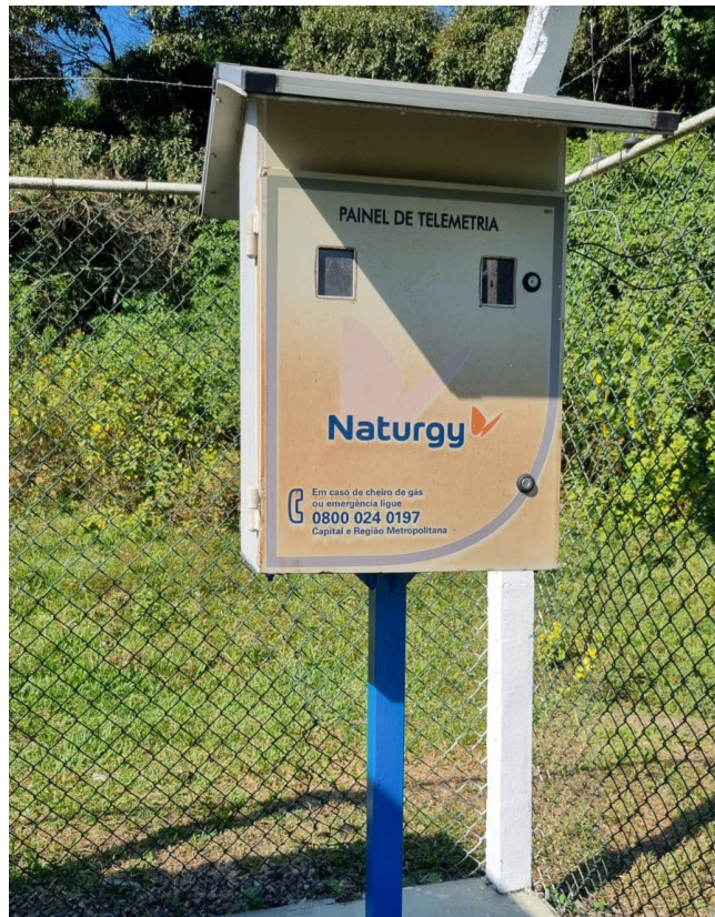
Foto 8: Pannel de telemetria da estação.
