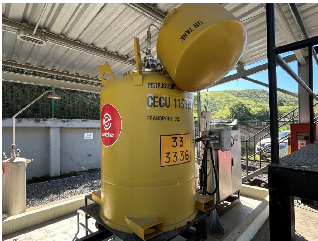
Foto 7: Tanque de armazenamento de odorante.
