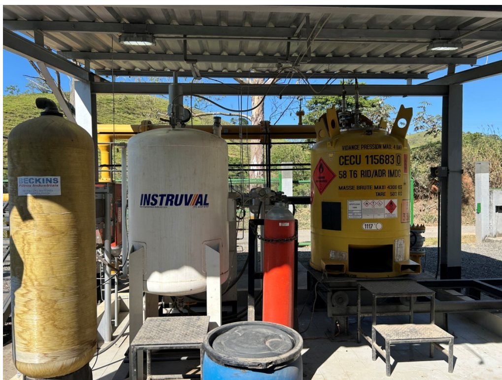
Foto 8: Sistema de odorização.
