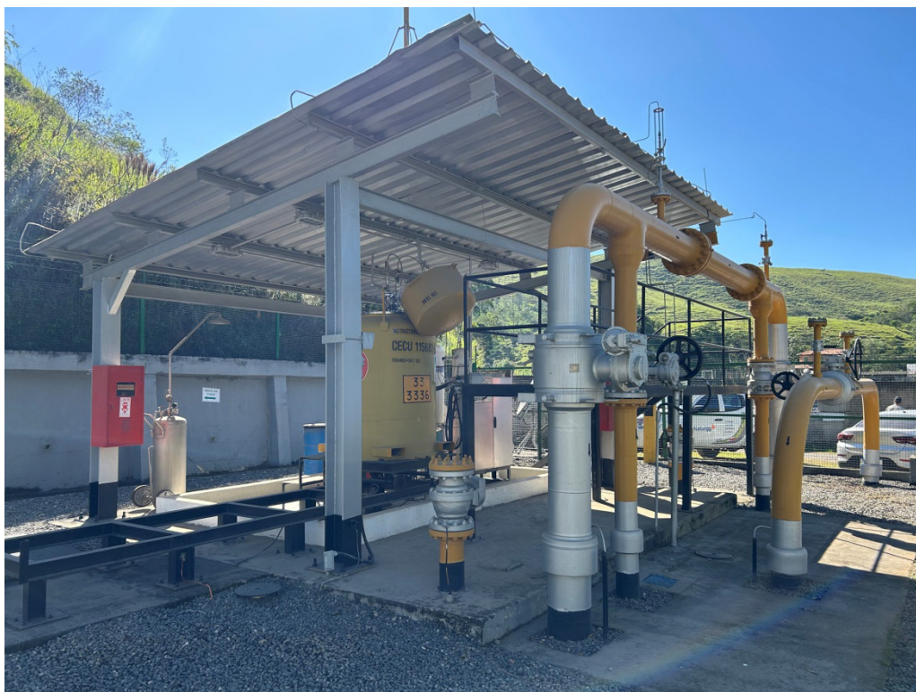
Foto 4: Visão geral da estação.
