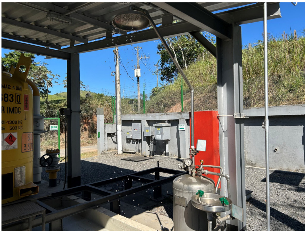
Foto 9: Chuveiro e lava-olhos da estação.
