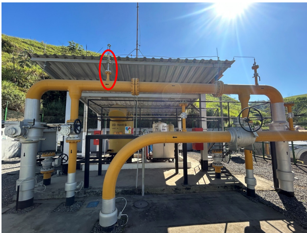
Foto 5: Sistema de injeção de odorante na linha de saída do gás (acima).
