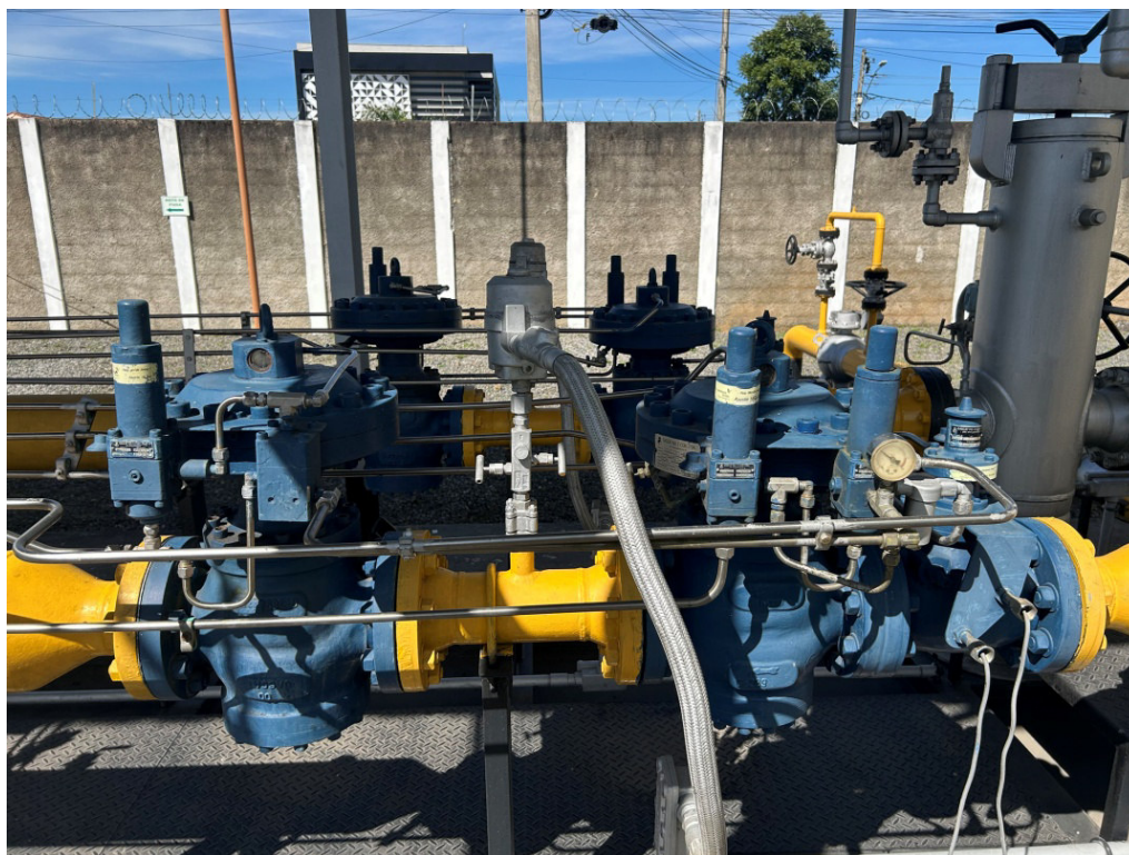
Foto 7: Reguladores de pressão.
