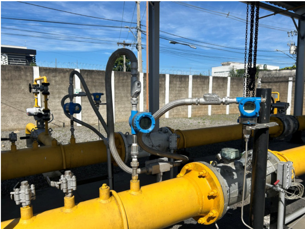
Foto 6: Medidores de pressão.
