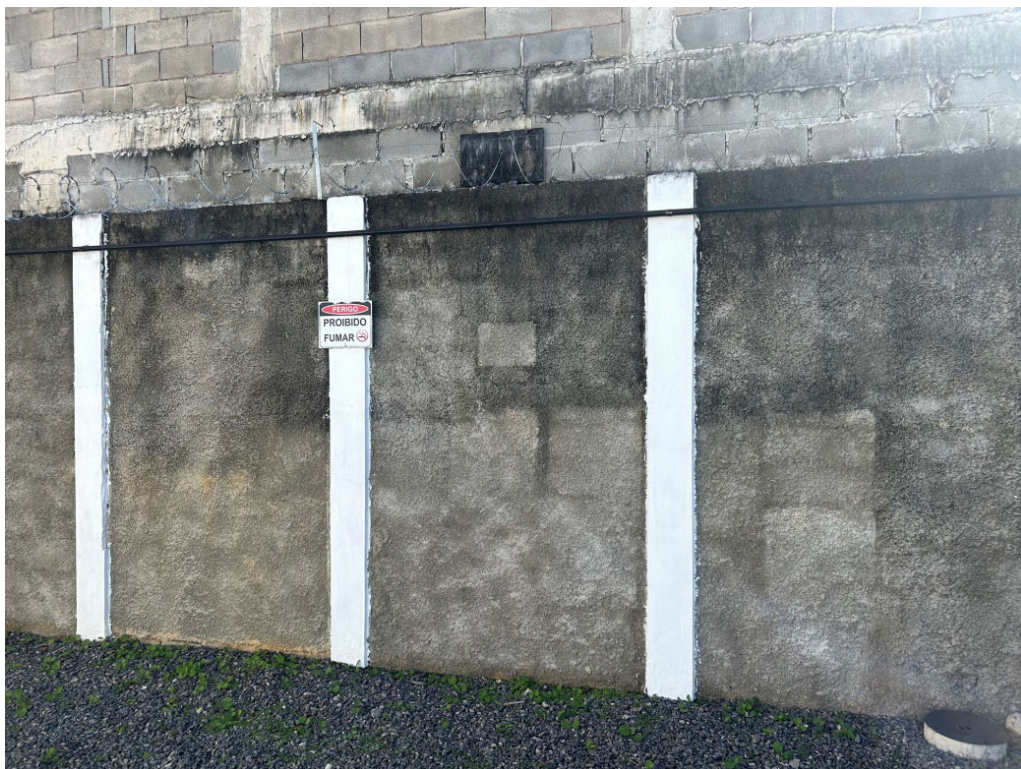
Foto 10: Local onde placa de rota de fuga estava ausente.
