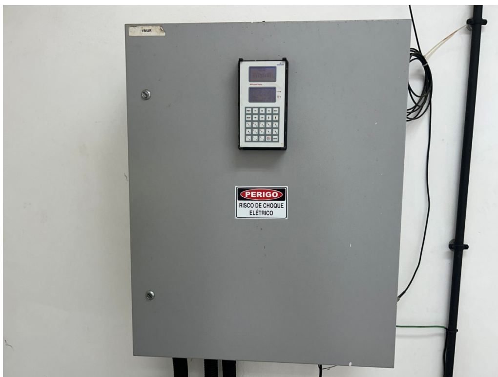
Foto 6: Paineil de telemetria.
