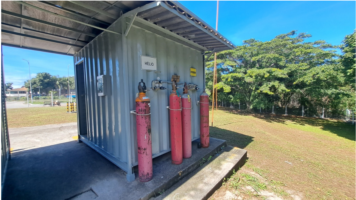
Foto 13: Central de Gas de Arraste
