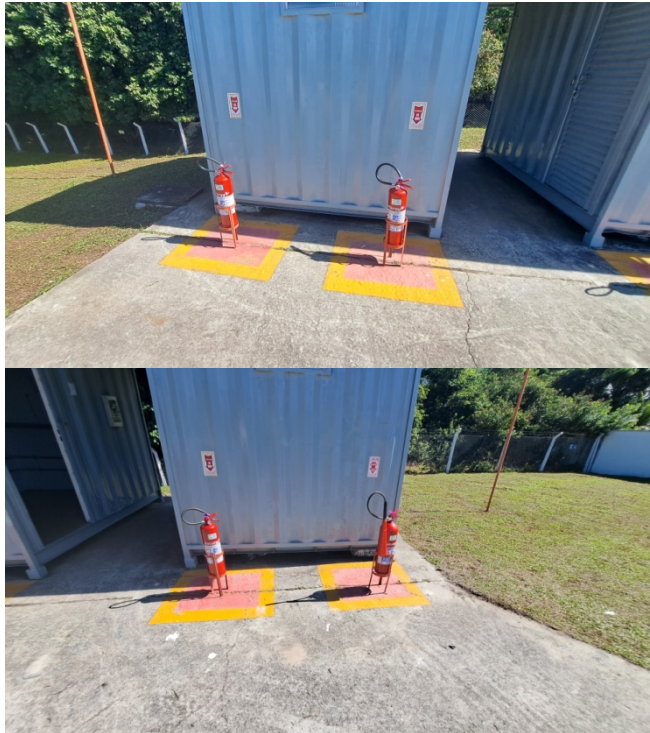
Foto 11: Extintores 1, 2 e 3 de póquímico e 1 de CO2
