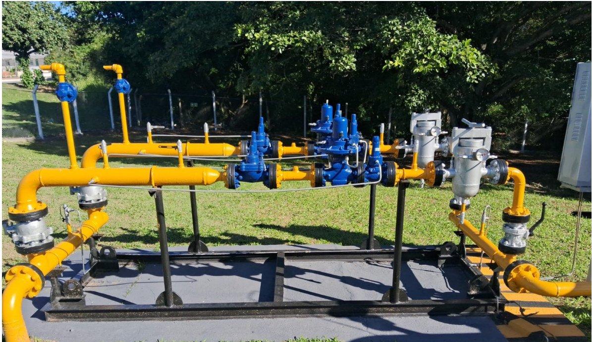
Foto 5: Área de Regulação de Pressão para saída Rio das Ostras - saída 4 bar
