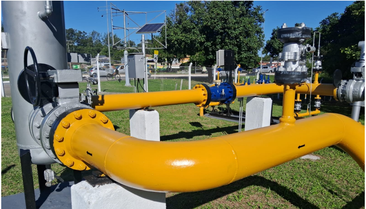
Foto 7: Tubulação com seta indicativas do sentido do fluxo de gás.
