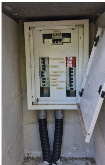
Foto 6: Porta do quadro elétrico com avaria.
