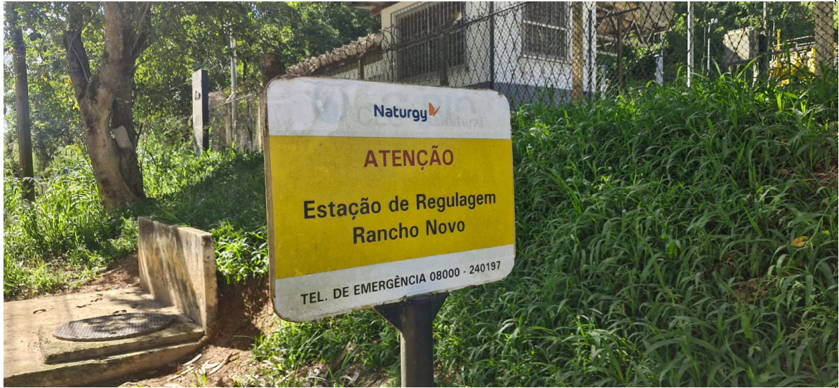
Foto 1: Placa de Identificação da Estação de Regulagem.
