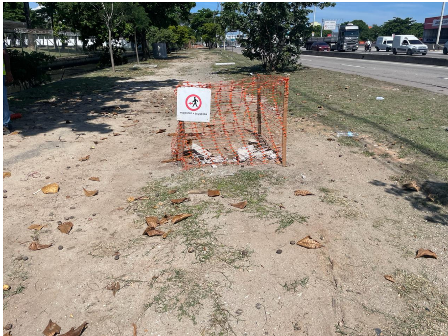
Foto 9: ponto sem recomposição sinalizado e enviado pelo gestor da obra.
