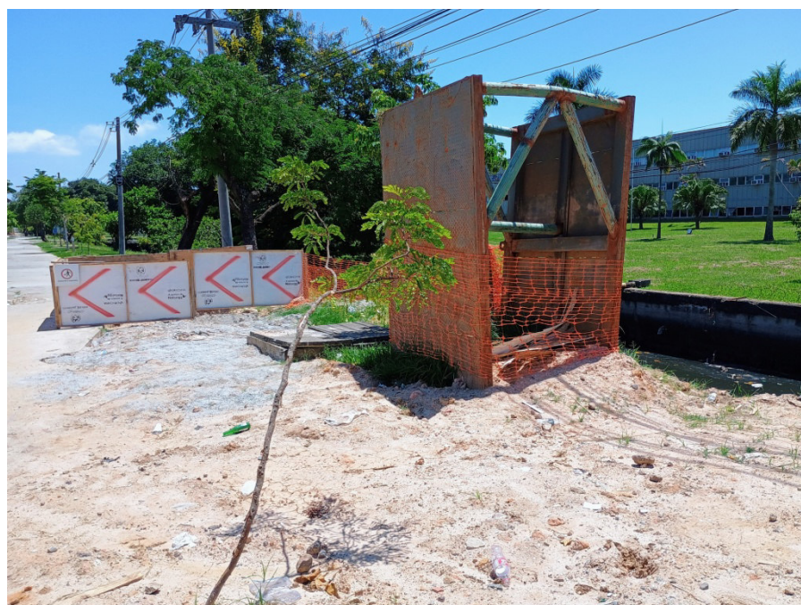
Foto 8: ponto sem recomposição e sem sinalização.
