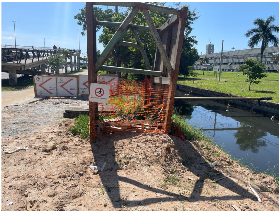
Foto 10: ponto sem recomposição sinalizado e enviado pelo gestor da obra.
