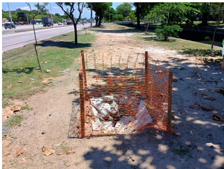
Foto 7: ponto sem recomposição e sem sinalização.
